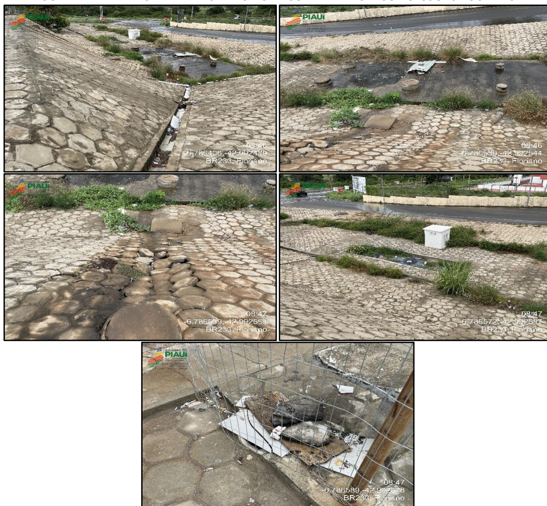
Quadro – Síntese dos Pontos Críticos Identificados na Visita Técnica
