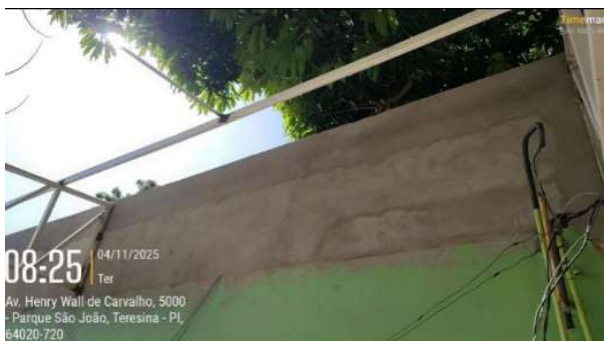
Figura 44: Reboco em platibanda da fachada norte do Anexo Administrativo
