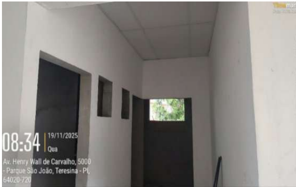
Figura 42: Pintura e lixamento sobre parede com a cor branca em diversos ambientes do Anexo Administrativo
