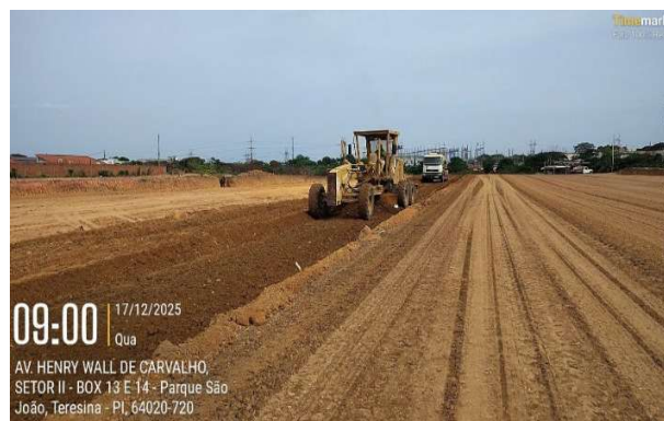
Figura 104: Regularização e nivelamento de via com motoniveladora, caminhão pipa e arado para trator
