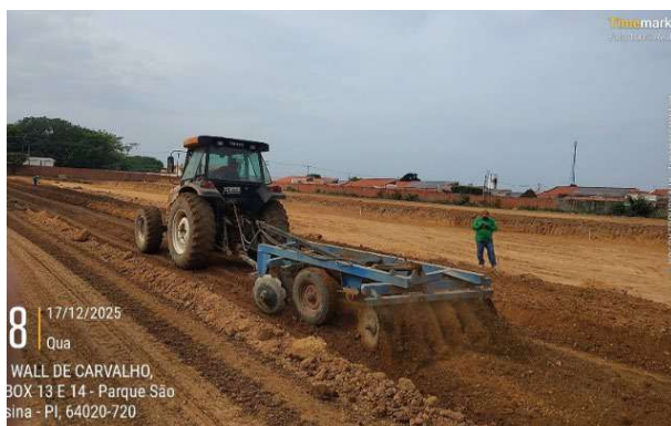
Figura 103: Regularização e nivelamento de via com motoniveladora, caminhão pipa e arado para trator
