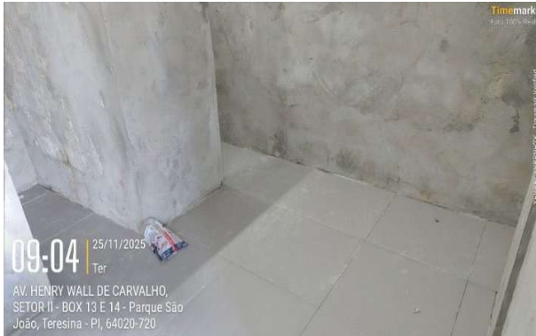
Figura 60: Reboco sobre parede em banheiro
