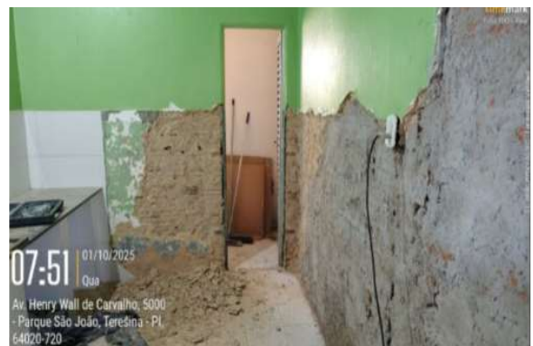
Figura 10: Quebra de revestimento cerâmico, reboco e parede, piso no Anexo Administrativo
