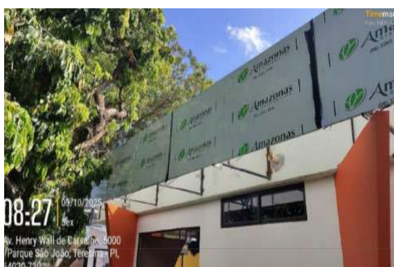
cor preta em platibanda da fachada oeste
