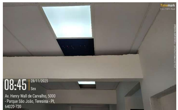
Figura 57: Instalação de painel de LED embutida(plafon) no Anexo Administrativo
