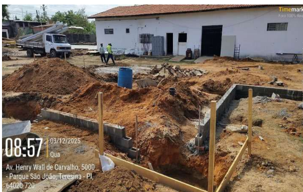
Figura 88: Assentamento de viga baldrame com bloco de concreto estrutural na expansão do almoxarifado
