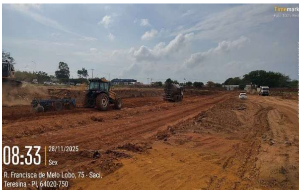
Figura 76: Aplicação de água, mistura e regularização do nível de sub-leito para execução de via e docas
