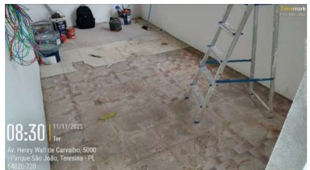
Figura 45: Quebra de piso antigo no Anexo Administrativo
