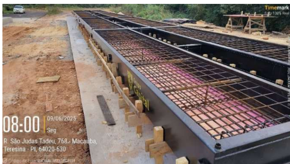
Figura 04: Execução de fôrmas em madeirite resinado para concretagem de módulos internos das balanças;
