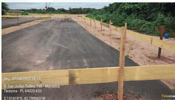
Figura 02: Execução do gabarito de obra na construção das balanças rodoviárias, localizadas próximo à rotatória na área de expansão;
