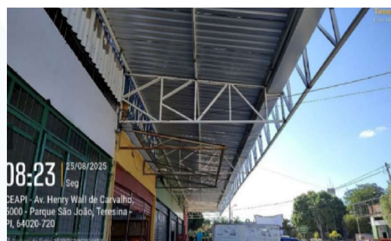
Figura 36: Instalação de calhas de zinco e chapas trapezoidais brancas no galpão GP12-AMA.
