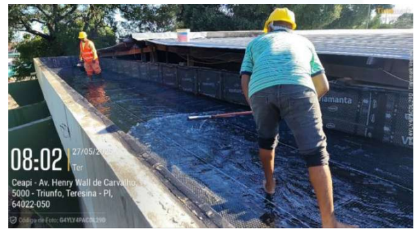
Figura 19: Instalação de manta impermeabilizante e argamassa polimérica em laje, teste de vazamento e furo na platibanda para inserção de tubo para drenagem pluvial;
