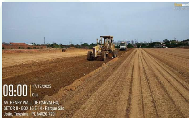
Figura 71: Regularização e nivelamento de via com motoniveladora, caminhão pipa e arado para trator.
