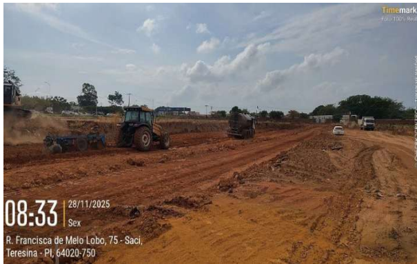
Figura 69: Aplicação de água, mistura e regularização do nível de sub-leito para execução de via e docas.
