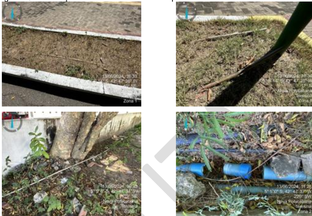
Figura 48 - Tubulação hidráulica subterrânea exposta.
