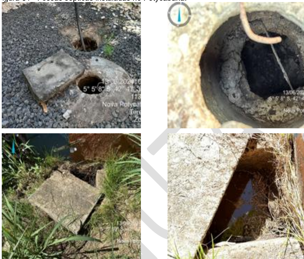
Figura 61 - Fossas sépticas instaladas no Potycabana.
