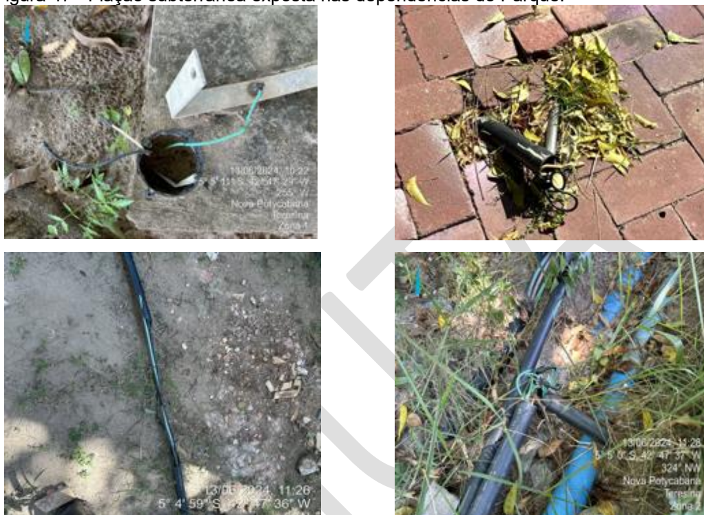
Figura 47 - Fiação subterrânea exposta nas dependências do Parque.
