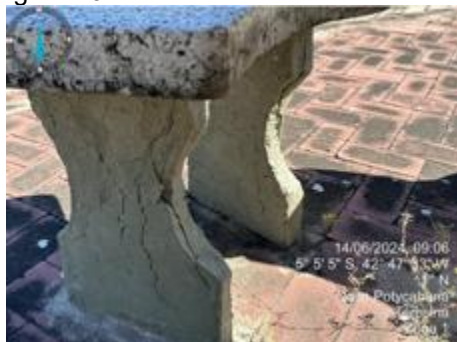
Figura 40 - Bancos e mesas de concreto com rachaduras.
