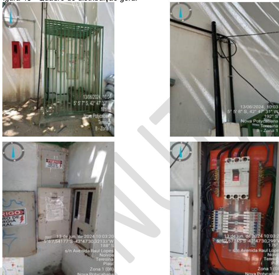
Figura 45 - Quadro de distribuição geral
