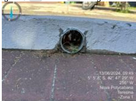
Figura 52 - Canais de drenagem obstruídos
