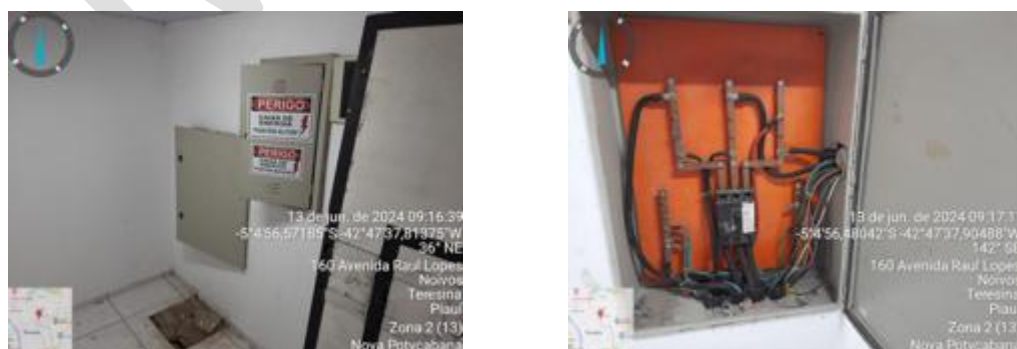
Figura 46 - Quadro de distribuição do palco principal
