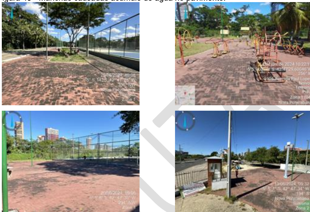
Figura 49 - Manchas causadas acúmulo de água no pavimento.
