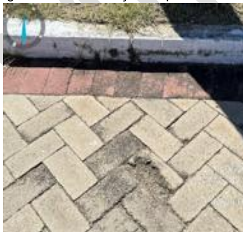
Figura 38 - Deterioração no pavimento da pista de cooper
