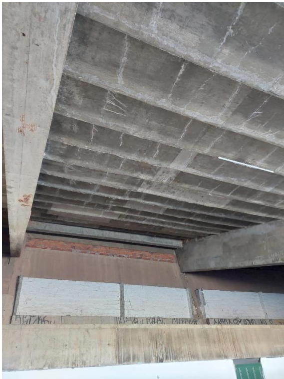
Figura 21 – Calcificação na face inferior da arquibancada
