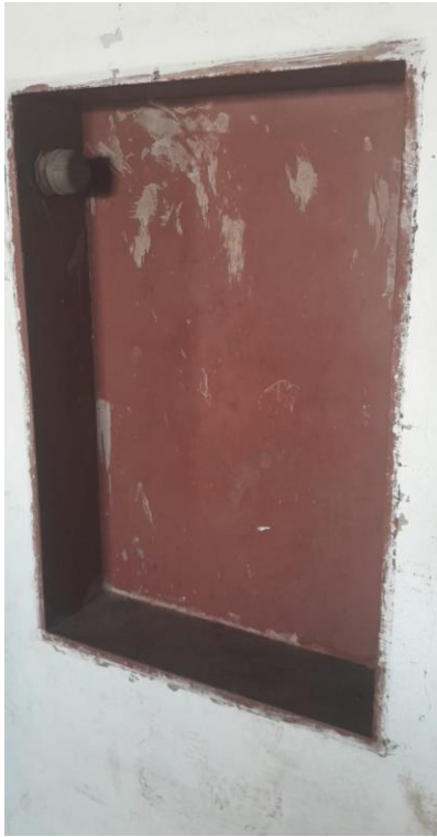
Figura 36 – Caixa de hidrante com componentes faltando
