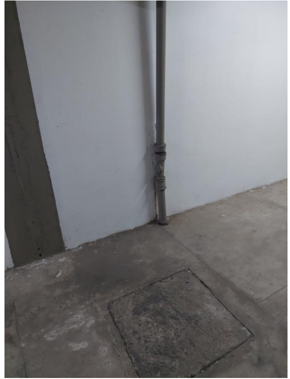
Figura 34 – Caixa de passagem de esgoto
