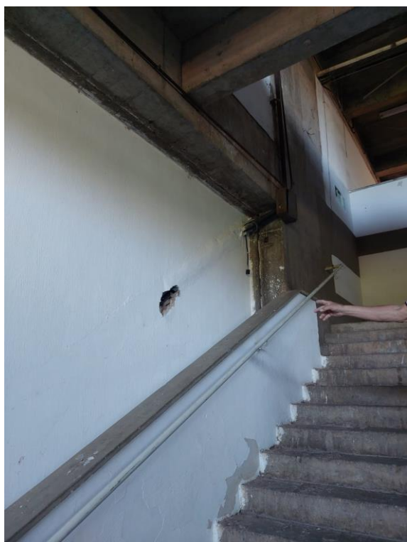
Figura 25 – Instalação elétrica com cabos retirados
