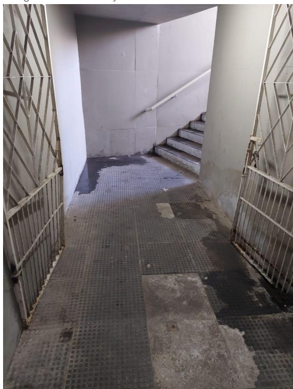
Figura 26 – Túnel de acesso ao campo sem existência de drenagem de água pluvial
