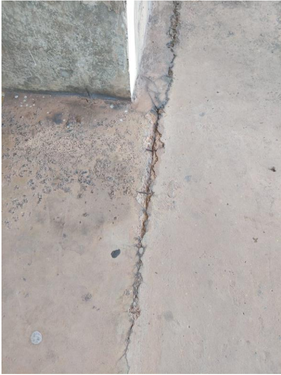
Figura 32 – Armadura aparente e oxidada na laje
