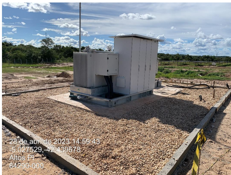
Figura 11 – Skid de transformação em operação.
