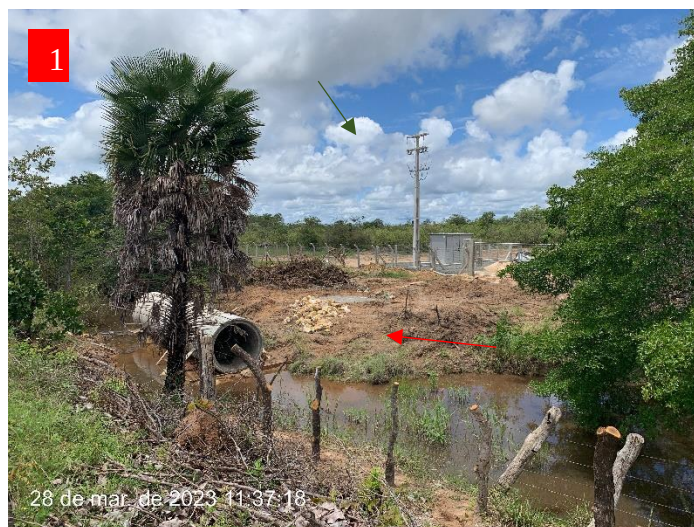
Figura 19 - Na entrada da usina há um corredor de água oriundo de um riacho. A imagem 1 é datada no mês de março de 2023, a imagem 2 é datada em abril de 2023. É possível observar que no intervalo de tempo entre as duas visitas, a concessionária executou a linha de conexão (seta verde), e finalizou a passagem de acesso (seta vermelha).
