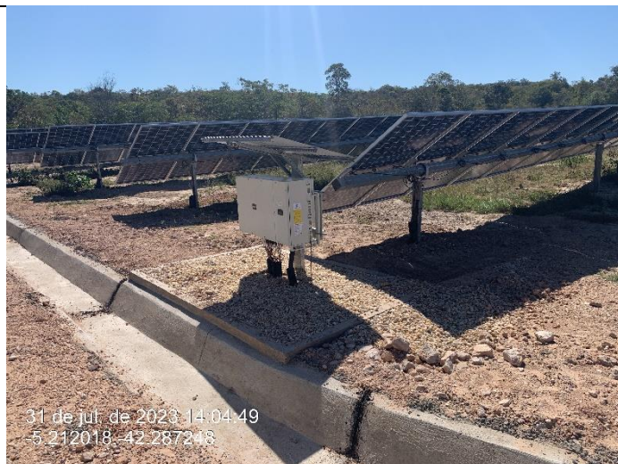
RF03_7: Inversor com estrutura de proteção contra sol e chuva.
