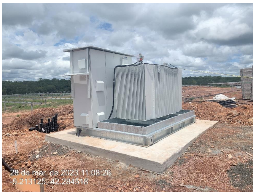
Figura 17 - Skid de transformação fixado, usando transformador a seco.
