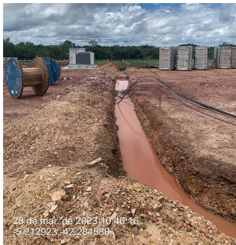
Figura 21 - Vala de passagem para cabeamento. Devido as chuvas dos dias 26 e 27 de março, as valas estavam alagadas.
