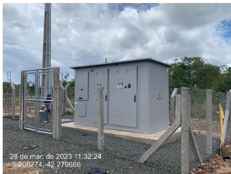
Figura 5 - Cabine Primária de Transformação concluída.
