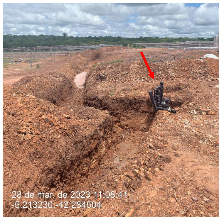
Figura 16 - Valas de conexão CC e eletrodutos para passagem do cabeamento CC ao skid (seta vermelha).
