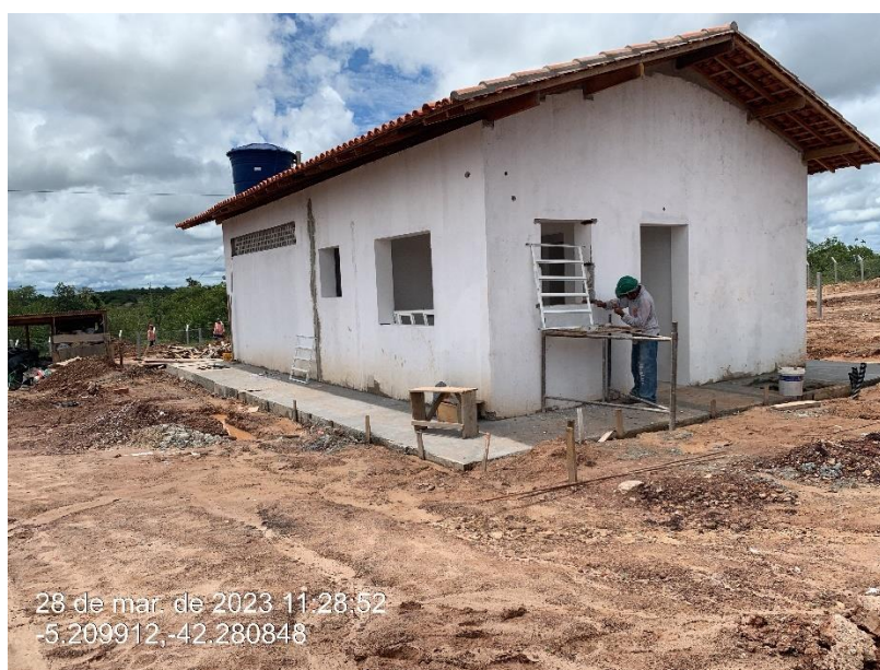
Figura 10 - Edificação de O&M e controle, que será usado pelas usinas GD Altos (Contrato 03/2020) e pela GD Longá (Contrato 04/2020). Ambas as usinas estão no mesmo perímetro patrimonial.
