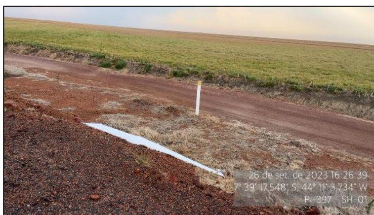
Figura 66 - Delimitador da faixa de domínio implantado - SH-01
