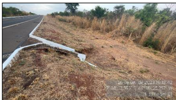
Figura 50 – Bueiro limpo implantado no km 5 – SH-01
