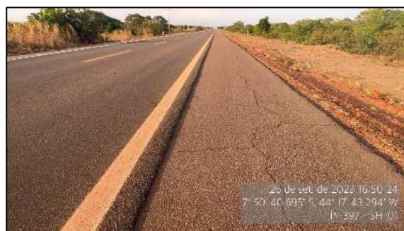
Figura 41 - Trinca FC-3 no acostamento - SH-01
