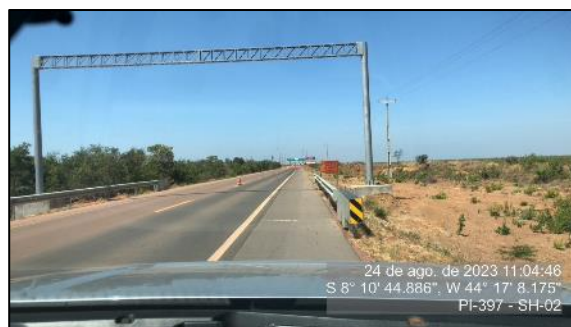
Figura 74 – Ausência de sinalização aérea no pórtico galibo da P2 - SH-02 – ago/23
