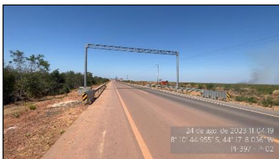
Figura 77 – Ausência de marcação de fila de 600 m da P2 - SH-02 – ago/23
