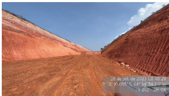
Figura 137 – Talude sem proteção contra chuva – SH-08
