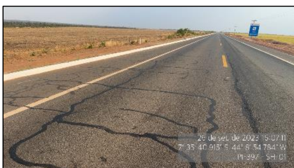
Figura 38 - Selagem de trincas - SH-01
