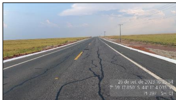
Figura 37 - Selagem de trincas – SH-01
