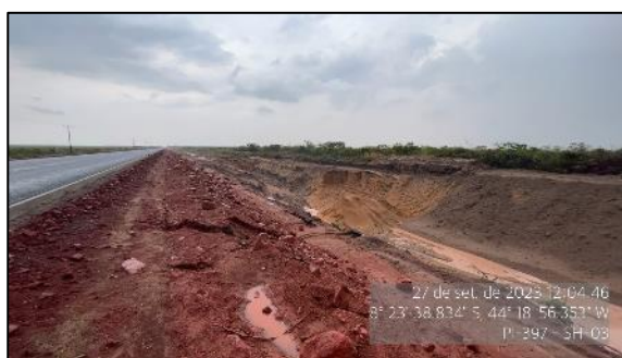
Figura 95 – Ponto com ausência de proteção lateral – SH-03
