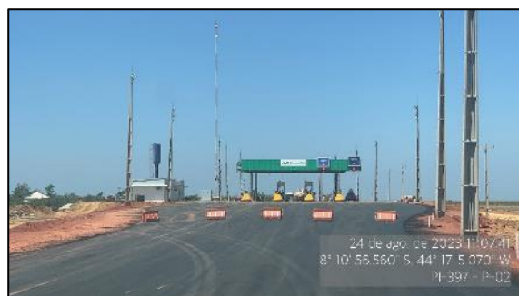
Figura 78 – Ausência da sinalização das pistas de cobrança da P2 - SH-02 – ago/23
