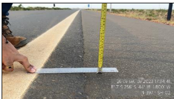
Figura 64 - Medição do degrau do acostamento - SH-01
