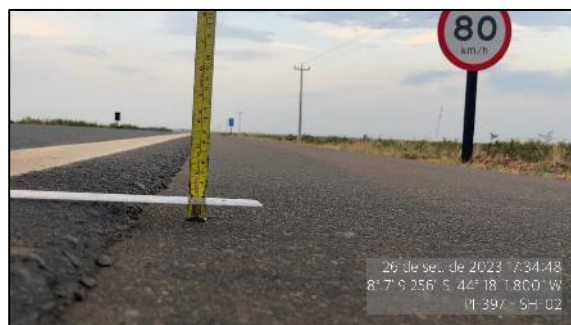
Figura 65 - Medição do degrau do acostamento - SH-01
