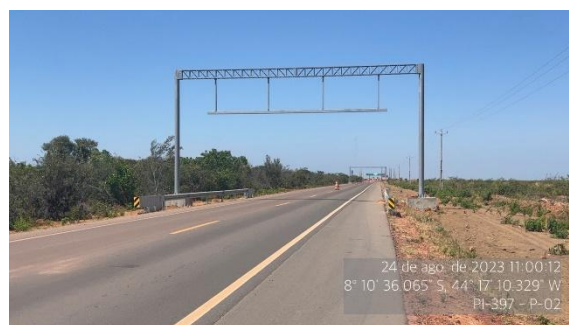
Figura 6 - Ausência de marcação zebrada no detector de altura - agosto/23
