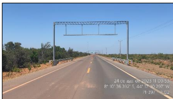
Figura 73 – Ausência de zebração no detector de altura da P2 - SH-02 – ago/23
