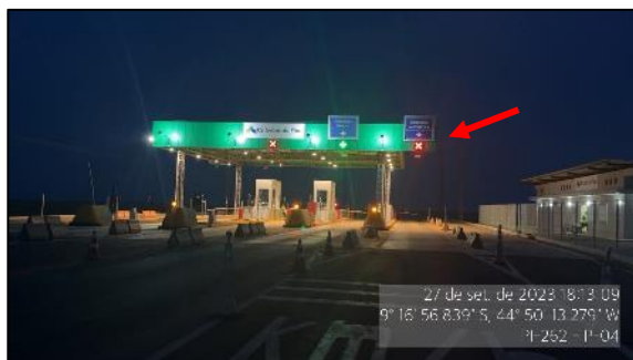
Figura 165 – Pista automática inoperante – P4
