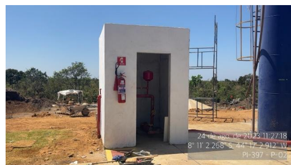
Figura 12 – Casa de bomba sem vedação - agosto/23
