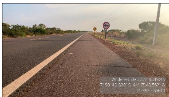
Figura 40 - Trinca FC-3 no acostamento - SH-01
