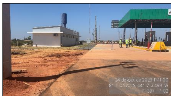
Figura 76 – Edificação de apoio da P2 sem cercado - SH-02 – ago/23
