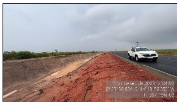
Figura 96 – Ponto com ausência de proteção lateral – SH-03
