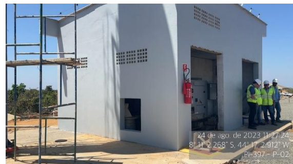
Figura 10 - Esquadrias não implantadas na sala do gerador - agosto/23
