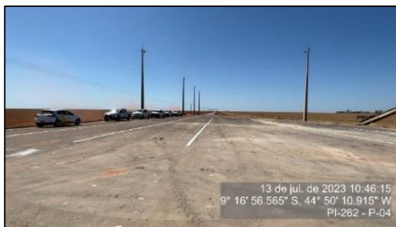
Figura 121 – Sinalização horizontal ausente – P4
