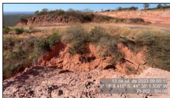
Figura 146 – Processo erosivo na rodovia existente
