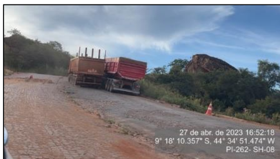
Figura 150 – Interrupção de Tráfego devido à deterioração do pavimento – Serra do Quilombo
