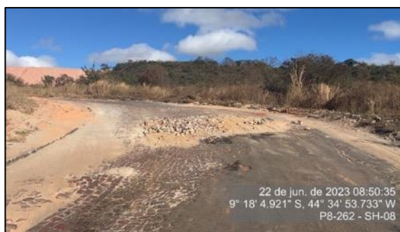
Figura 141 – Pavimento deteriorado na descida da Serra do Quilombo – SH-08
