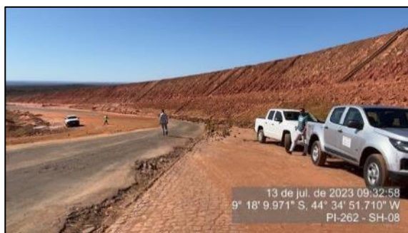
Figura 138 – Taludes de aterro sem revestimento vegetal
