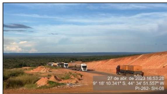
Figura 151 – Interrupção de Tráfego devido à deterioração do pavimento – Serra do Quilombo
