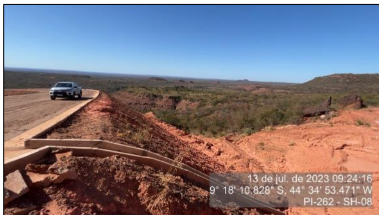
Figura 135 – Descida d'água com dispositivo de dissipação ausente
