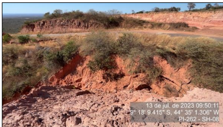
Figura 149 - Processo erosivo no talude do trecho em uso da PI-262 (Serra do Quilombo)
