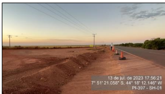
Figura 180 - Ponto de fuga fechado - km 38,80 - SH-01
