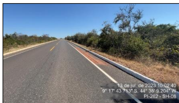
Figura 101 – Buraco no acostamento - SH-08
