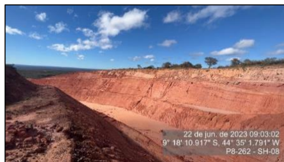
Figura 139 – Taludes de corte sem revestimento vegetal
