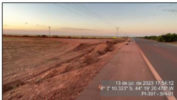
Figura 178 – Ponto de fuga fechado - km 38,80 - SH-01
