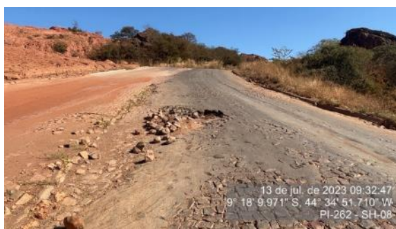
Figura 140 – Pavimento deteriorado na descida da Serra do Quilombo – SH-08
