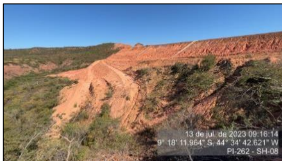
Figura 134 – Bermas sem dispositivos de drenagem implantados
