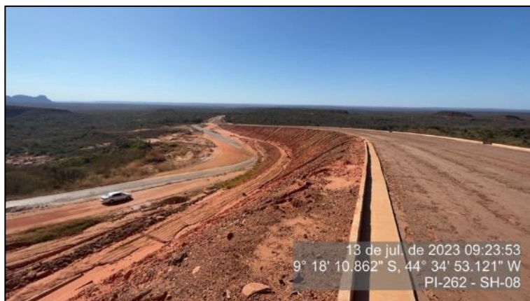
Figura 147 - Acúmulo de material proveniente dos taludes na pista
