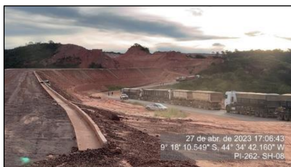
Figura 142 – Interrupção de Tráfego devido à deterioração do pavimento – Serra do Quilombo
