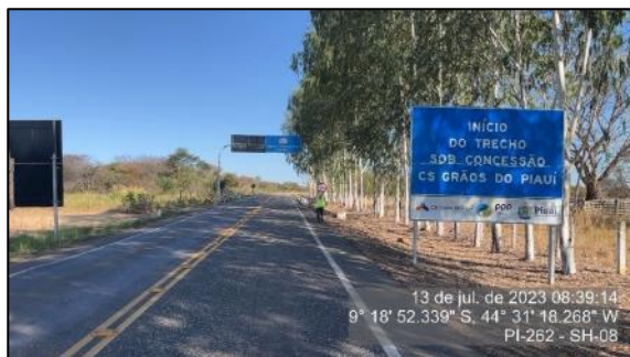
Figura 108 - Placa em bom estado - SH-08
