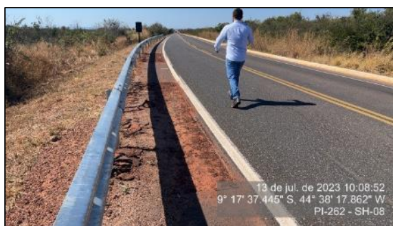
Figura 100 – Buraco no acostamento - SH-08
