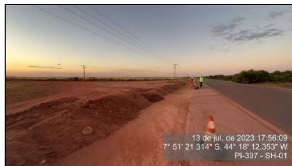
Figura 179 - Ponto de fuga fechado - km 38,80 - SH-01
