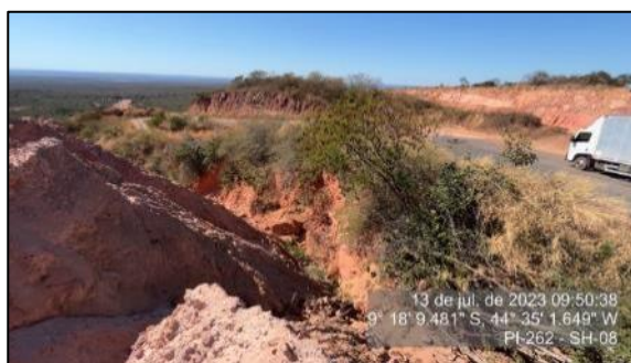
Figura 145 – Processo erosivo nos taludes do bota-fora e da rodovia existente
