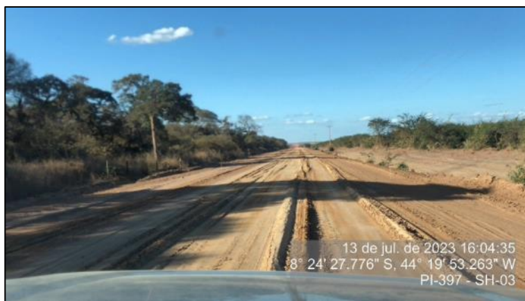
Figura 77 - Local atacado pela terraplenagem - SH-03
