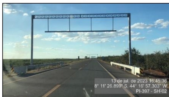
Figura 74 - Defesa lateral no pórtico da P2 - SH-02
