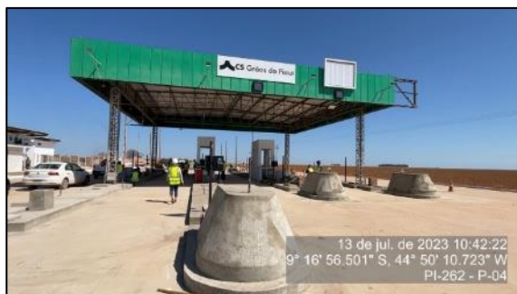
Figura 120 – Ausência de cancelas – P4
