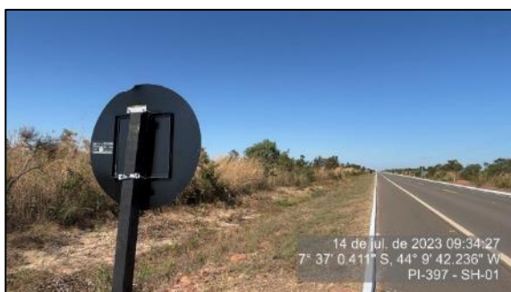
Figura 37 – Placa danificada – km 7,9 – SH-01
