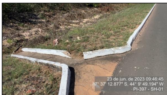
Figura 48 - Descida d'água danificada no km 8,3 – jun/23 - SH-01
