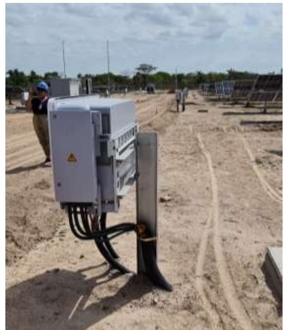
Foto 04 - Disposição de Inversores
