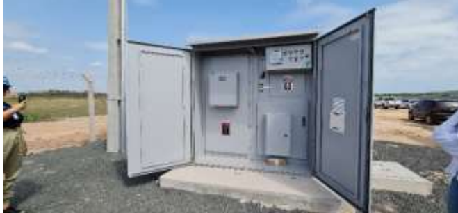
Foto 1 - Vista do Cubículo de Medição, Proteção
