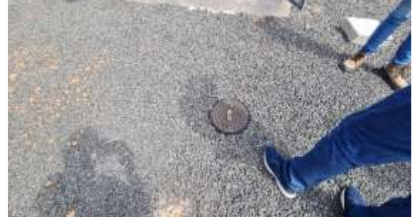
Foto 02 - Evidência do aterramento da SE
