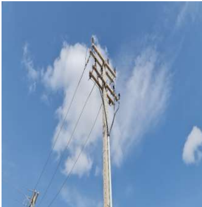
Foto 03 - Vistas do Ramal de Ligação em 13.8 kv
