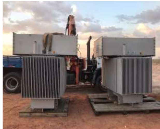
Registro da entrega dos transformadores.
