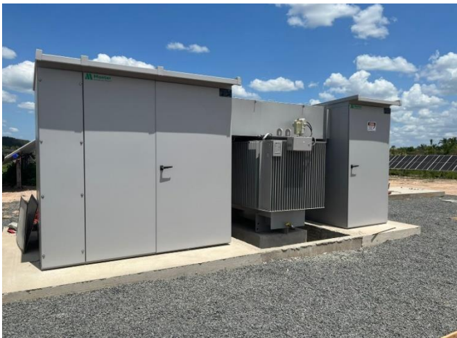
Registro da Cabine e Transformador.
