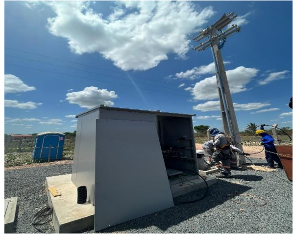
Registro da Cabine de Entrada.
