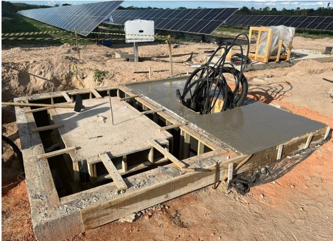
Registro da Base da Cabine e Base do Transformador.
