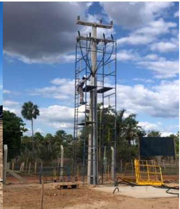
Registro do Poste de Entrada.
