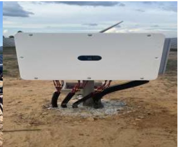
Registro dos Inversores.
