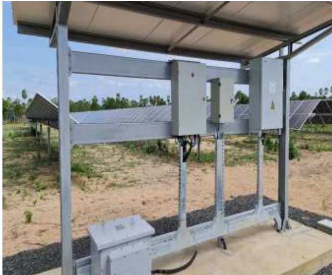
Foto 11 - Painéis de Monitoramento Usina
