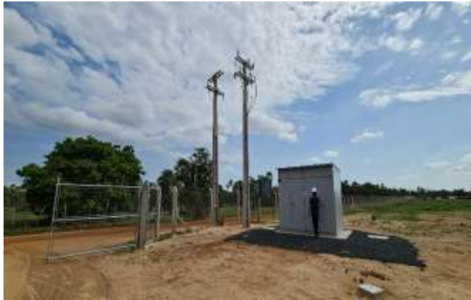
Foto 1 - Vista do Cubículo de Medição, Proteção e Ramal de Entrada
