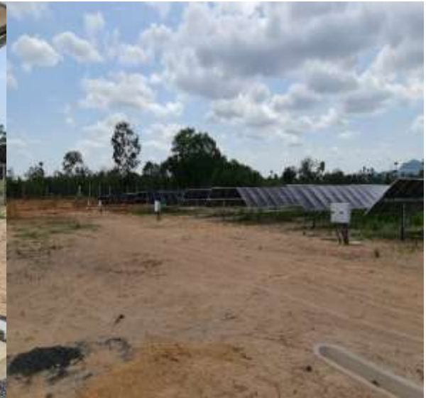
Foto 12 - Disposição de Placas e Inversores
