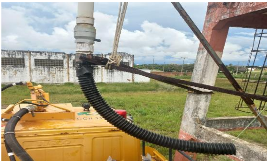
Figura 22. tubulação de saída de água do reservatório de reabastecimento por gravidade do CCI;
