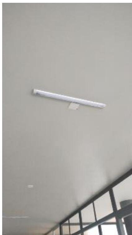
Figura 11. Nova iluminação no TPS
