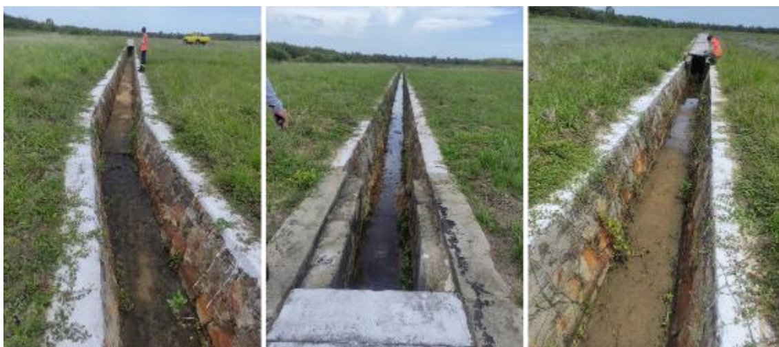
Figura 74. Registros fotográficos de inspeção realizada no dia 01/03/2023, na cabeceira 10
