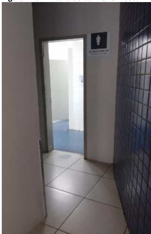
Figura 113. Pintura do banheiro masculino
