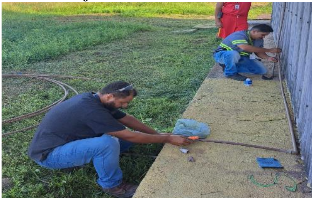
Figura 21. Nova rede de fornecimento – SCI
