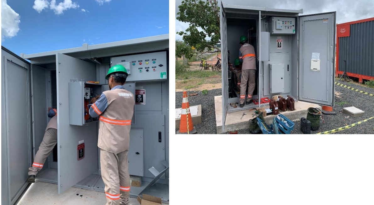
Foto 1 – Vistoria e Instalação dos Equipamentos de Medição
