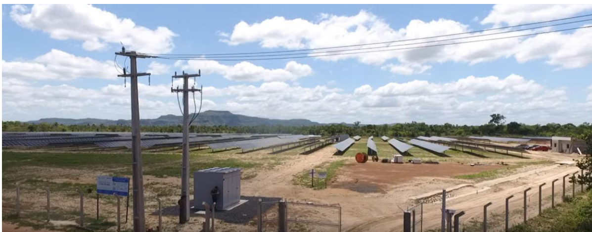
Foto 6 – Vista incluindo o prédio de O&M
