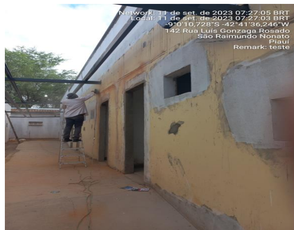
11/09/2023 – Execução de circuitos de iluminação do hall de circulação A e B;
