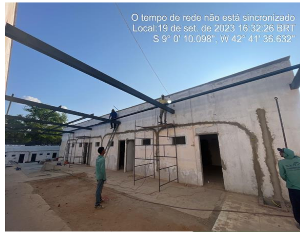
19/09/2023 – Execução de estrutura metálica para cobertura dos halls de circulação C e D;
