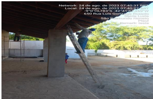
24/08/2023 – Execução de emassamento da superfície das paredes da recepção e estrutura de madeira;
