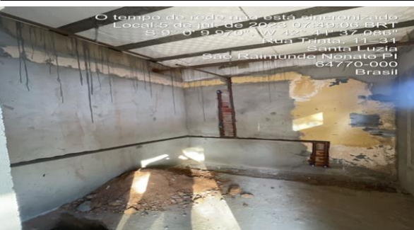
05/07/2023 – execução de serviço de água fria dos banheiros da área de lazer;
