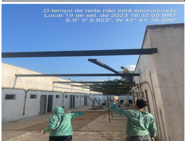
19/09/2023 – Execução de estrutura metálica para cobertura dos halls de circulação C e D;
