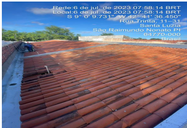
06/07/2023 - execução da plataforma metálica que acomodará todas as condensadoras dos apartamentos da ALA C;
