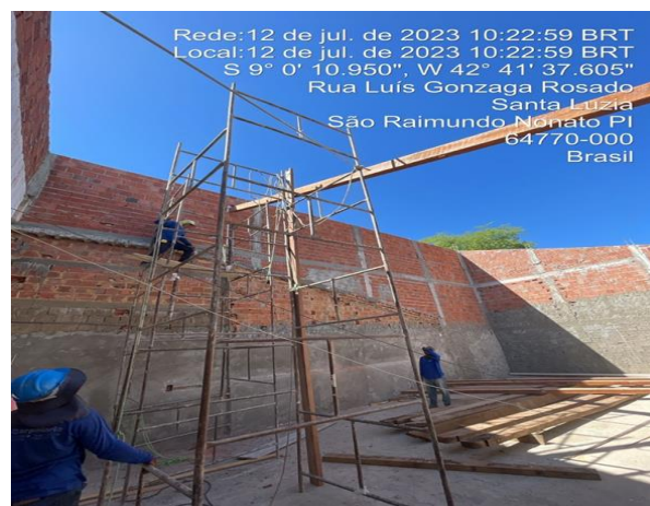
12/07/2023 - Execução de estrutura de madeira no auditório, como ilustrado na foto as vigas de madeiras;
