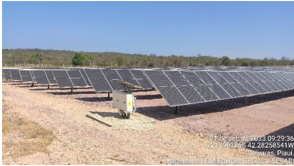
Figura 9 – Aterramento desconectado da estrutura.
