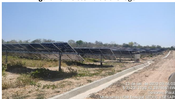
Figura 17 – Sistema de drenagem.
