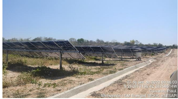
Figura 8 – Via de acesso aos inversores.
