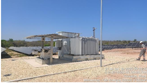
Figura 7 – Corredores de strings e inversor.
