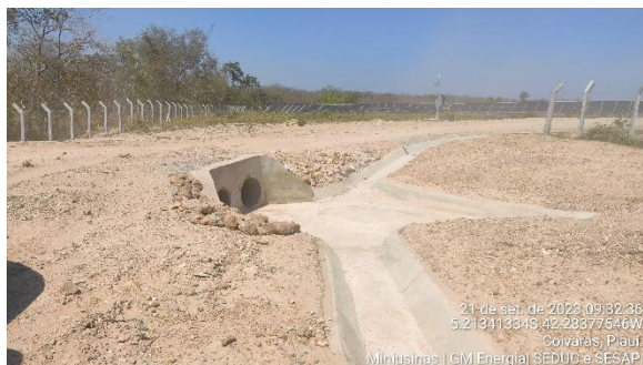
Figura 15 – Sistema de drenagem.
