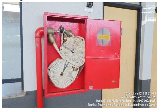
Figura 31 - Sistema de combate a incêndio
