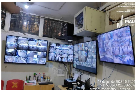
Figura 96 - Sala de monitoramento
