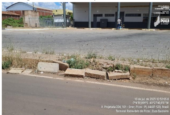
Figura 71 - Avarias do pátio de manobra
