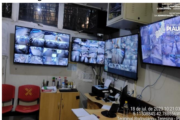
Figura 95 - Sala de monitoramento
