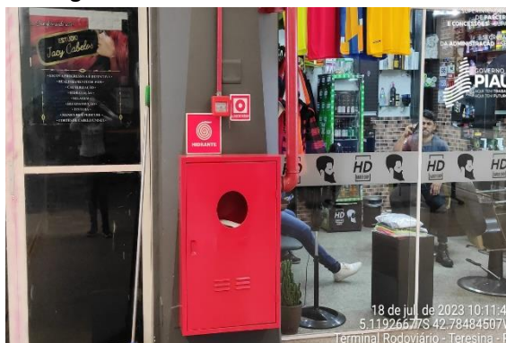
Figura 84 - Sistema de combate a incêndio
