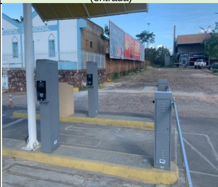
Figura 06: Cancelas de Estacionamento (entrada)
