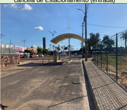
Figura 08: Estrutura de proteção para a cancela de Estacionamento (entrada)
