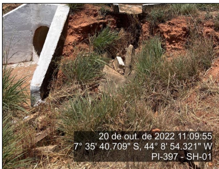
Figura 34 - Erosão pontual causando destruição da descida d'água (2) – SH-01
