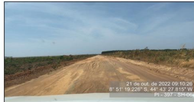
Ponto do trecho com material solto e vegetação alta no bordo.
