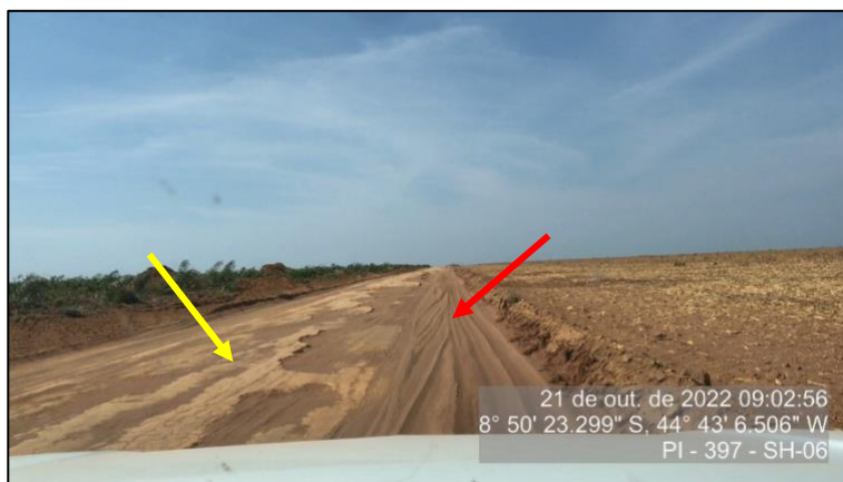
Figura 86 - Irregularidade da superfície do pavimento gerada pela compactação parcial do subleito - SH-06
