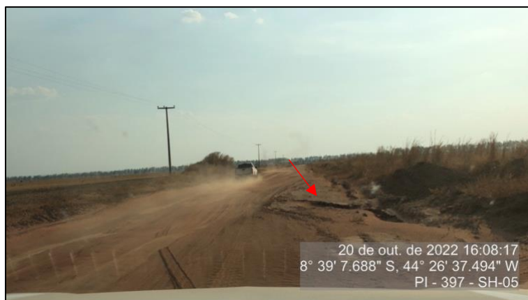
Figura 82 - Erosão causada pelo fluxo de águas pluviais – SH-05
