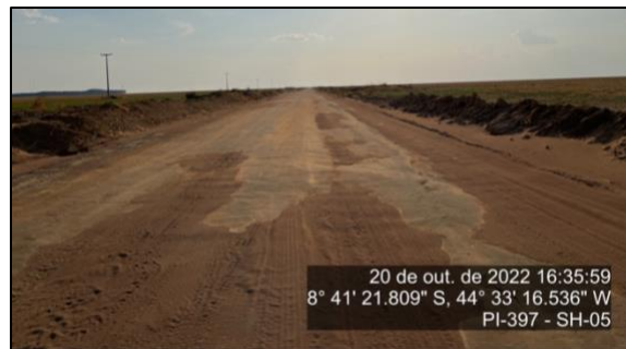
Figura 85 – Trecho sujeito a alagamento no mês de outubro/22 - SH-05
