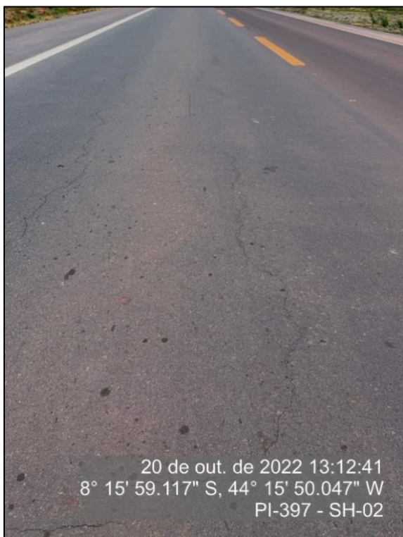
Figura 49 - Trinca no pavimento do rolamento - SH-02
