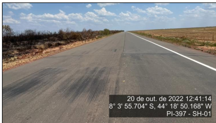
Figura 17 - Detalhe do desnível entre faixas contíguas – SH01
