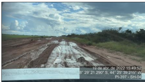
Figura 72 - Trecho alagado no mês de abril/22 - SH-04
