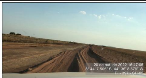
Trecho do segmento com material solto.
