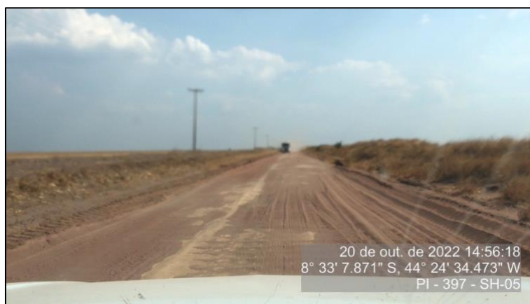
Figura 79 – Trecho com material solto – SH-05
