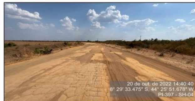
Segmento em leito natural com formação de batentes após compactação (material rígido à esquerda)
