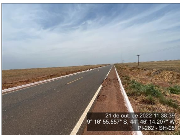
Figura 115 - Buraco no acostamento - SH-08 - 2
