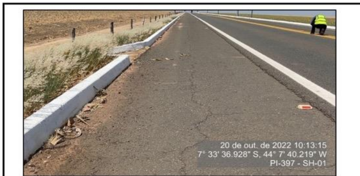
Trincas longitudinais e transversais no pavimento asfáltico do acostamento.
