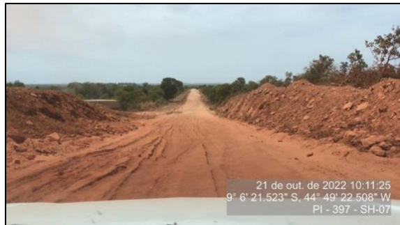
Figura 100 – Pista deteriorada – SH-07
