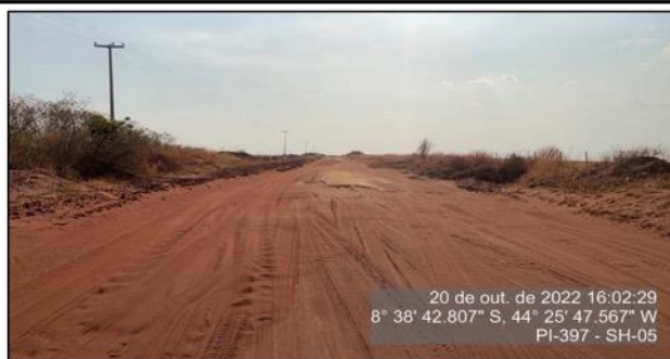
Trecho do segmento com material solto.
