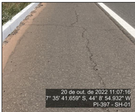
Figura 18 – Trincas longitudinais no acostamento – SH-01
