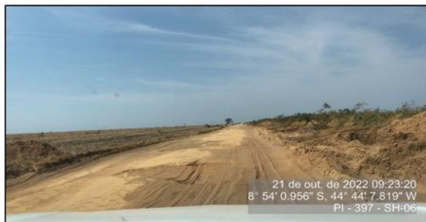
Ponto do trecho com material solto.
