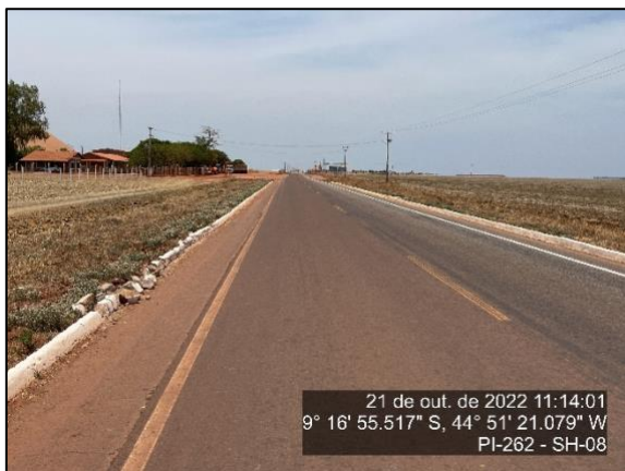
Figura 123 - Meio-fio danificado - SH-08
