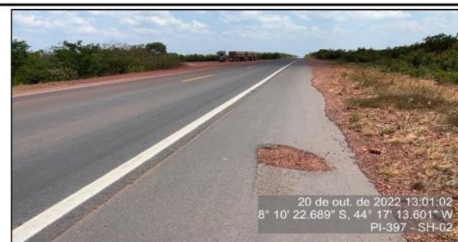
Buraco no acostamento - SH-02
