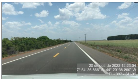
Figura 31 - Trecho sem dispositivos de drenagem – SH-01
