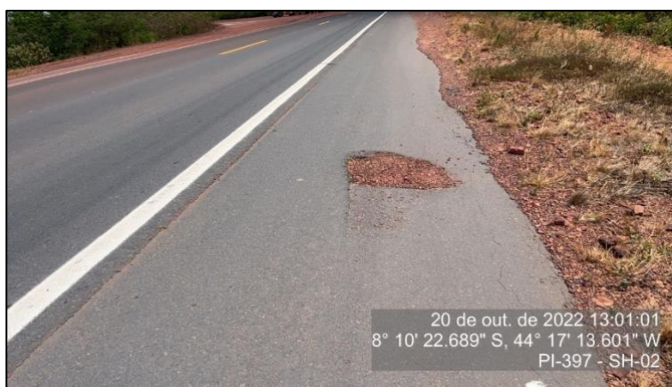
Figura 47 - Buraco no acostamento - SH-02
