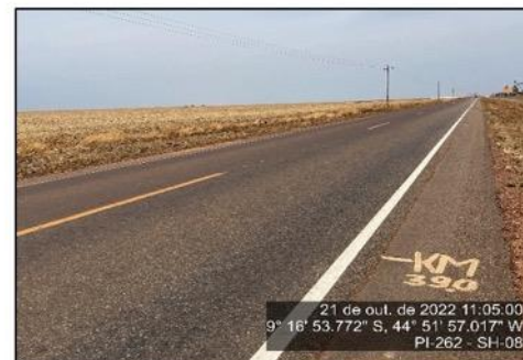
Ausência de marco quilométrico (requisito para entrega dos Trabalhos Iniciais)
