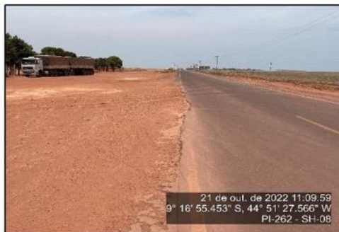
Zona com desgaste no pavimento asfáltico do acostamento da pista em local de acesso lateral irregular
