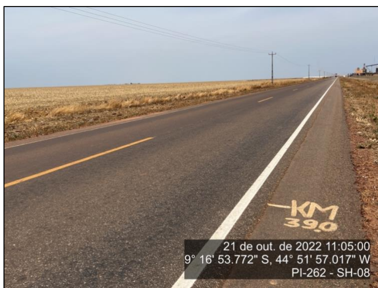
Figura 122 - Ausência de marco quilométrico – SH-08
