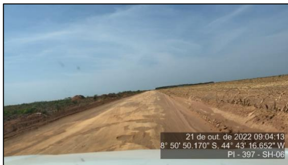
Figura 94 – Trecho sujeito a alagamento no mês de outubro/22 – SH-06
