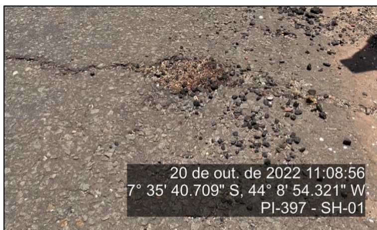
Figura 20 - Início da formação de buracos no acostamento - SH-01
