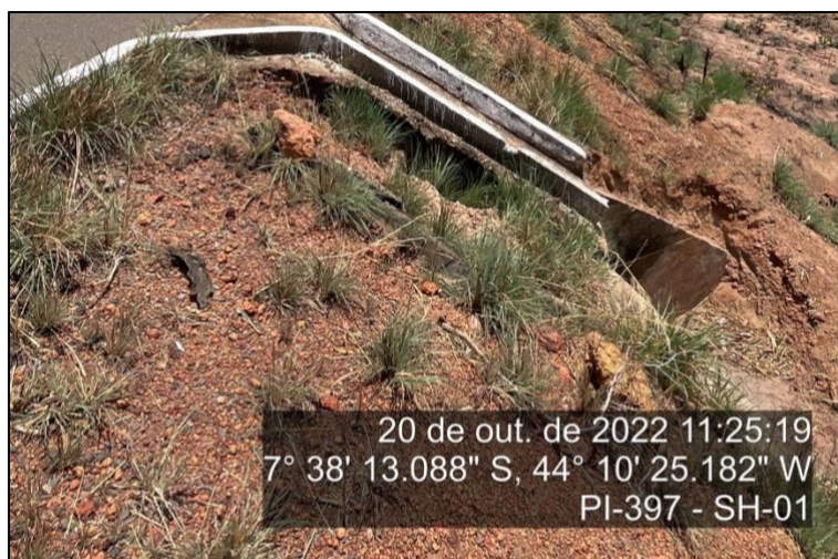
Figura 33 - Erosão pontual próximo à descida d'água (1) – SH-01
