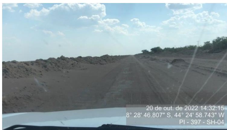
Figura 75 - Material depositado na pista - SH-04
