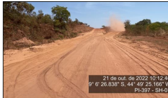
Figura 101 – Pista deteriorada – SH-07
