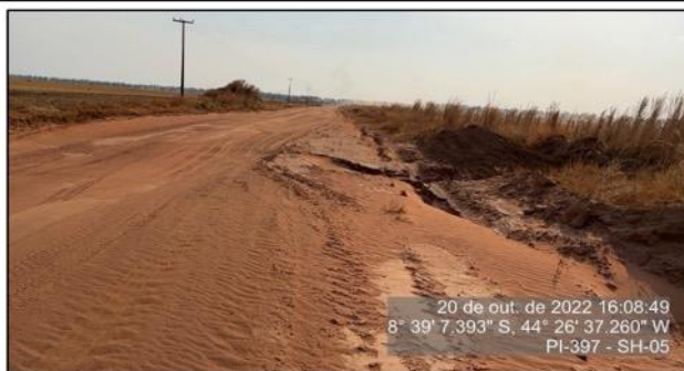
Erosão no meio da pista
