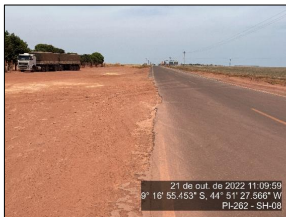
Figura 116 - Acesso irregular danificando acostamento e rolamento da pista - SH-08
