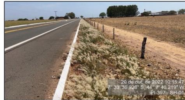
Cerca de propriedade privada aparentemente invadindo a faixa de domínio.
