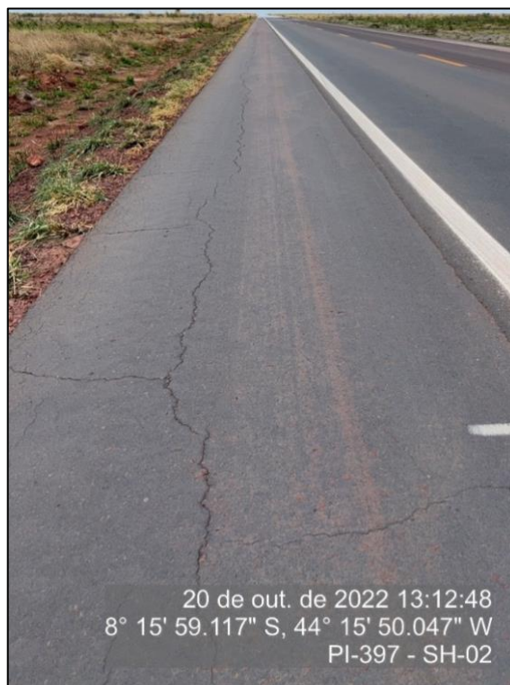
Figura 50 - Trinca no pavimento do acostamento - SH-02
