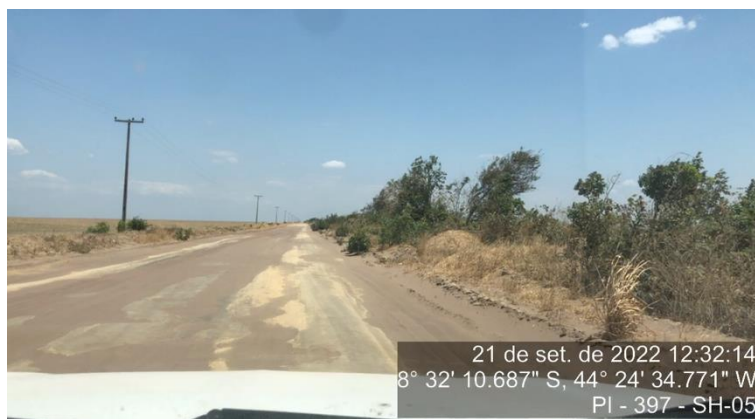
Figura 2 - Postes Existentes - SH-05
