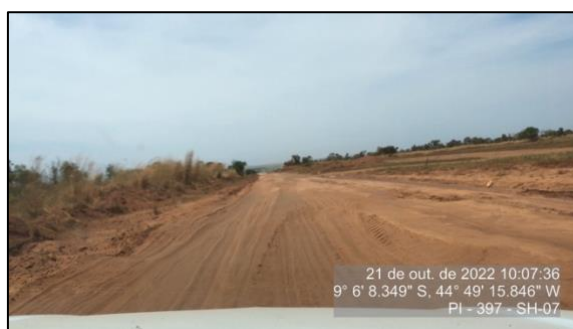
Figura 98 – Ponto com material solto – SH-07
