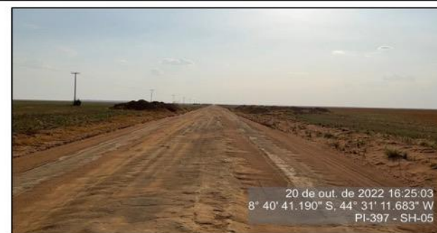
Trecho com irregularidades que provocam trepidação
