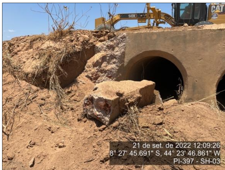
Figura 62 - Bueiro duplo do km 116,60 danificado e obstruído (set/22) - SH-03
