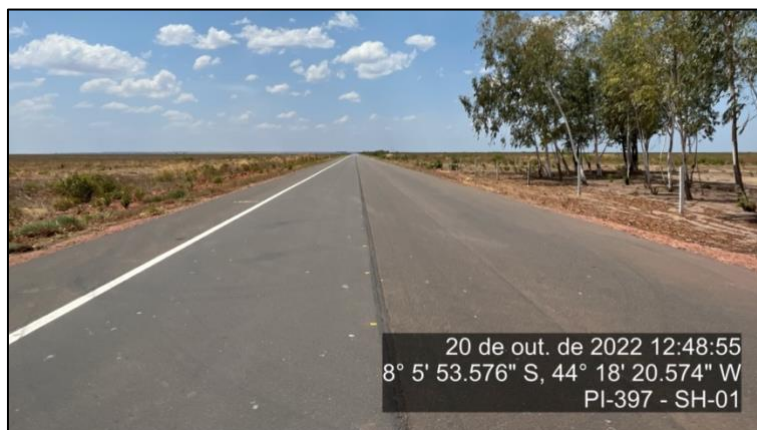
Figura 23 – Sinalização horizontal incompleta – SH1.
