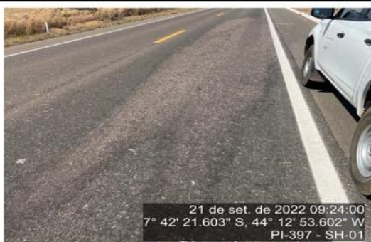
Zona com desgaste no pavimento.
