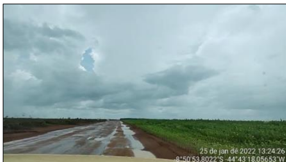
Figura 93 – Trecho alagado no mês de janeiro/22 – SH-06
