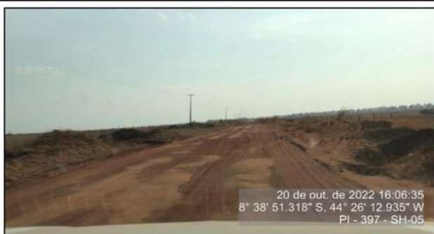
Trecho do segmento com material solto.
