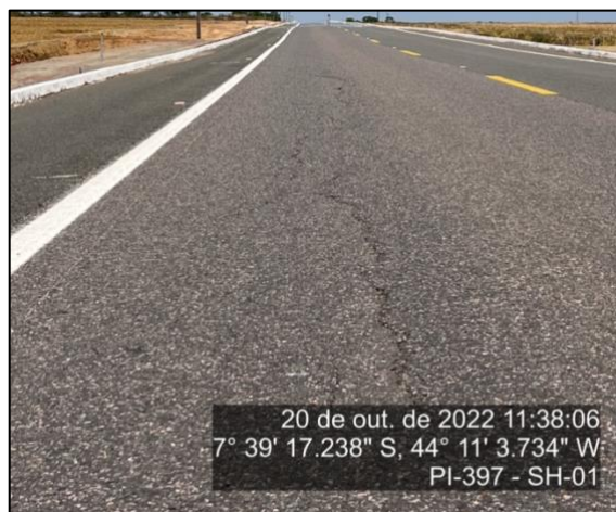
Figura 19 – Trincas longitudinais no pavimento – SH-01
