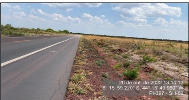
Trinca no acostamento e talude com cobertura vegetal - SH-02
