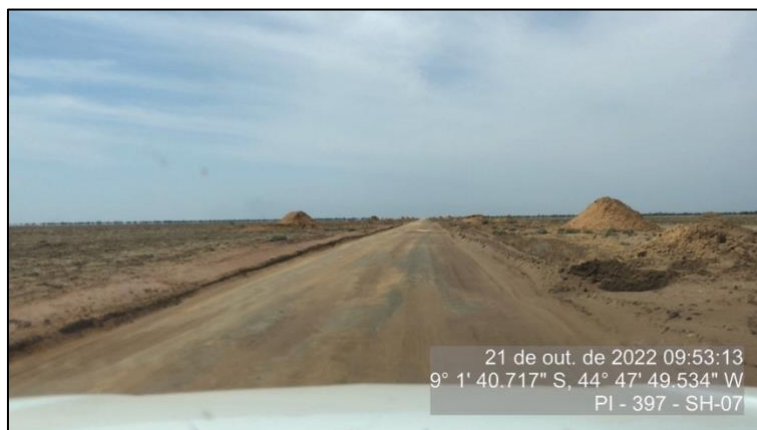
Figura 102 – Leito da pista com a elevação inferior aos bordos da rodovia - SH 07
