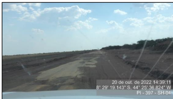
Figura 73 - Trecho sujeito a alagamento no mês de outubro/22 - SH-04
