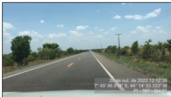
Figura 30 - Trecho sem dispositivos de drenagem – SH-01
