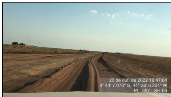
Figura 80 – Trecho com material solto - SH-05
