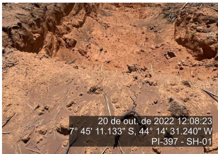
Figura 44 – Verticais e Subverticais no bordo da rodovia – SH-01
