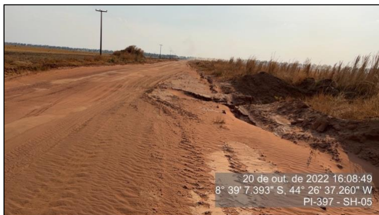
Figura 83 - Erosão causada pelo fluxo de águas pluviais – SH-05
