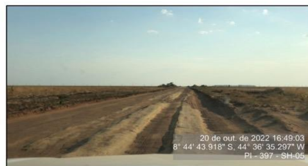
Material compactado formando batentes e irregularidades na superfície do subleito
