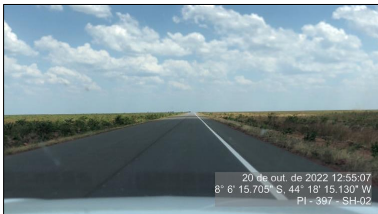
Figura 48 - Desnível entre faixas de rolamento - SH-02
