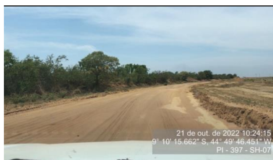
Figura 99 – Ponto com material solto – SH-07
