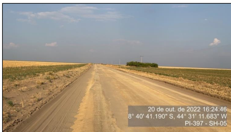
Figura 78 – Leito estradal após intervenção da Concessionária – SH-5
