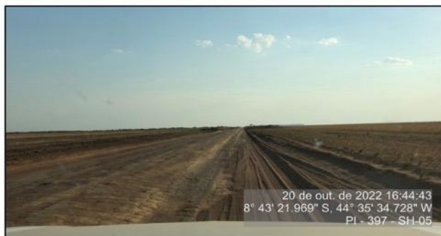
Trecho do segmento com material solto.
