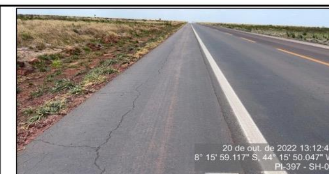
Trinca no acostamento - SH-02
