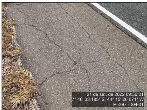
Figura 17 – Trincas longitudinais no acostamento – SH-01
