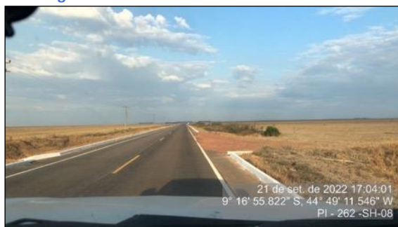
Figura 123 - Acesso irregular a direita da rodovia - SH-08-1
