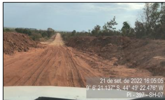
Figura 104 – Pista deteriorada – SH-07
