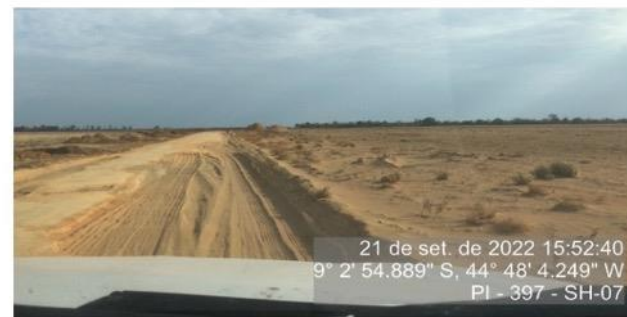
Trecho com material solto na pista.
