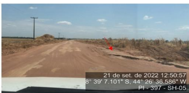
Erosão causada pelo fluxo de águas pluviais.
