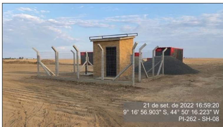
Figura 134 - Torre de comunicação da P4-SH-08
