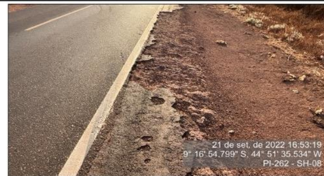
Revestimento do acostamento arrancado - SH-08
