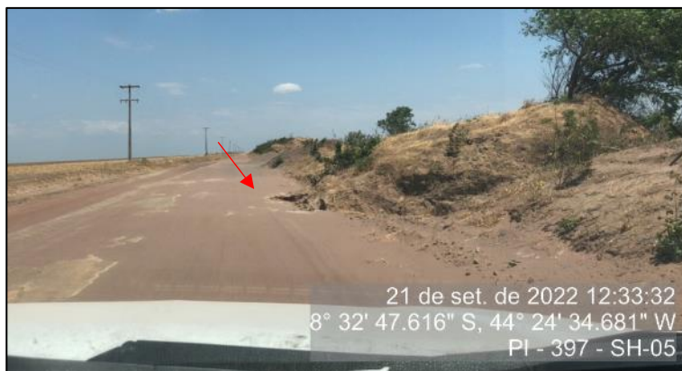
Figura 87 - Erosão causada pelo fluxo de águas pluviais – SH-05
