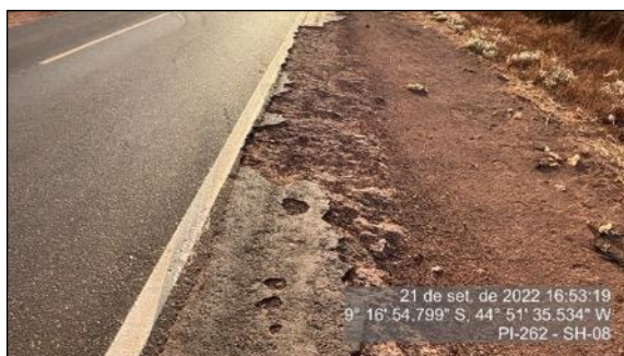
Figura 142 - Desprendimento do revestimento do pavimento - SH-08-1
