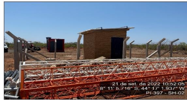
Material para torre de comunicação da P2
