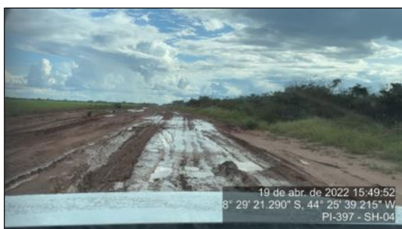
Figura 82 - Trecho alagado no mês de abril/22 - SH-04
