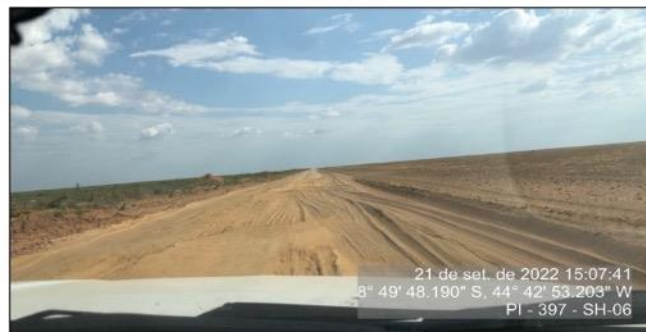
Ponto do trecho com material solto.
