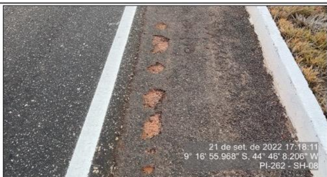
Buraco no acostamento do Segmento 08
