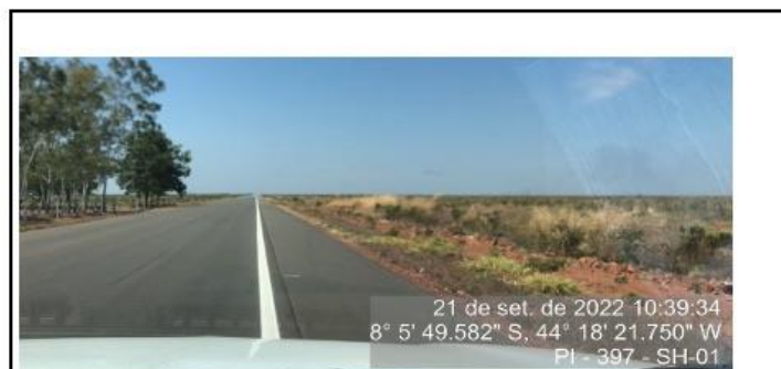
Final do segmento homogêneo 1 - Ainda necessitando de complementação na sinalização horizontal.
