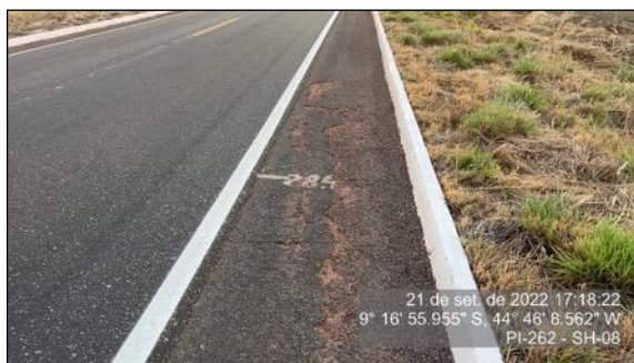
Figura 140 - Buraco em formação no acostamento - SH-08
