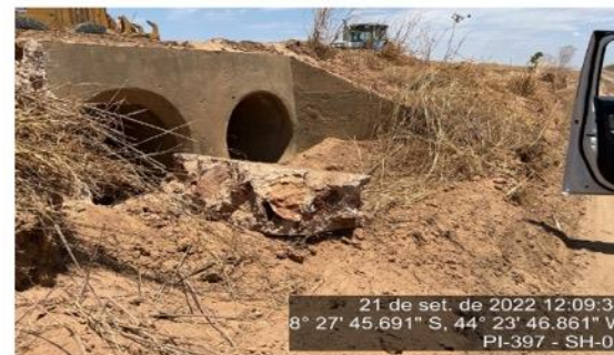
Bueiro duplo localizado no KM 116,6 do segmento, danificado.
