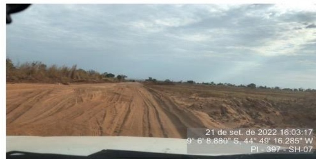
Trecho com leito estradal deteriorado.
