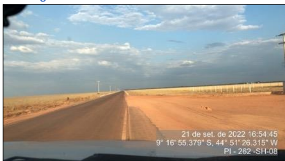
Figura 122 - Acesso irregular a direita da rodovia - SH-08-1
