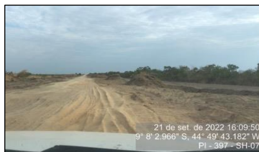
Figura 102 – Ponto com material solto – SH-07
