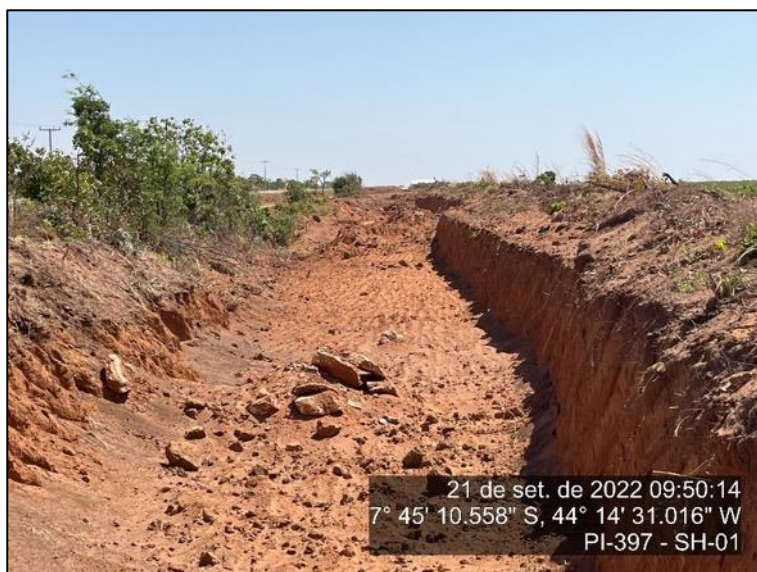
Figura 45 – Taludes negativos no bordo da rodovia – SH-01
