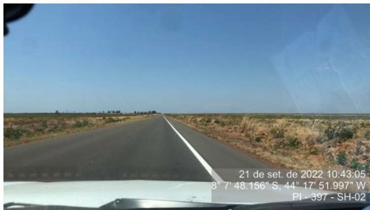
Figura 51 - Trecho com desnível entre as faixas do pavimento - SH-02
