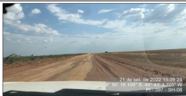
Ponto do trecho com material solto.
