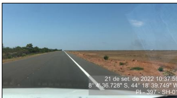
Figura 32 - Trecho sem dispositivos de drenagem – SH-01
