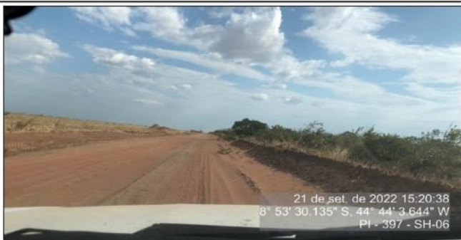
Ponto do trecho com material solto.
