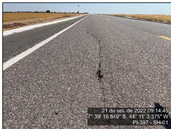
Figura 18 – Trincas longitudinais no pavimento – SH-01
