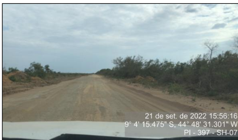
Figura 105 – Leito da pista com a elevação inferior aos bordos da rodovia - SH 07
