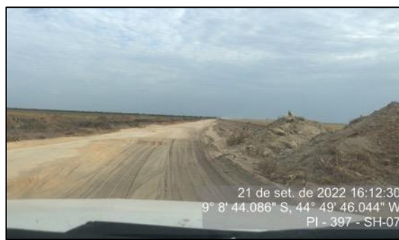
Figura 117 – Trecho sujeito a alagamento no mês de setembro/22 - SH-07
