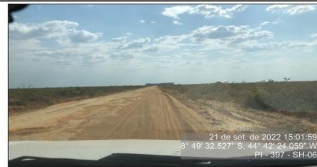
Ponto do trecho com material solto.
