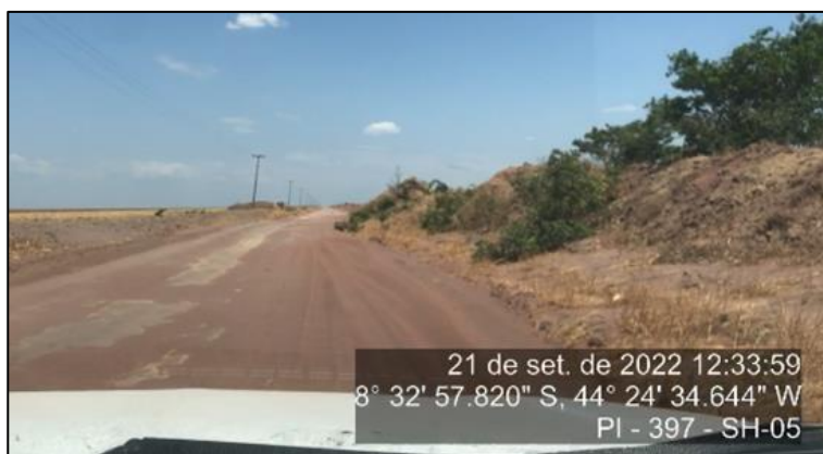
Figura 86 – Trecho com material solto – SH-05
