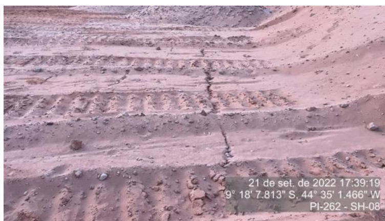
Figura 138 - Formação de trincas no bordo do Bota-fora
