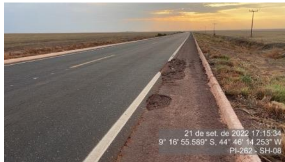
Figura 141 - Buraco no acostamento - SH-08
