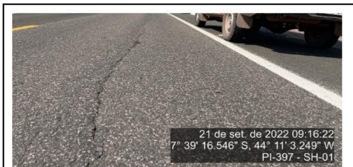
Trincas longitudinais e afundamento de trilha de roda no pavimento asfáltico da faixa de rolamento.
