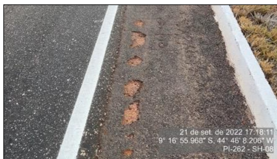
Figura 143 - Buraco em formação no acostamento - SH-08
