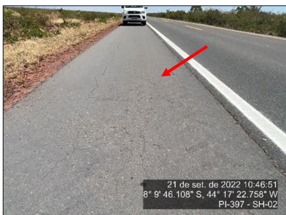
Figura 49 - Trincas no pavimento do SH-02
