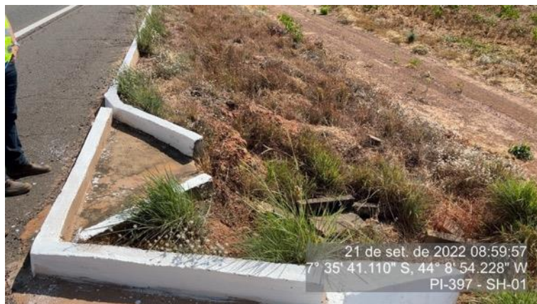
Figura 34 - Erosão pontual próximo à descida d'água
