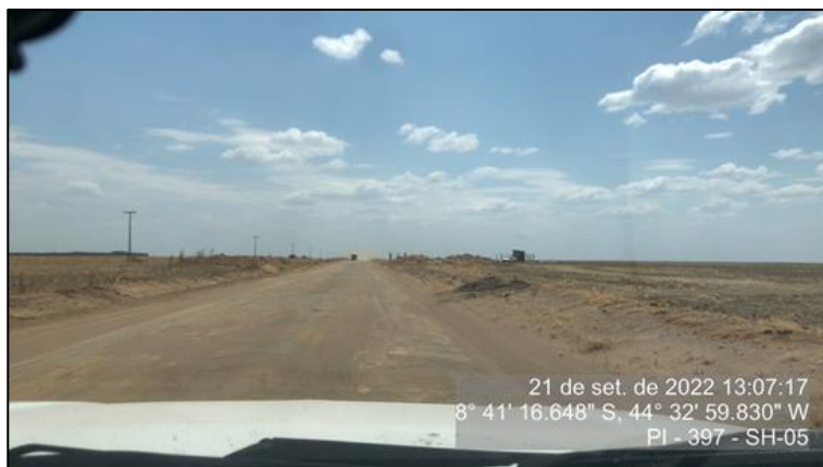
Figura 85 – Leito estradal após intervenção da Concessionária – SH-5
