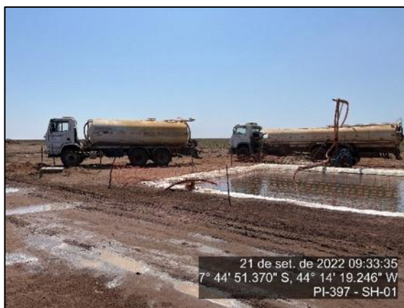
Figura 47 – Reservatório abastecendo caminhão pipa – setembro/22
