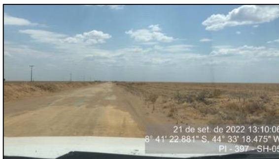
Figura 93 – Trecho sujeito a alagamento no mês de setembro/22 - SH-05
