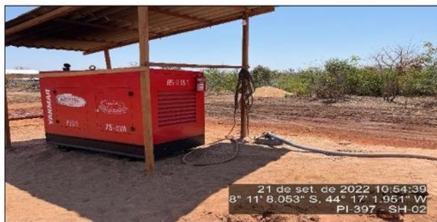
Gerador de energia do canteiro da P2
