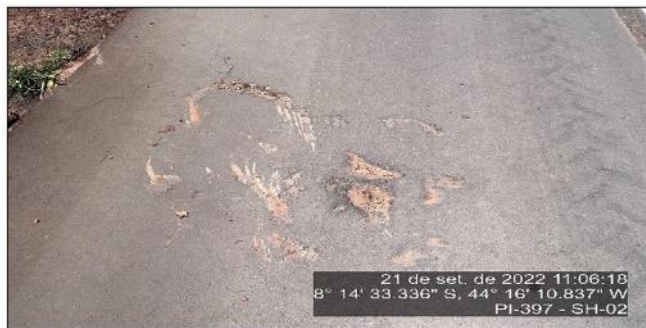
Buraco em formação no acostamento - SH-02
