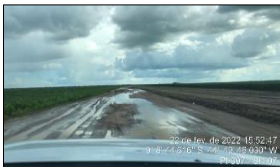
Figura 116 – Trecho alagado no mês de janeiro/22 - SH-05
