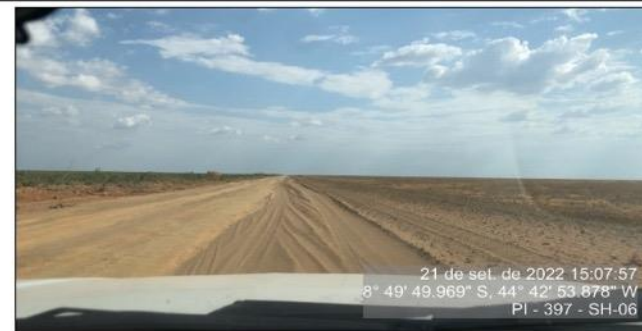
Ponto do trecho com material solto.
