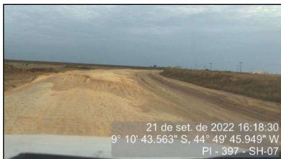
Figura 103 – Pista deteriorada – SH-07
