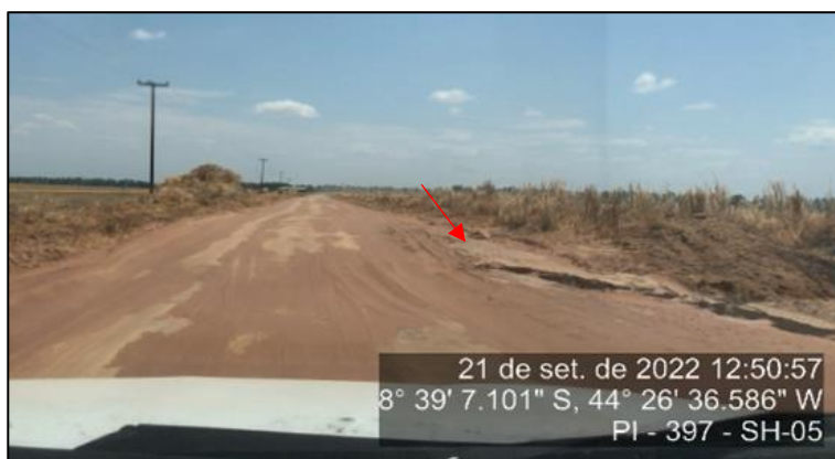
Figura 88 - Erosão causada pelo fluxo de águas pluviais – SH-05
