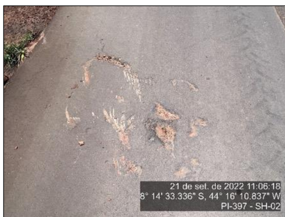
Figura 50 - Buraco em formação no acostamento do SH-02
