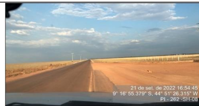
Zona com desgaste no pavimento asfáltico do acostamento da pista em local de acesso lateral irregular
