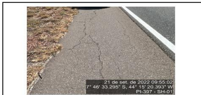
Trincas longitudinais e transversais no pavimento asfáltico do acostamento.
