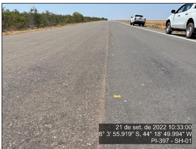
Figura 16 - Detalhe do desnível entre faixas contíguas – SH01
