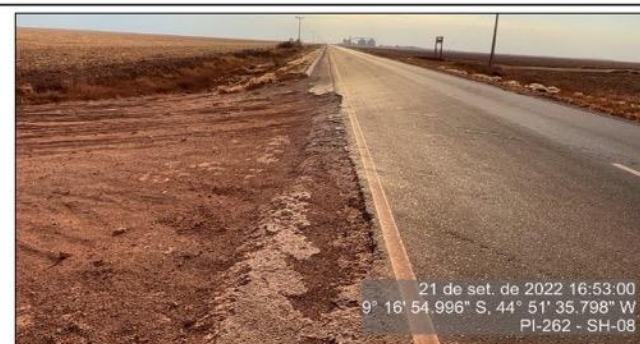
Zona com desgaste no pavimento asfáltico do acostamento da pista em local de acesso lateral irregular
