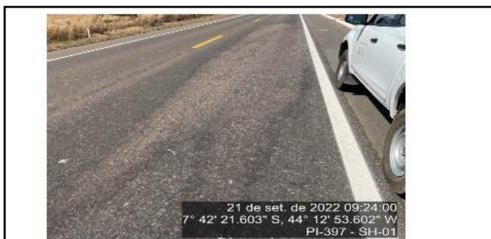
Zona com desgase no pavimento.
