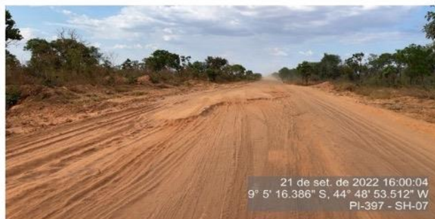
Trecho com leito estradal deteriorado.
