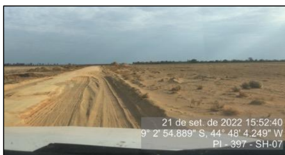
Figura 101 – Ponto com material solto – SH-07
