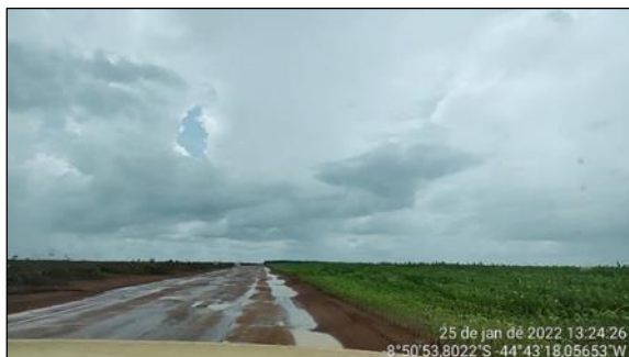
Figura 99 - Trecho alagado no mês de janeiro/22 - SH-06
