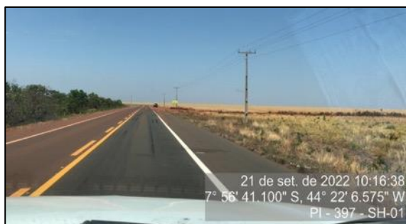
Figura 31 - Trecho sem dispositivos de drenagem – SH-01
