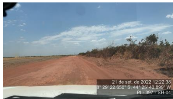
Figura 83 - Trecho sujeito a alagamento no mês de setembro/22 - SH-04
