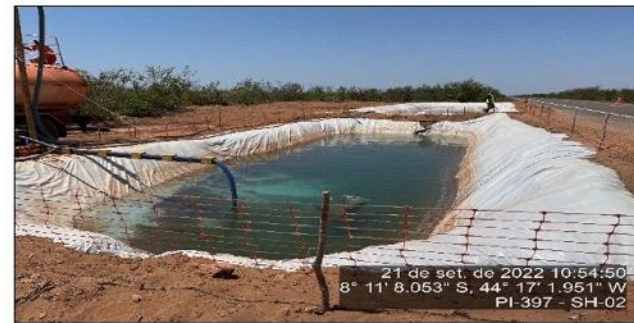
Reservatório de água do canteiro de obras da P2
