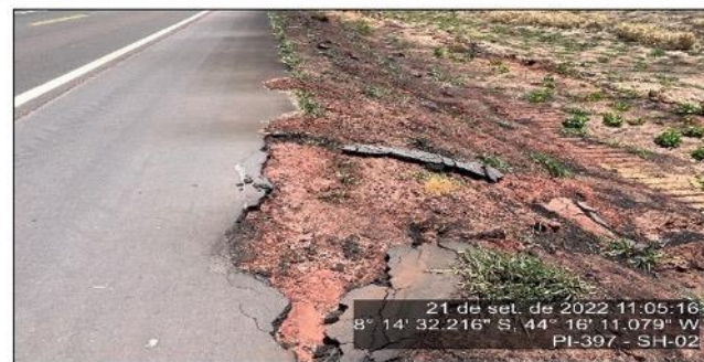
Revestimento arrancado no acostamento do Km 86 - SH-02
