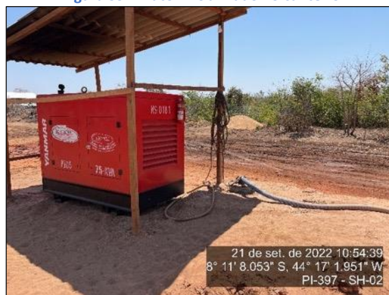
Figura 61 - Gerador de energia elétrica mobilizado no canteiro
