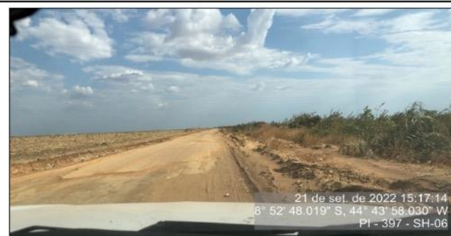
Batente formado por compactação não uniforme do leito da pista
