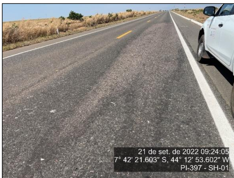
Figura 19 - Ponto com desgaste no pavimento – SH-01
