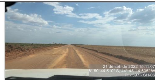
Ponto do trecho com material solto.
