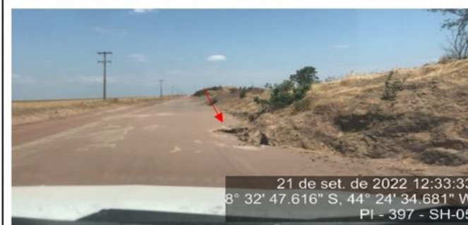
Erosão causada pelo fluxo de águas pluviais.
