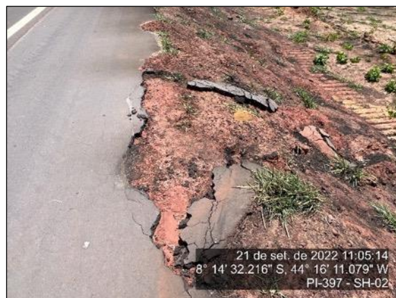
Figura 64 – Dano no acostamento no KM 86-SH-02
