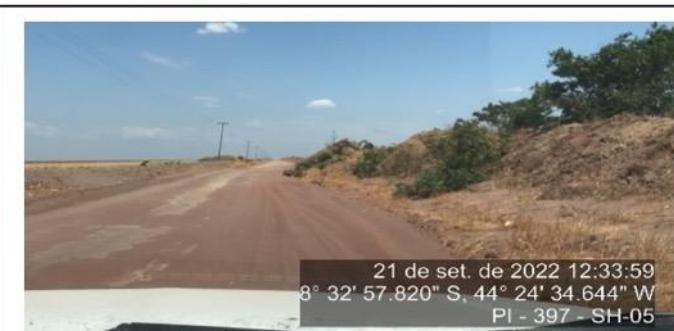
Trecho do segmento com material solto.
