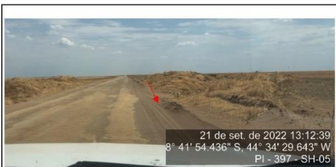
Valeta de drenagem para melhorar o escoamento da água para os poços de drenagem.
