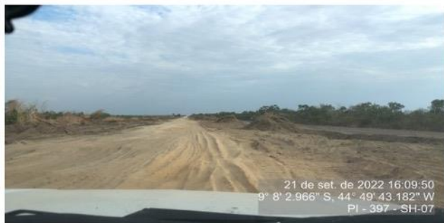
Trecho com material solto na pista.
