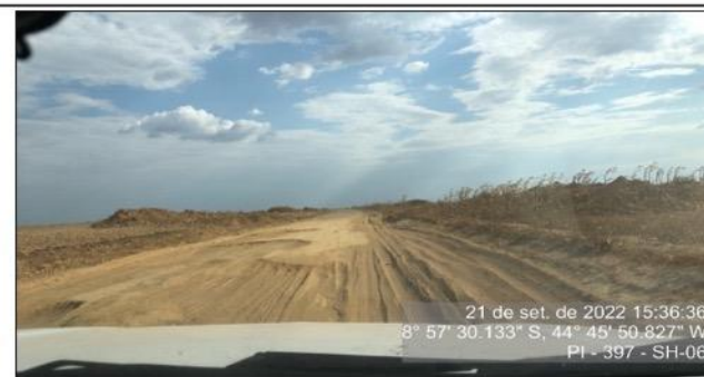
Batente formado por compactação não uniforme do leito da pista
