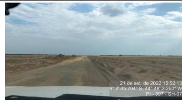
Leito estradal com elevação inferior aos bordos da rodovia .
