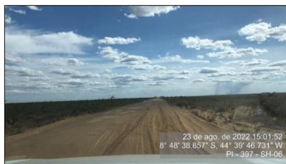
Figura 104 - Trecho com material solto-SH-06
