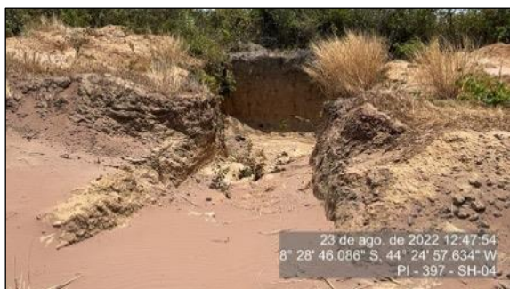
Figura 85 - Poço de drenagem - SH-04
