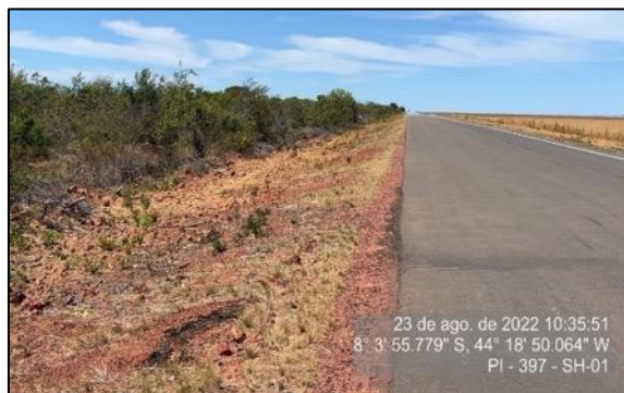
Figura 29 - Trecho sem dispositivos de drenagem – SH-01
