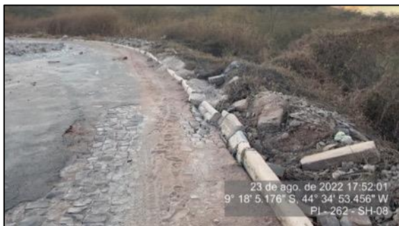
Figura 153 - Pavimento deteriorado na descida da Serra do Quilombo - 3
