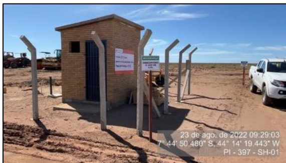
Figura 48 – Torre de comunicação P01 – agosto/22
