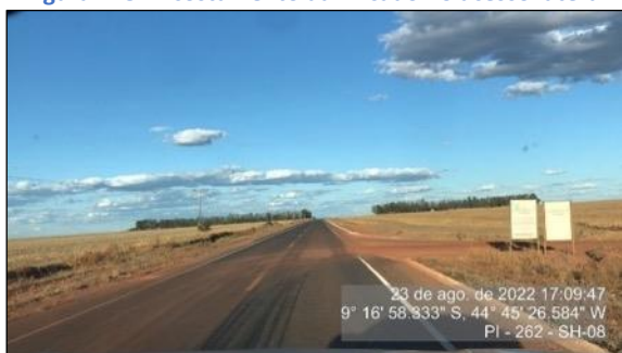
Figura 130 - Acostamento danificado no acesso lateral
