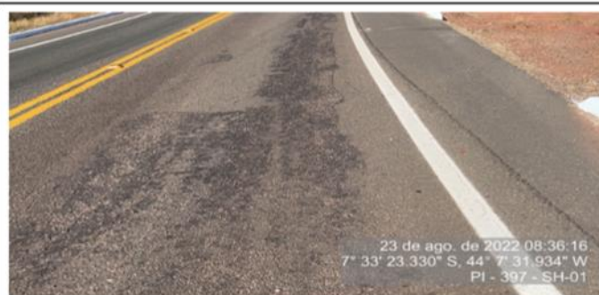
Zona com desgaste no pavimento.
