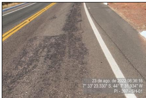
Figura 15 - Ponto com desgaste no pavimento – SH-01
