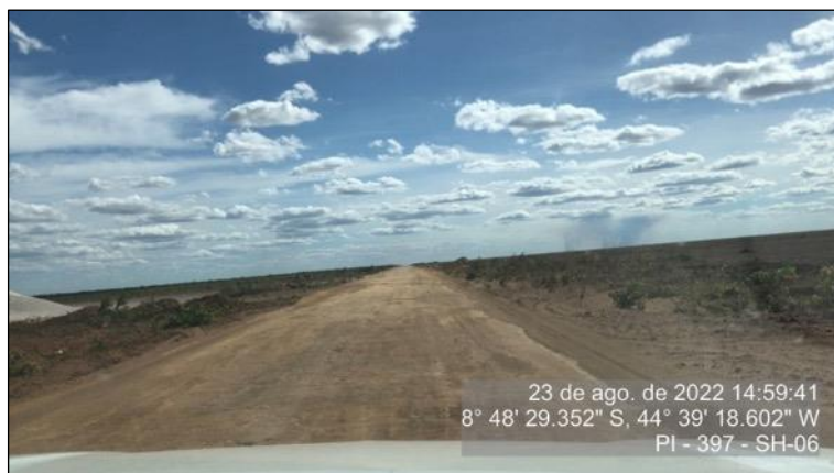
Figura 102 - Subleito com abaulamento em relação ao bordo-SH-06
