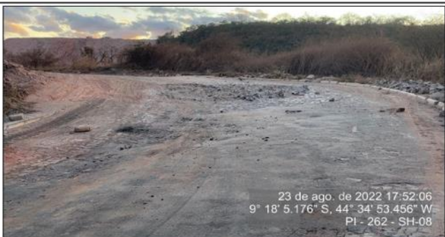
Pavimento danificado na área da obra de correção do traçado da Serra do Quilombo, km 33,65 da Rodovia PI-262, a serviço da SETRANS-PI.
