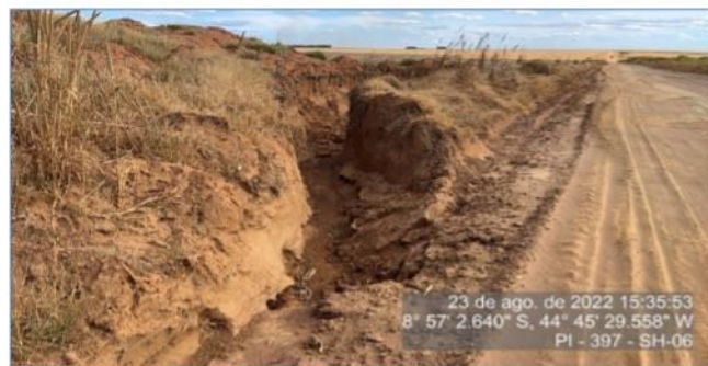
Entrada para poço de drenagem com valeta de drenagem.
