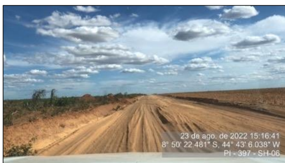
Figura 103 - Trecho com material solto-SH-06
