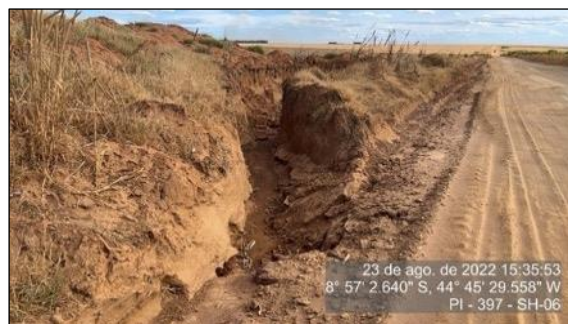
Figura 109 - Entrada para poço de drenagem (final da valeta)
