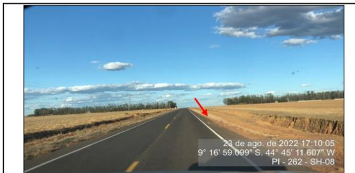
Zona com desgase no pavimento asfáltico do acostamento da pista.
