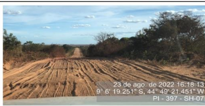
Trecho com leito estradal deteriorado.
