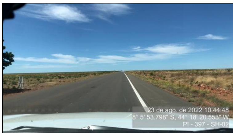
Figura 55 - Sinalização horizontal incompleta no trecho com desnível entre faixas - SH-02
