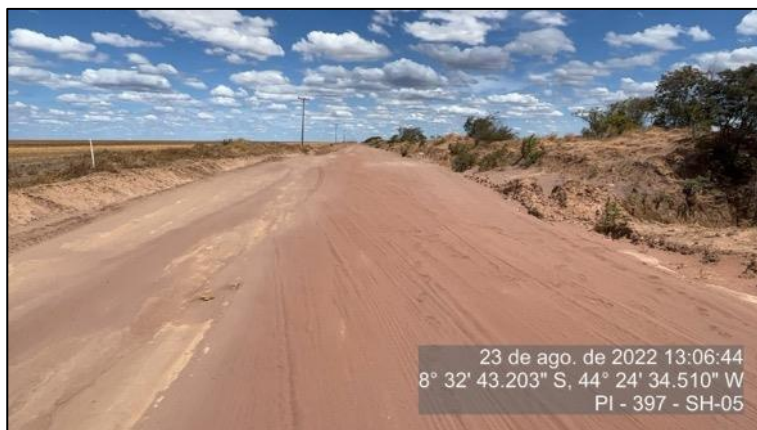
Figura 97 – Trecho com material solto – SH-05
