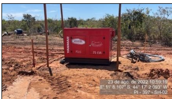
Figura 64 - Gerador de energia elétrica - SH-02
