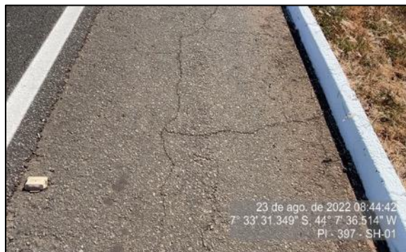
Figura 13 – Trincas longitudinais no acostamento – SH-01
