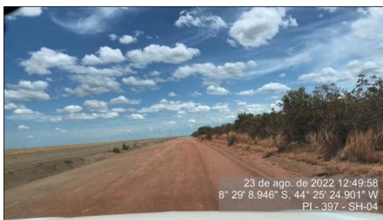
Figura 84 - Eixo da rodovia com elevação inferior aos bordos - SH-04
