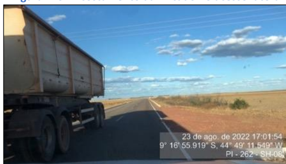
Figura 131 - Acostamento danificado no acesso lateral
