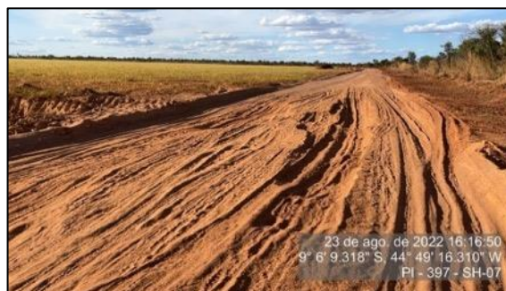
Figura 115 – Pista deteriorada – SH-07
