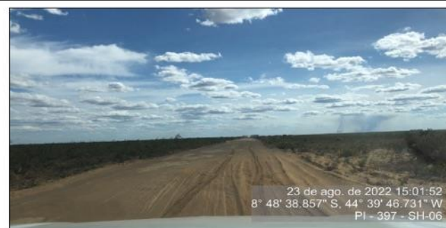
Ponto do trecho com material solto.
