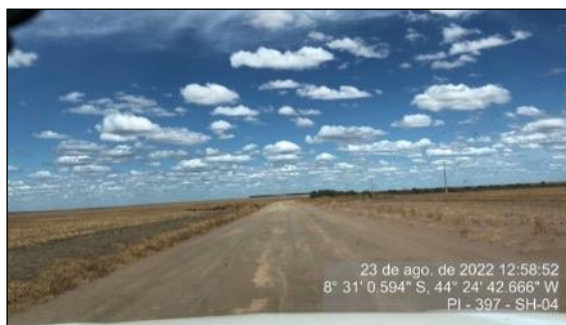
Figura 86 - Aspecto abaulado da pista – SH-04
