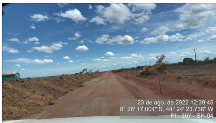
Figura 92 - Material depositado na lateral da pista
