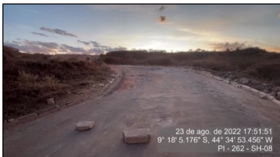
Figura 151 – Pavimento deteriorado na descida da Serra do Quilombo - 1
