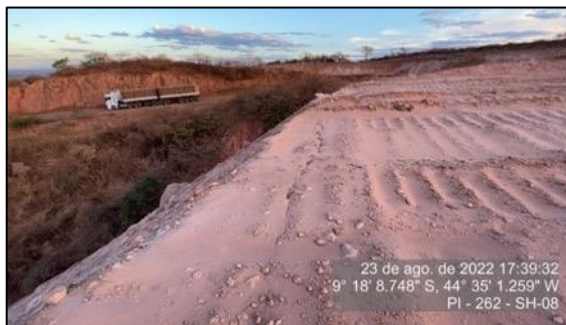
Figura 150 – Formação de trincas no bordo do Bota-fora - 2
