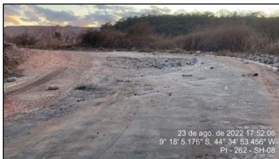
Figura 152 – Pavimento deteriorado na descida da Serra do Quilombo - 2
