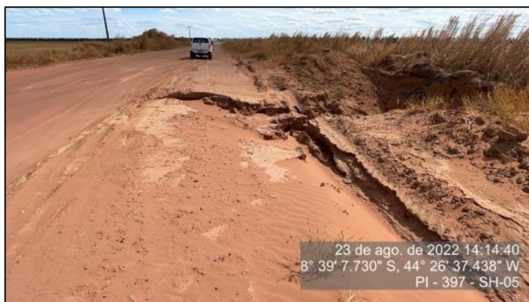
Figura 98 - Erosão causada pelo fluxo de águas pluviais – SH-05
