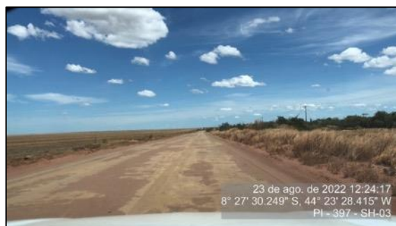
Figura 70 - Revestimento existente no último terço do SH-03
