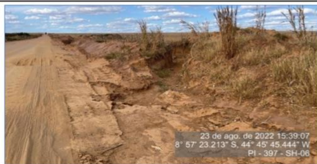
Erosão na entrada do poço de drenagem.
