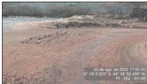
Figura 154 - Pavimento deteriorado na descida da Serra do Quilombo - 4
