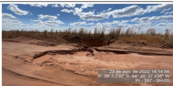
Erosão causada pelo fluxo de águas pluviais.
