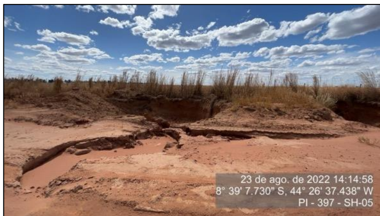
Figura 99 - Erosão causada pelo fluxo de águas pluviais – SH-05
