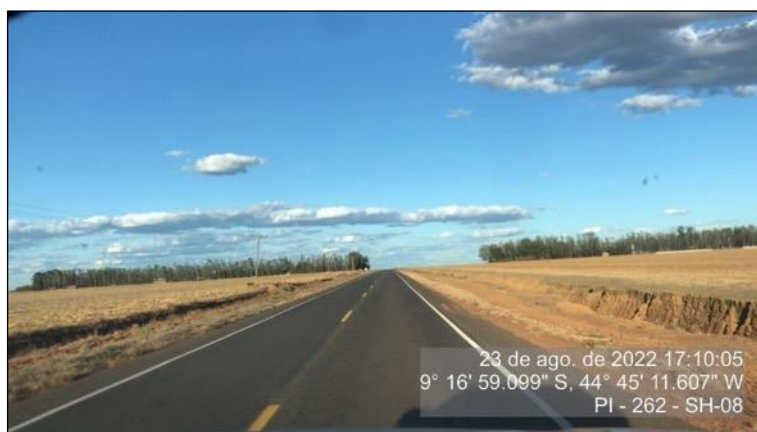
Figura 127 - Formação de buraco no acostamento-SH-08
