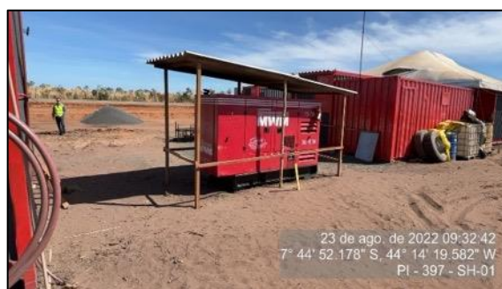
Figura 43 – Gerador de energia da P01 – agosto/22
