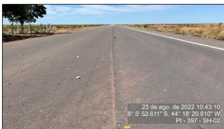
Figura 52 - Desnível entre faixas contíguas no SH-02
