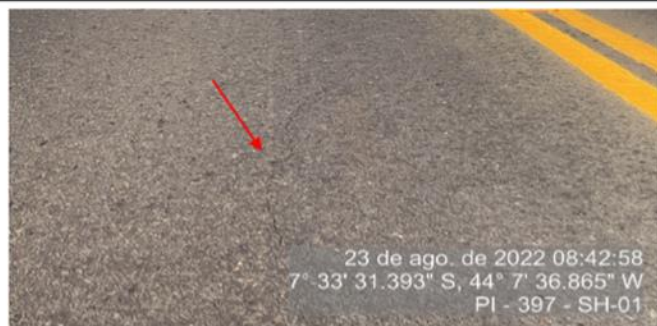
Trincas longitudinais no pavimento asfáltico da faixa de rolamento.
