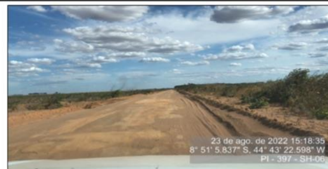
Segmento com eixo da pista mais baixo que a cota do terreno, podendo ocasionar acúmulo de água na pista.
