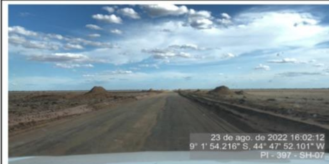
Leito estradal com elevação inferior aos bordos da rodovia .
