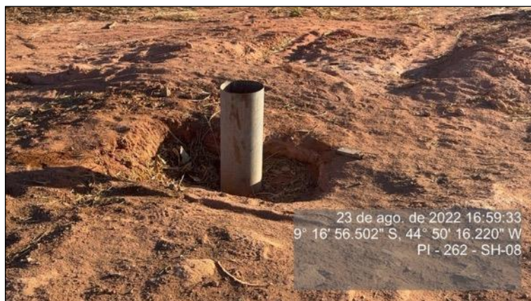
Figura 143 - Poço de abastecimento d'água - Praça de Pedágio P4
