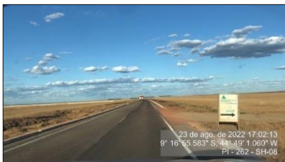
Figura 128 - Acostamento danificado no acesso lateral
