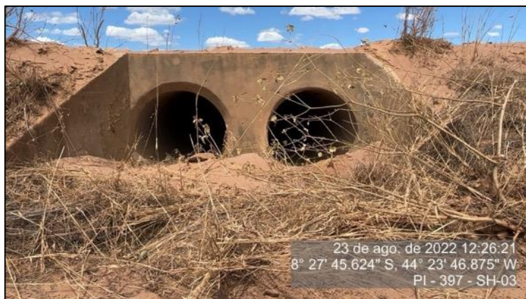
Figura 73 - Bueiro duplo no SH-03
