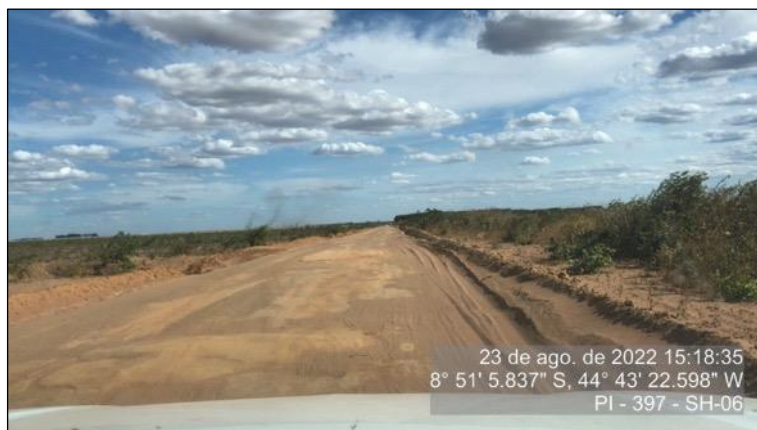
Figura 105 - Eixo da rodovia com elevação inferior aos bordos - SH-06
