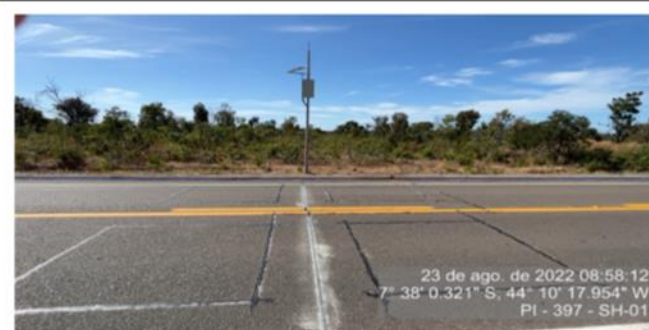
Sensor de veículos instalado no KM 10.
