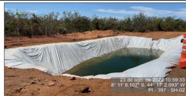
Reservatório de água da Praça de Pedágio P2 já implantado pela Concessionária.
