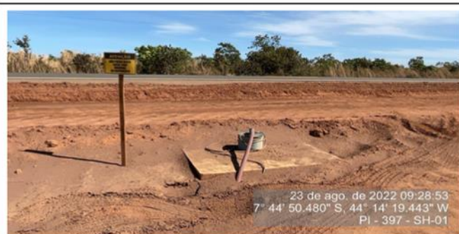
Poço de água da Praça de Pedágio 01.
