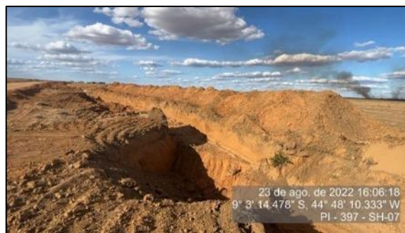
Figura 118 – Poço de drenagem no SH-07
