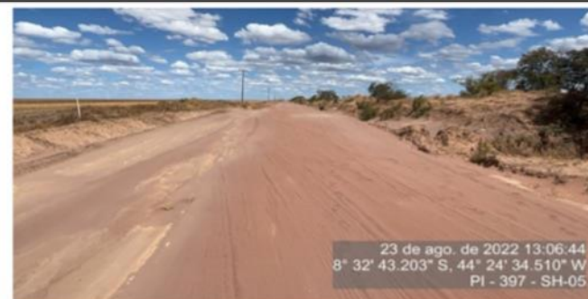
Trecho do segmento com material solto.
