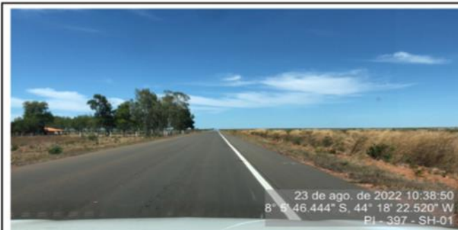
Final do segmento homogêneo 1 - Ainda necessitando de complementação na sinalização horizontal.
