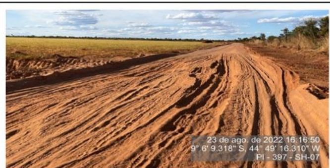
Trecho com leito estradal deteriorado.
