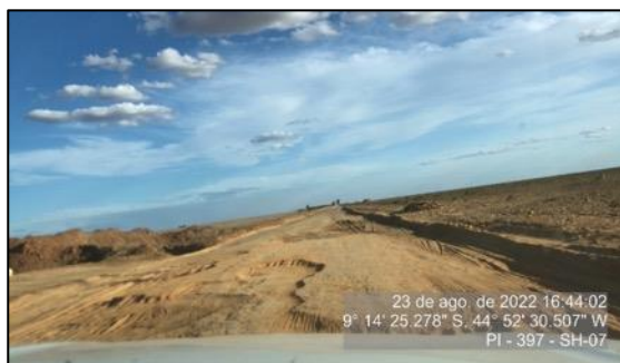
Figura 114 – Pista deteriorada – SH-07
