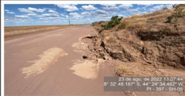
Erosão causada pelo fluxo de águas pluviais.
