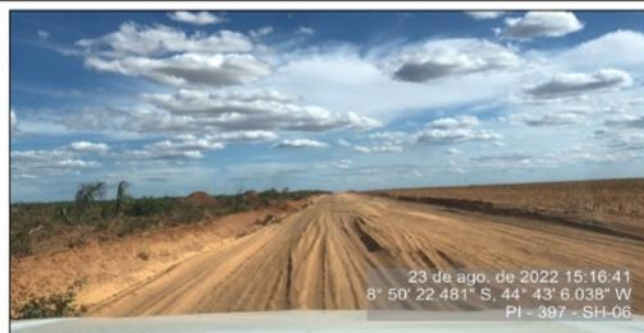
Ponto do trecho com material solto.
