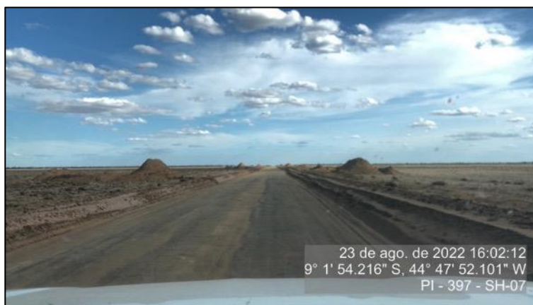
Figura 116 – Leito da pista com a elevação inferior aos bordos da rodovia - SH 07
