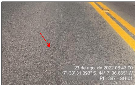
Figura 14 – Trincas longitudinais no pavimento – SH-01
