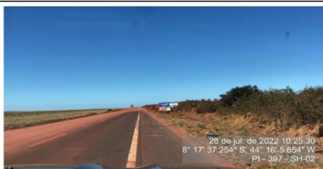
Final do segmento homogêneo 2 - Com sinalização horizontal coberta parcialmente por material argiloso.
