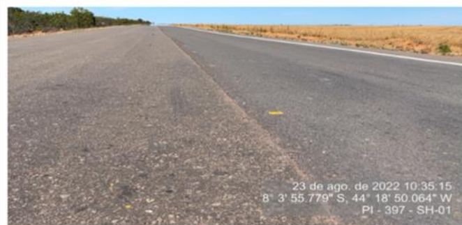
Diferença de nível do pavimento asfáltico entre as faixas de rolamento da pista, no KM 65,50.
