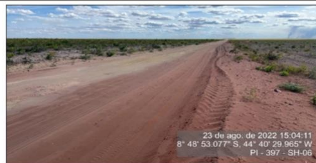
Ponto do trecho com material solto.
