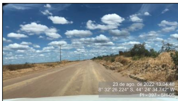
Figura 95 – Leito estradal após intervenção da Concessionária – SH-5
