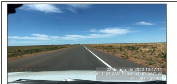
Início do segmento homogêneo 2 - segmento pavimentado. Ainda precisando de complementação na sinalização horizontal.
