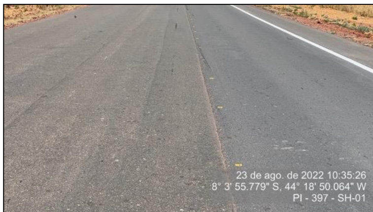
Figura 12 - Detalhe do desnível entre faixas contíguas – SH01
