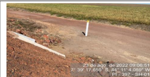
Delimitador de faixa de domínio.
