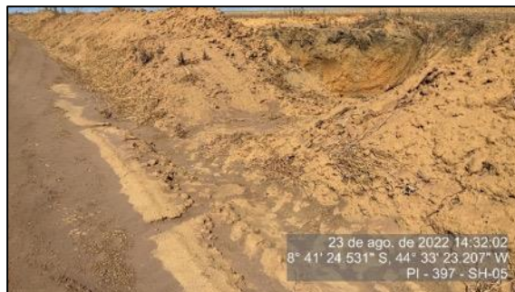
Figura 94 – Poço de drenagem – SH-05
