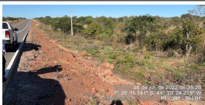
Talude de aterro sem recobrimento vegetal.
