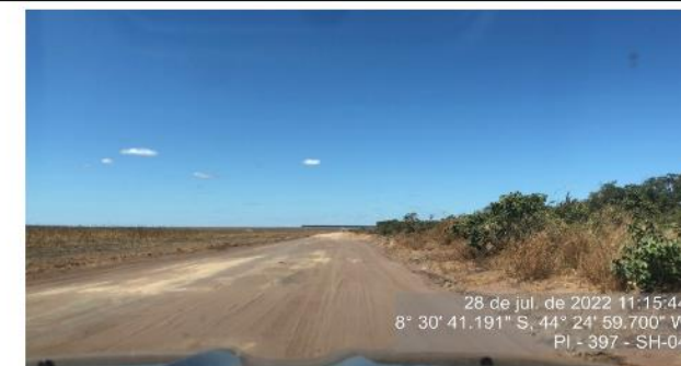
Ponto da pista com material solto
