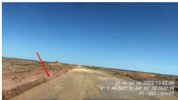
Figura 85 – Valeta de drenagem no SH-07
