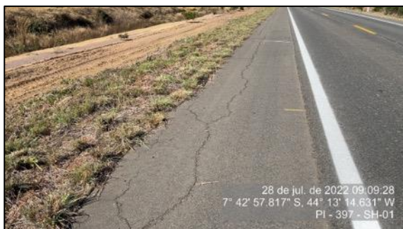
Figura 22 – Trincas longitudinais no pavimento – SH-01
