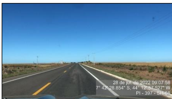
Figura 25 - Ponto com desgaste no pavimento – SH-01
