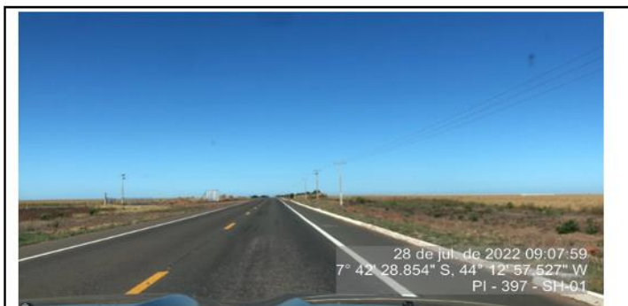
Zona com desgaste no pavimento.
