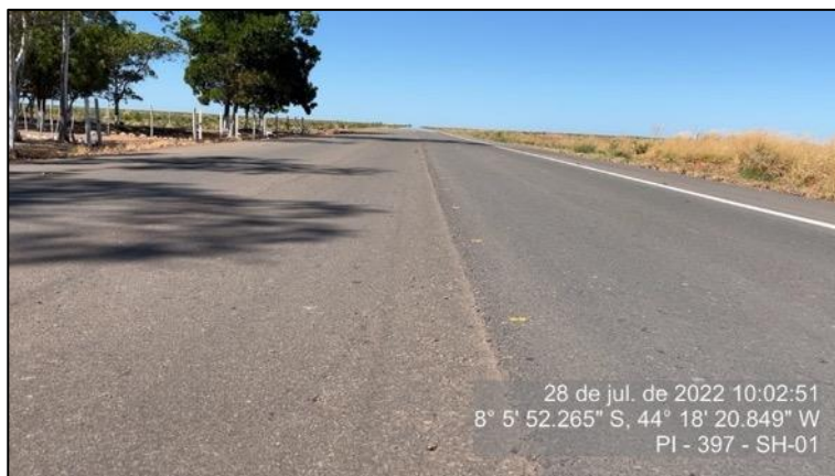
Figura 21 - Detalhe do desnível entre faixas contíguas – SH01
