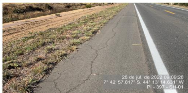
Trincas longitudinais no pavimento asfáltico do acostamento.
