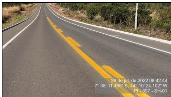
Figura 26 – Sinalização horizontal – SH1.
