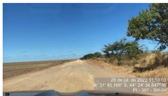
Figura 64 - Eixo da rodovia com elevação inferior aos bordos - SH-04
