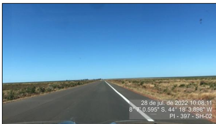
Figura 47 - Sinalização horizontal incompleta no trecho com desnível entre faixas - SH-02
