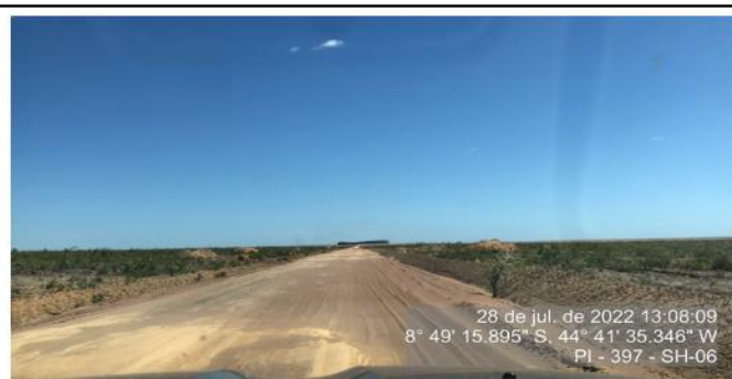
Ponto do trecho com material solto.
