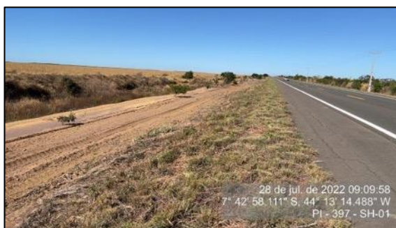
Figura 35 - Trecho sem dispositivos de drenagem – SH-01
