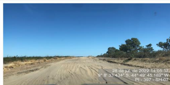
Trecho com material solto na pista.
