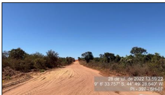
Figura 83 – Ponto com material solto – SH-07
