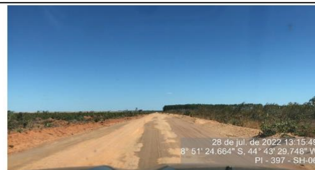
Eixo da pista mais baixo que a cota do terreno, o que pode ocasionar acúmulo de água na pista.
