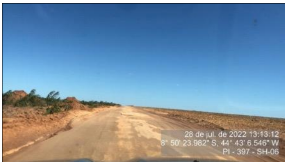
Figura 76 - Valeta de drenagem à esquerda da pista- SH-06
