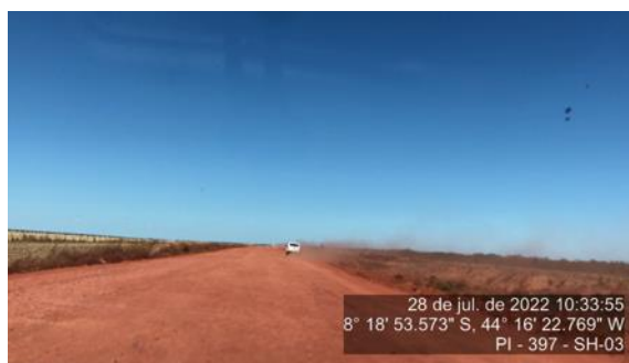
Figura 53 – Revestimento existente nos dois primeiros terços do SH-03
