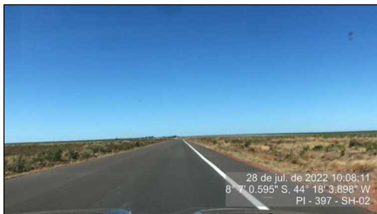
Figura 44 - Desnível entre faixas contíguas no SH-02
