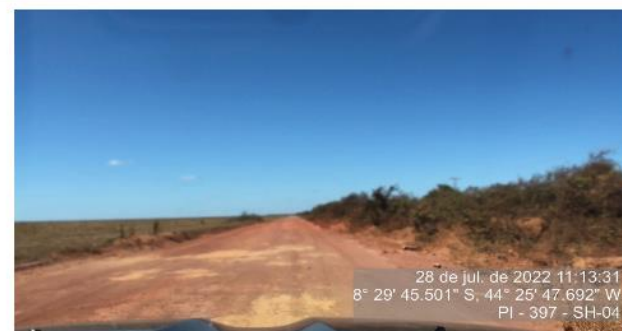
Eixo da pista está mais baixo que a cota do terreno, o que pode ocasionar acúmulo de água na pista.
