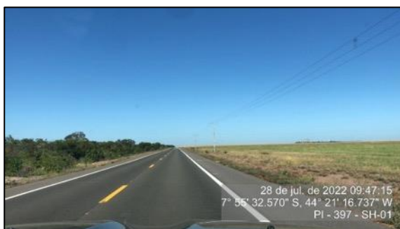
Figura 34 - Trecho sem dispositivos de drenagem – SH-01
