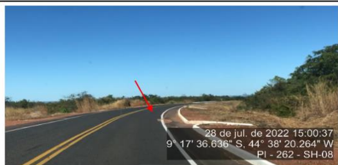
Buraco/panelas no pavimento asfáltico do acostamento.
