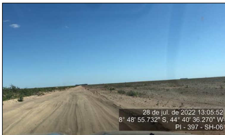
Figura 73 – Ponto com material solto – SH-06
