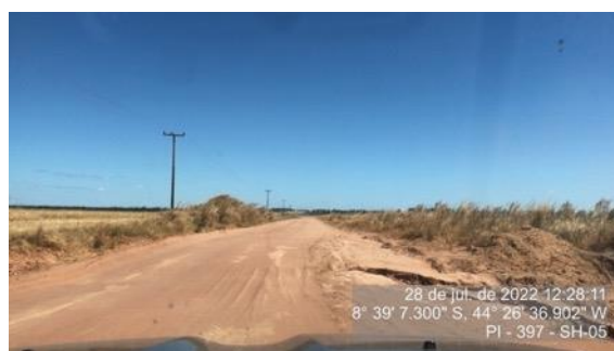
Figura 69 – Erosão causada pelo fluxo de águas pluviais – SH-05
