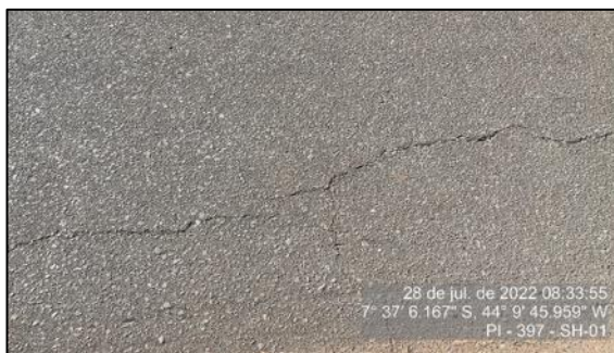
Figura 23 – Trincas longitudinais no pavimento – SH-01
