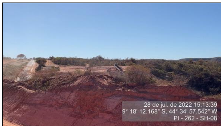
Figura 98 - Depósito de materiais sem compactação – SH-08
