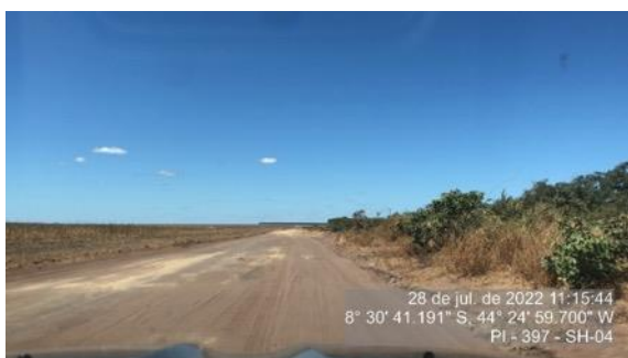
Figura 63 - Eixo da rodovia com elevação inferior aos bordos - SH-04
