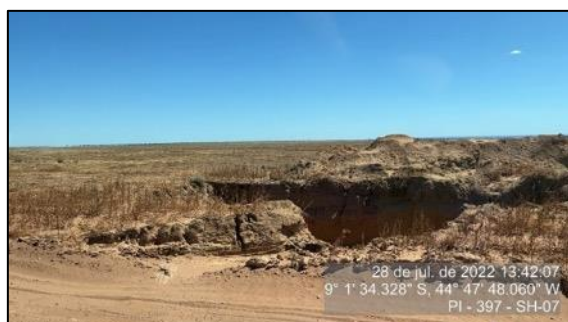
Figura 86 – Poço de drenagem no SH-07
