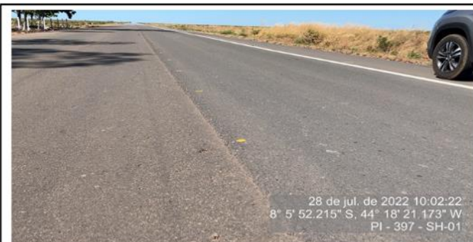
Diferença de nível do pavimento asfáltico entre as faixas de rolamento da pista, no KM 65,50.
