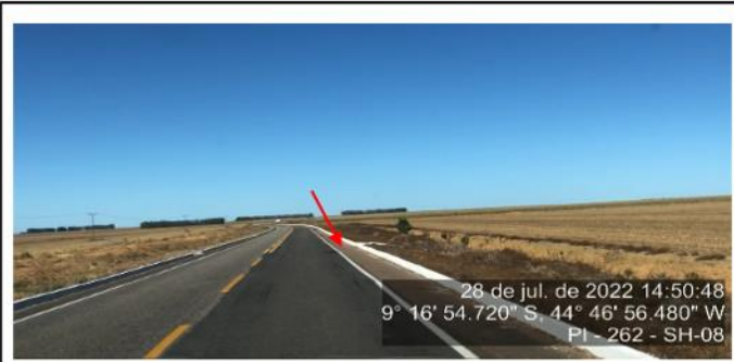
Zona com desgaste no pavimento asfáltico do acostamento da pista.
