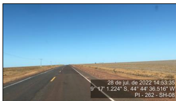
Figura 93 - Buraco no acostamento - SH-08
