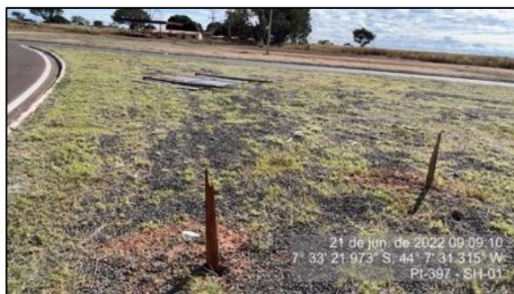
Figura 28 - Sinalização vertical danificada - SH 01 - (junho/22)
