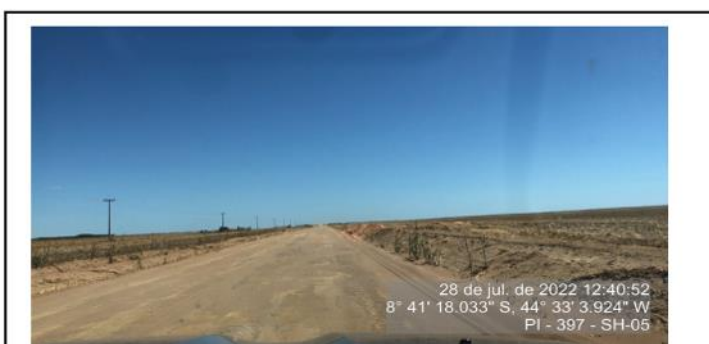
Trecho do segmento com eixo da pista mais baixo que os bordos, o que pode ocasionar acúmulo de água na pista.
