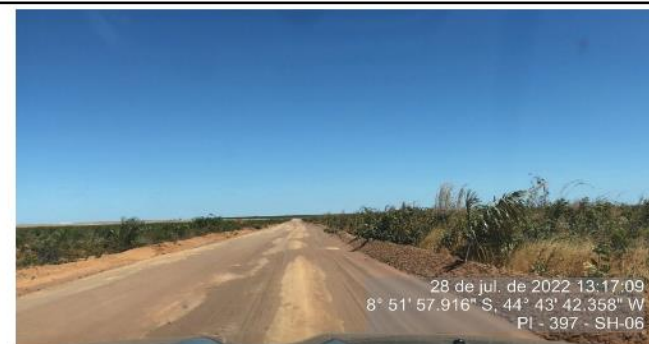
Bordo da pista precisando de limpeza e roçada.
