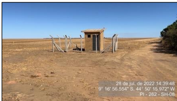
Figura 105 – Torre de apoio à torre de Comunicação na Praça P4
