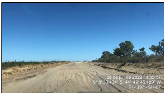
Figura 82 – Ponto com material solto – SH-07
