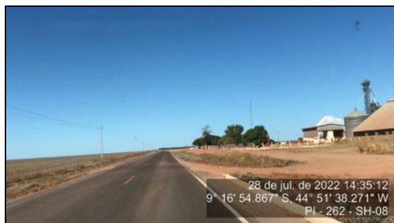
Figura 94 – Acostamento danificado - SH-08
