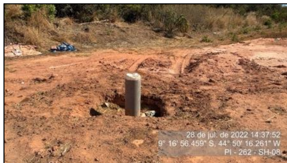
Figura 104 - Poço de abastecimento d'água - Praça de Pedágio P4
