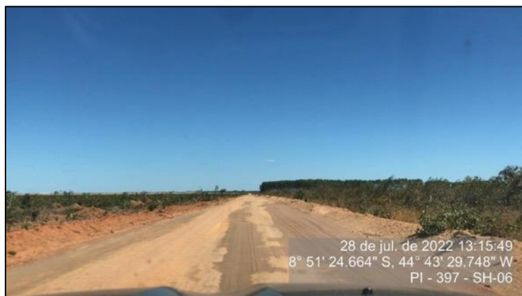
Figura 74 - Eixo da rodovia com elevação inferior aos bordos - SH-06
