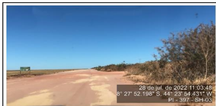
Final do segmento homogêneo 3 – segmento não pavimentado. Vegetação alta no bordo da pista.
