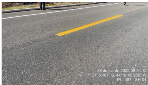
Figura 27 – Sinalização horizontal – SH1.
