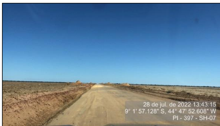
Figura 84 – Leito da pista com a elevação inferior aos bordos da rodovia - SH 07
