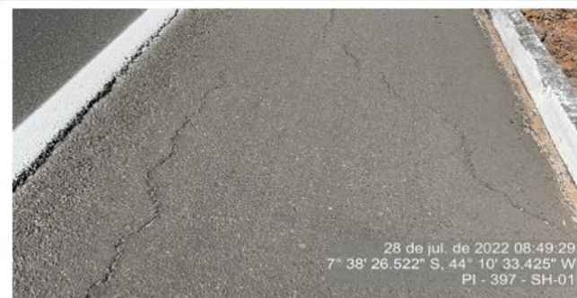
Trincas longitudinais no pavimento asfáltico do acostamento.
