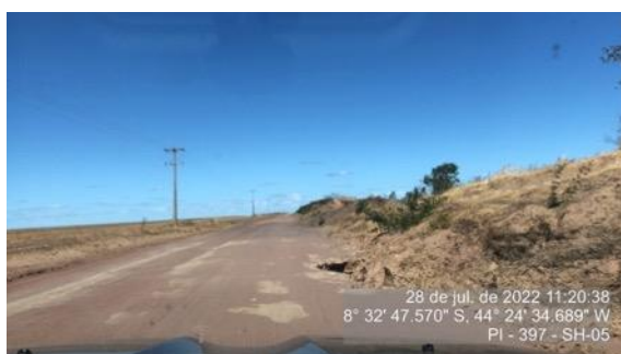
Figura 68 – Erosão causada pelo fluxo de águas pluviais – SH-05
