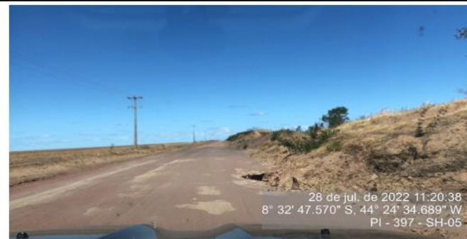
Buraco proveniente da erosão no solo devido ao escoamento da água das chuvas.
