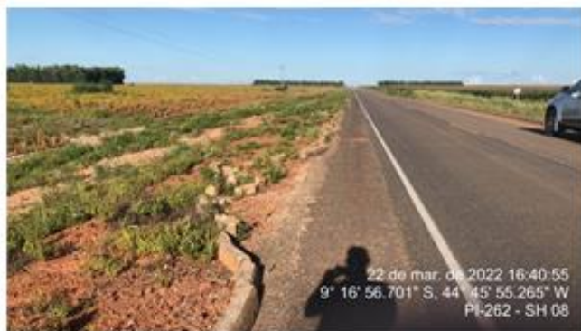
Meio fio danificado, precisando de reparos.
