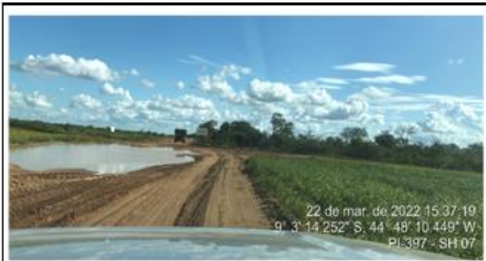
Buraco de grande proporção comprometendo a pista.
