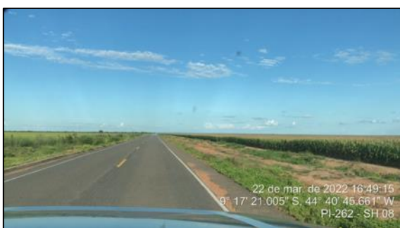
Figura 79 – Desgaste no acostamento – SH-08
