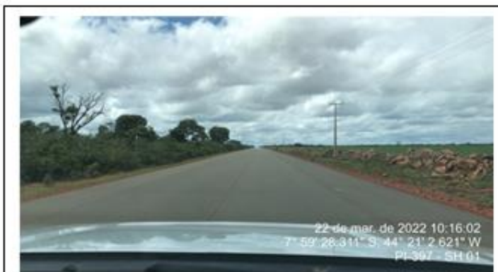
Bordos da pista precisando de limpeza e roçada da vegetação. Ausência de sinalização horizontal.
