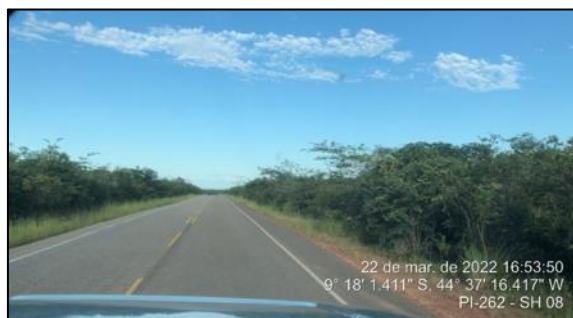
Figura 85 - Falta de sinalização vertical de ultrapassagem proibida - SH-08
