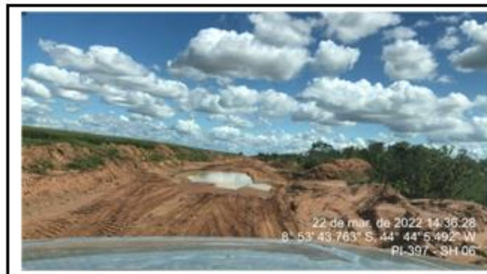
Buraco de grande proporção comprometendo a pista.
