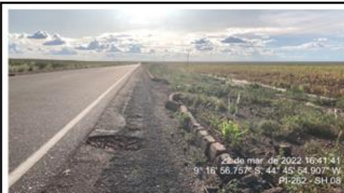
Buraco no pavimento asfáltico do acostamento da pista.
