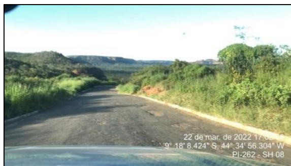
Figura 72 - Buracos na via - SH-08
