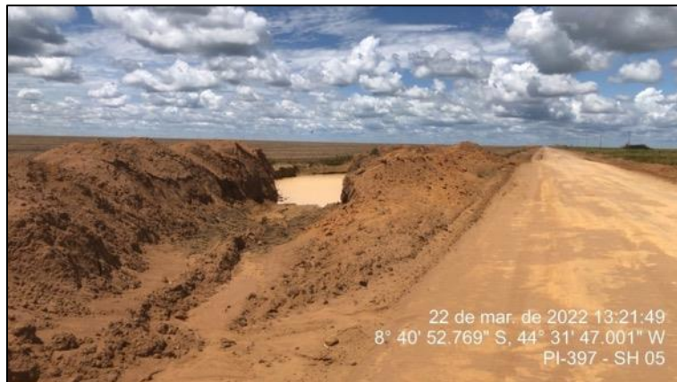
Figura 49 - Poço de drenagem em funcionamento no SH-05
