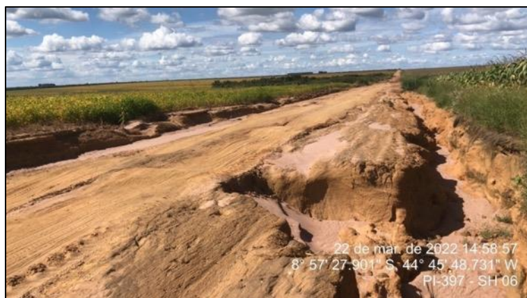
Figura 65 - Detalhe das erosões no SH-06
