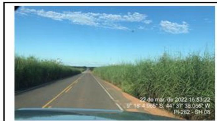
Deformação no pavimento em um dos bordos da pista.
