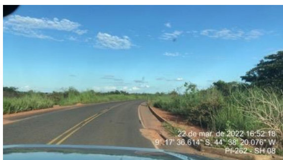
Figura 78 - Buraco no acostamento - SH-08
