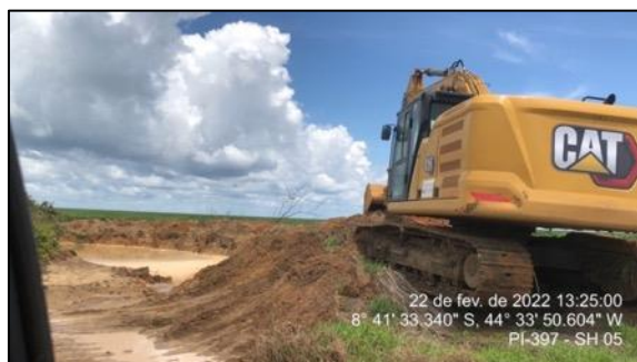
Figura 50 - Poço de Drenagem com capacidade esgotada - SH 05
