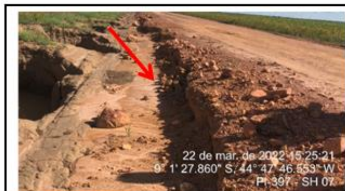
Início do processo erosivo no solo, presente nos dois lados da pista.
