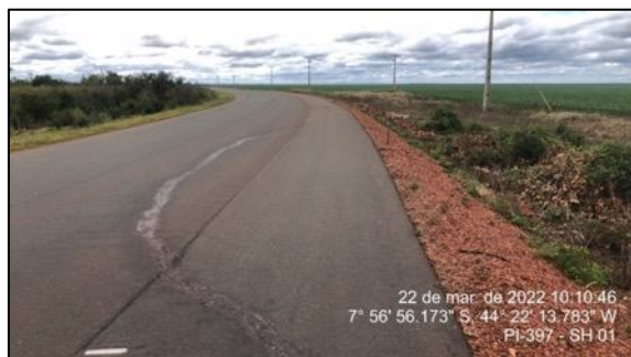
Figura 13 – Defeito no pavimento – km 60 – SH 01
