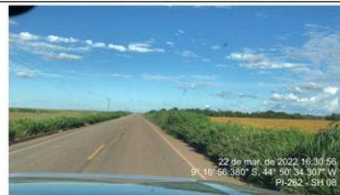
Vegetação cobrindo o meio fio da pista, precisando de limpeza e capina.
