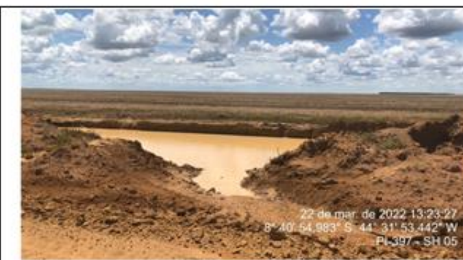
Poço de drenagem com a capacidade máxima.
