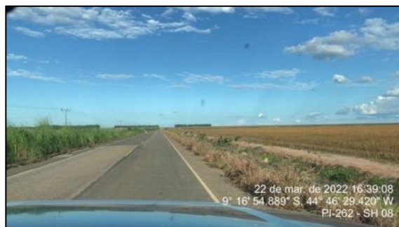
Figura 89 - Drenagem obstruída por ação humana - SH-08
