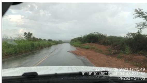
Figura 75 – Buracos na via – SH-08 – fevereiro/2022
