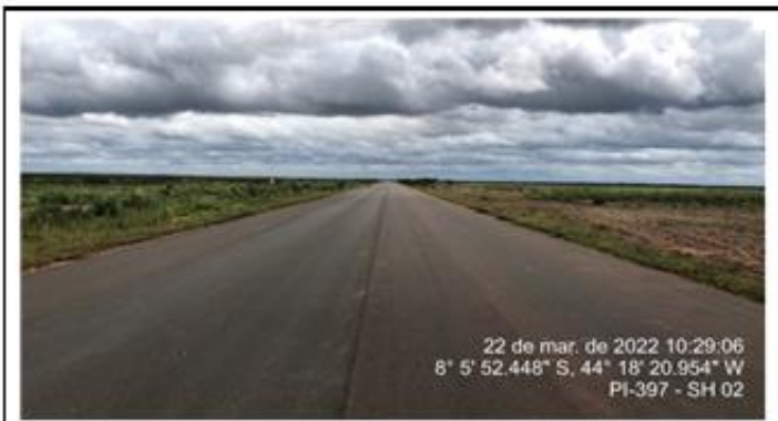
Início do segmento homogêneo 2 - segmento pavimentado. Ausência de sinalização horizontal.
