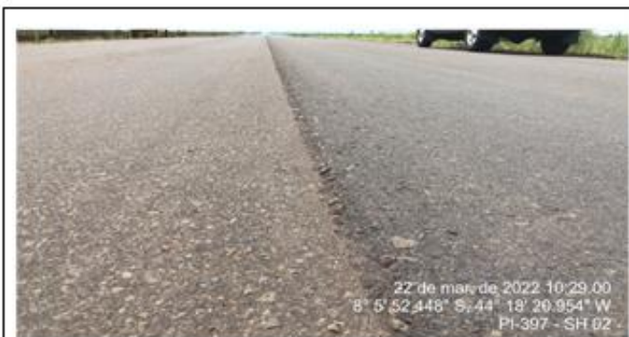
Diferença de nível do pavimento asfáltico entre as faixas de rolamento da pista.
