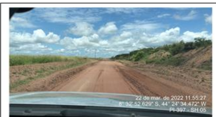
Eixo da pista está mais baixo que a cota do terreno, o que pode ocasionar acúmulo de água na pista.
