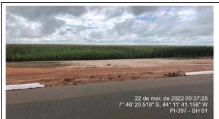
Meio fio quebrado precisando de reparos.
