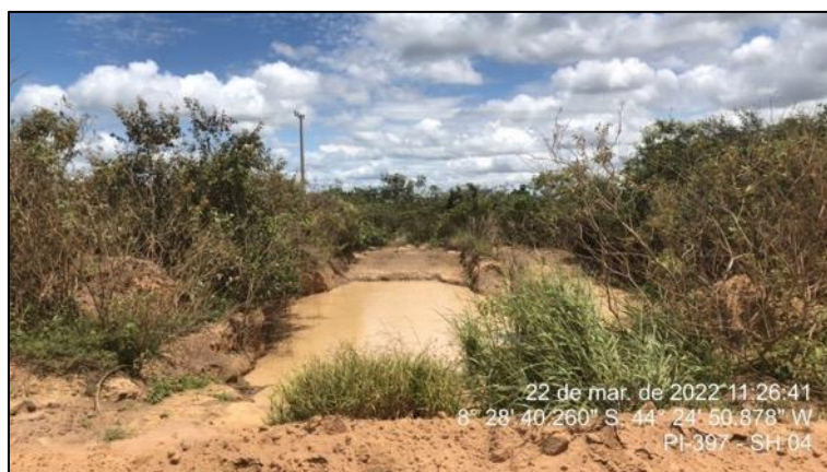
Figura 44 - Poço de drenagem em funcionamento no SH-04
