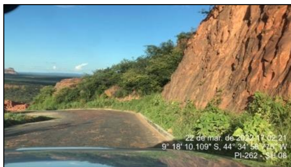
Figura 73 – Desgaste no pavimento – SH-08
