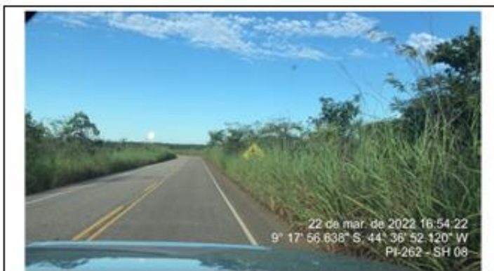
Vegetação alta cobrindo a sinalização vertical da pista.
