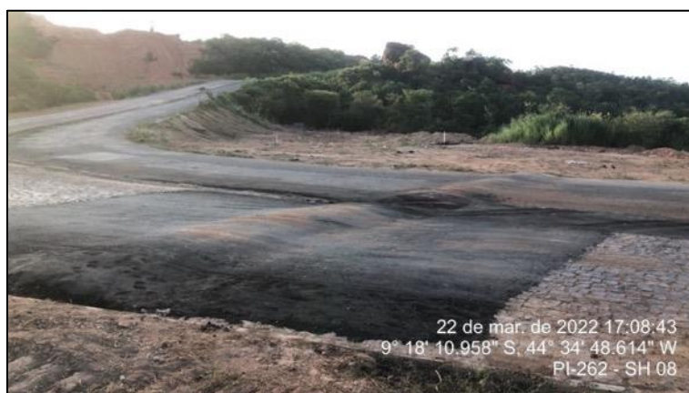
Figura 87 - Revestimento dos quebra-molas nas proximidades do km 34
