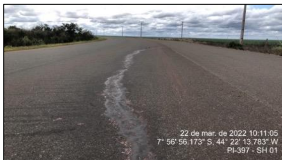
Figura 14 – Detalhe do defeito no pavimento km 60 – SH 01
