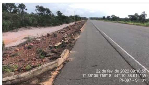
Figura 23 – Meio-fio danificado no SH 01 – Lado direito
