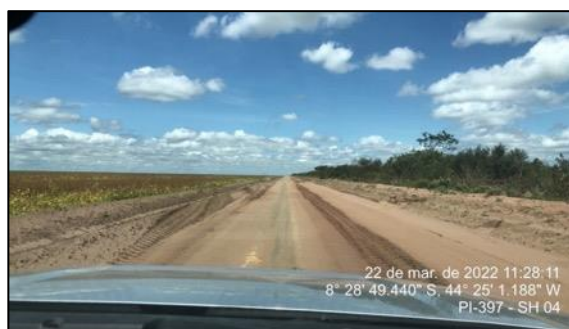
Figura 43 - Eixo da rodovia com elevação inferior aos bordos – SH-04
