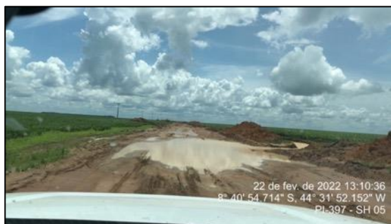
Figura 51 - Pista com acúmulo de água - SH 05
