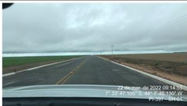
Sinalização horizontal precisando de reparos.
