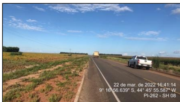
Figura 90 - Drenagem danificada - SH-08
