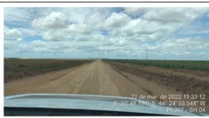
Eixo da pista está mais baixo que a cota do terreno, o que pode ocasionar acúmulo de água na pista.
