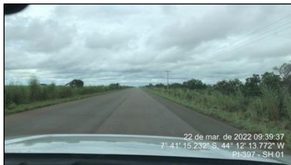
Figura 19 - Trecho sem sinalização horizontal ou vertical - SH 01
