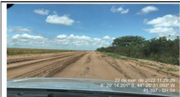
Ponto da pista degradado devido ação das chuvas e tráfego.
