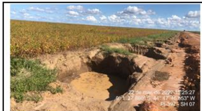
Poços de drenagem já existentes antes da Concessão em funcionamento.
