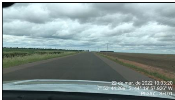
Figura 20 - Trecho sem sinalização horizontal ou vertical - SH 01
