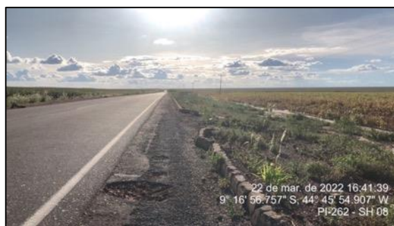
Figura 91 - Detalhe da drenagem danificada - SH-08
