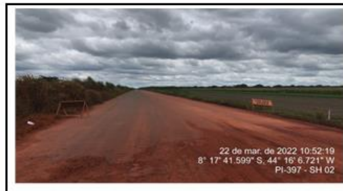
Final do segmento homogêneo 2 - Ainda com a ausência de sinalização horizontal.
