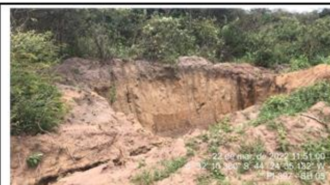
Poço de drenagem seco.
