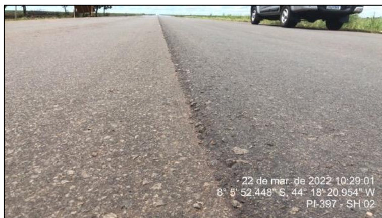
Figura 29 - Desnível entre faixas contíguas no SH 02
