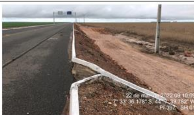
Faixa de domínio e decidas d'águas limpos pela concessionária.
