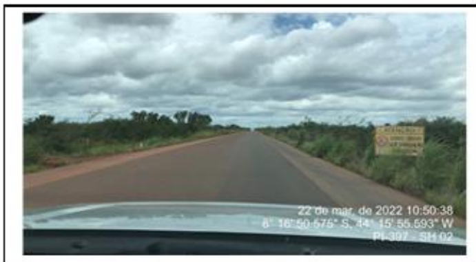
Vegetação alta cobrindo a sinalização vertical. Placa de aviso “ Longo trecho sem sinalização horizontal”
