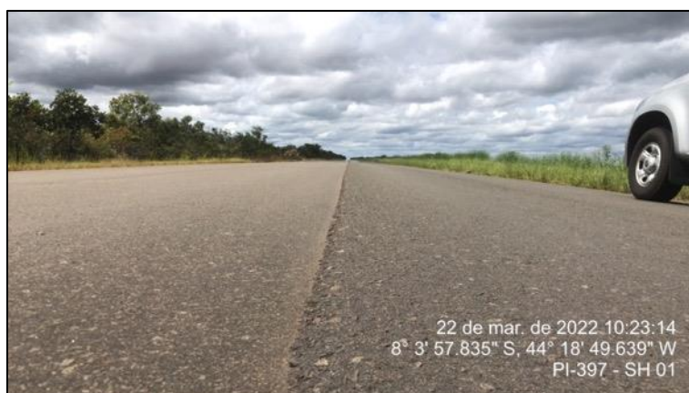
Figura 12 - Detalhe do desnível entre faixas contíguas – SH01
