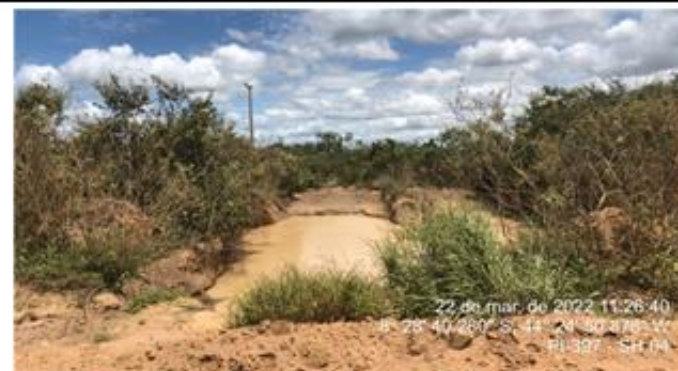
Poço de drenagem feito pela concessionária em sua capacidade máxima.
