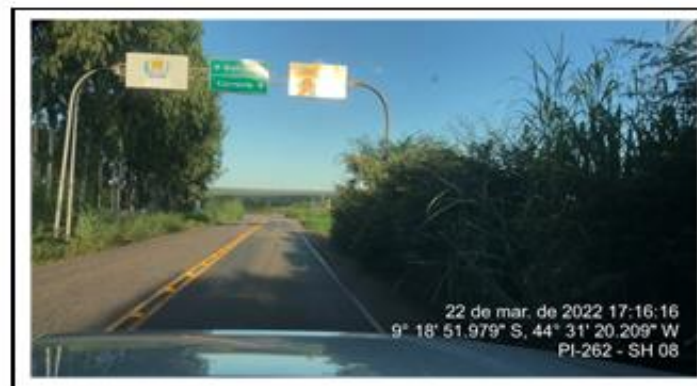
Final do segmento homogêneo 8 - sinalização horizontal conservadas. Vegetação alta no bordo da pista.
