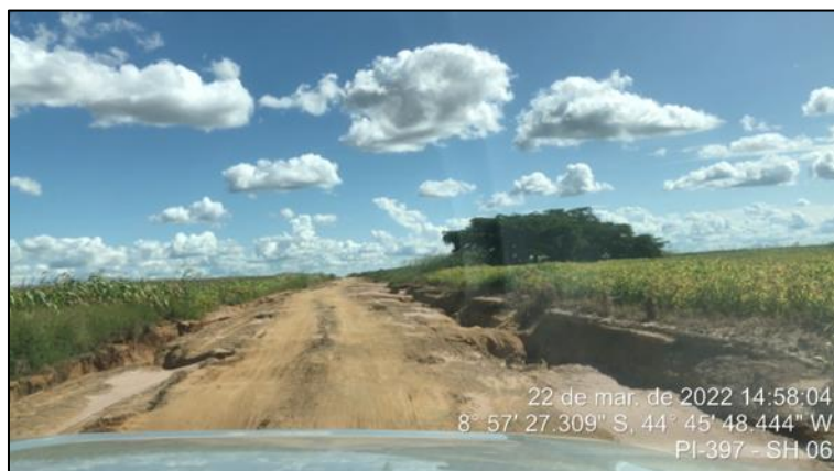
Figura 63 - Local com grandes erosões no SH-06 em março/2022
