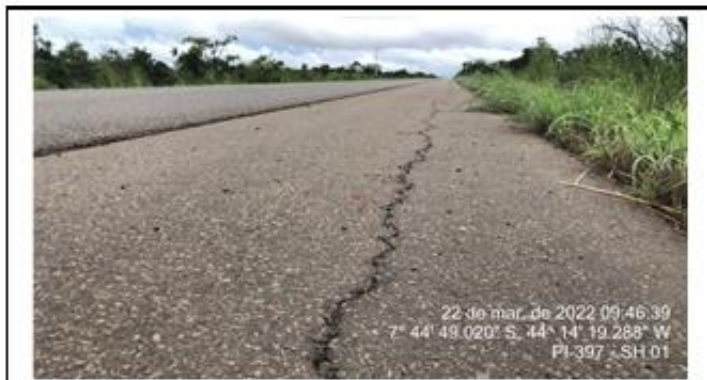
Fissuras no pavimento asfáltico do acostamento.
