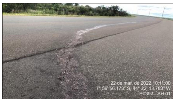
Figura 16 – Trincas formadas no ponto defeituoso – km 60 – SH 01
