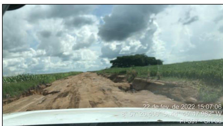
Figura 64 - Local com grandes erosões no SH-06 em fevereiro/2022
