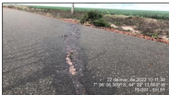
Figura 15 – Perda no pavimento – km 60 – SH 01
