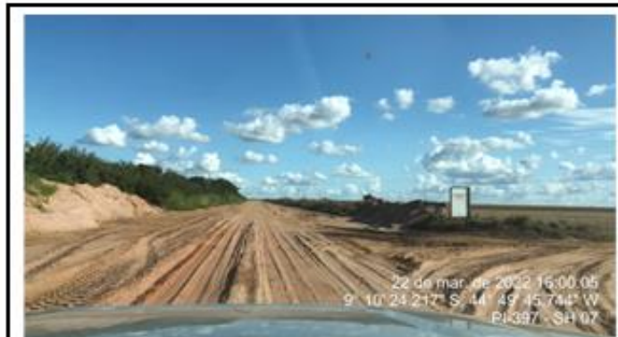
Ponto da pista sujeito à atolamento de veículos.
