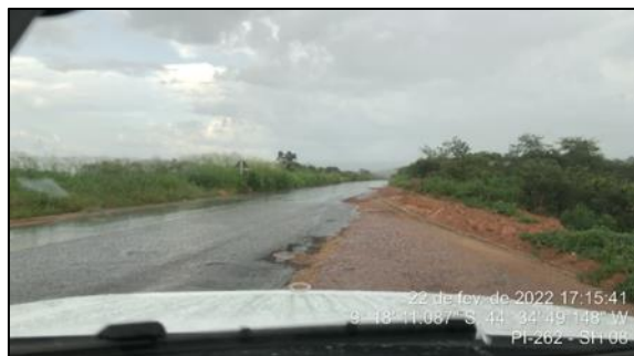
Figura 74 – Buracos na via – SH-08 – fevereiro/2022
