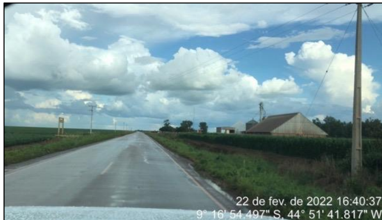
Figura 87 - Acúmulo de água no acostamento devido à obstrução dos dispositivos de drenagem - SH-08
