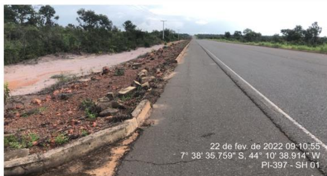
Meio fio precisando de limpeza e reparos.
