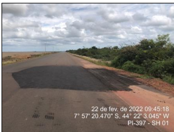
Figura 18 - Buraco nas proximidades do km 52, situação em fevereiro/22
