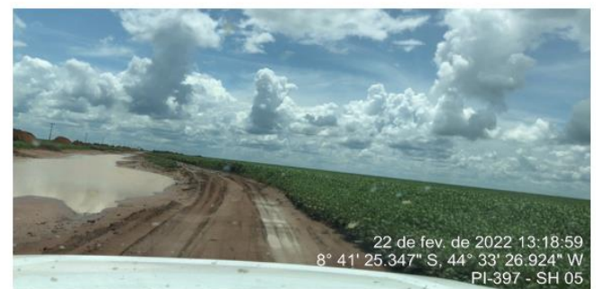
Alagamento comprometendo a pista, necessário desvio em propriedades privadas.
