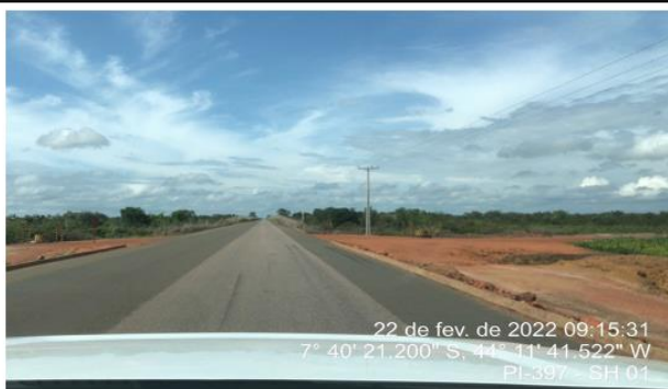
Ausência de sinalização horizontal na pista.
