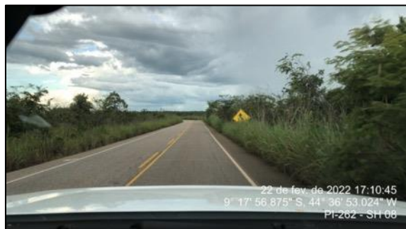
Figura 81 – Sinalização encoberta pela vegetação no segmento 08
