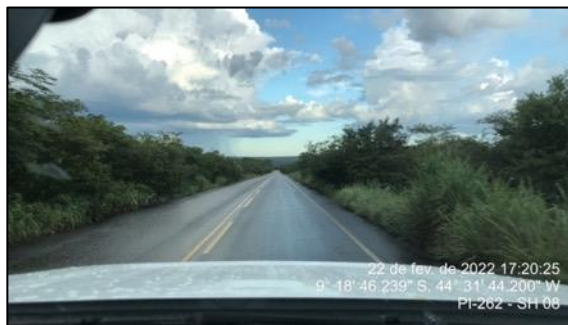
Figura 91 – Vegetação densa nos bordos da rodovia - SH-08
