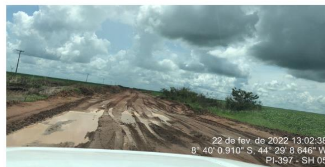
Solo saturado causando instabilidade no tráfego de veículos.
