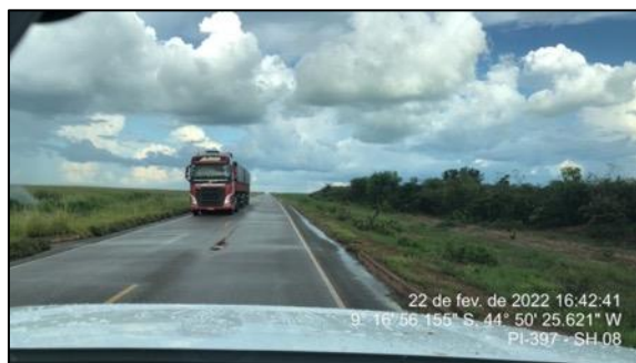
Figura 75 - Buraco na via - SH-08
