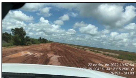
Figura 36 - Pista de rolamento em fevereiro/22 - SH 03
