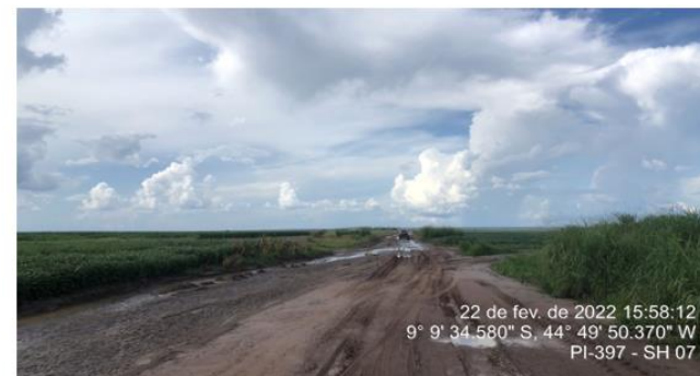
Pontos de alagamento na pista. Vegetação alta nos bordos da pista.
