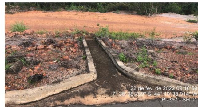
Descida d'água precisando de limpeza e reparos.
