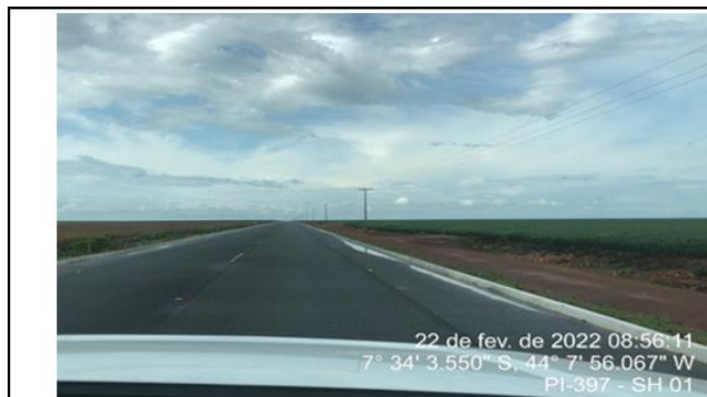
Sinalização horizontal precisando de reparos. Ponto de alagamento em um dos leitos da pista.
