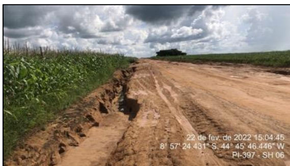
Figura 60 - Bordo da estrada com processo erosivo em fevereiro/22 - SH 06
