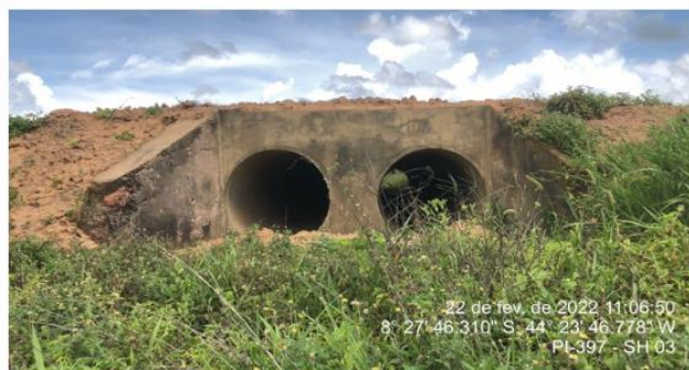
Bueiro de drenagem já existente necessitando de limpeza e reparos.
