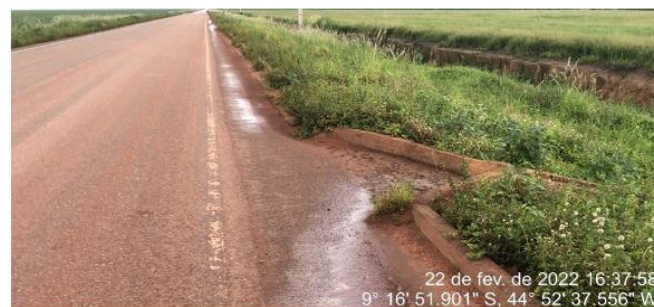
Meio fio da pista precisando de reparos e limpeza.
