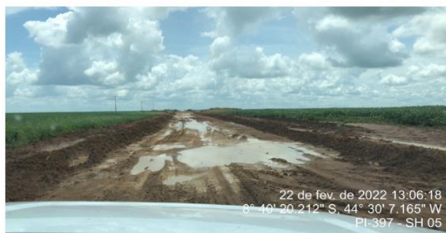
Acúmulo de água no meio da pista devido ao seu eixo ser mais baixo que a cota do terreno.
