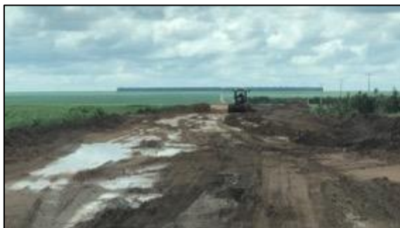
Figura 44 - Ponto com acúmulo de água - SH 04
