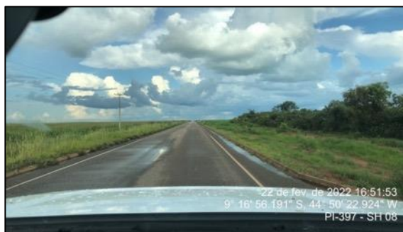
Figura 76 - Desgaste no pavimento - SH-08
