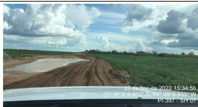
Buraco de grande proporção comprometendo a pista.
