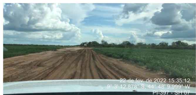
Atoleiro na pista. Difícil acesso para os veículos que tráfega no segmento.
