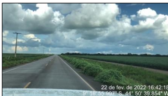
Figura 89 - Drenagem obstruída pela vegetação - SH-08
