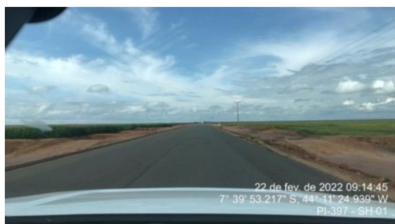
Figura 21 - Trecho sem sinalização horizontal ou vertical - SH 01
