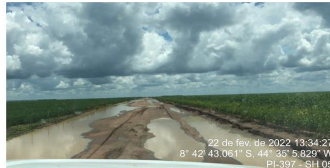
Alagamento nos dois lados da pista.
