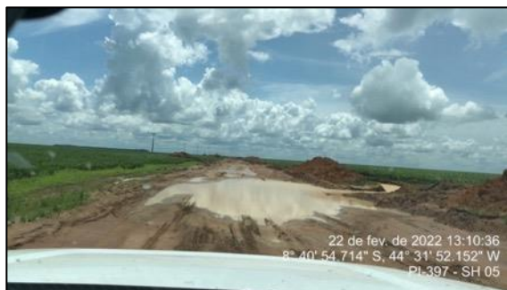
Figura 52 - Pista com acúmulo de água - SH 05
