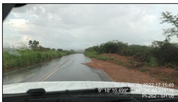
Figura 73 - Buraco na via - SH-08
