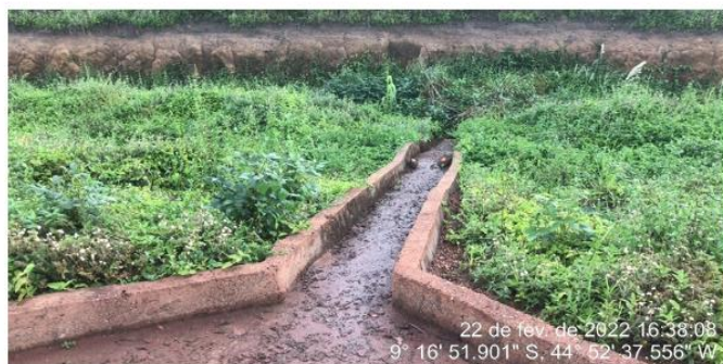
Queda d'água precisando de reparos e limpeza.
