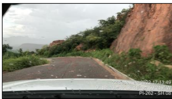
Figura 74 – Desgaste no pavimento – SH-08
