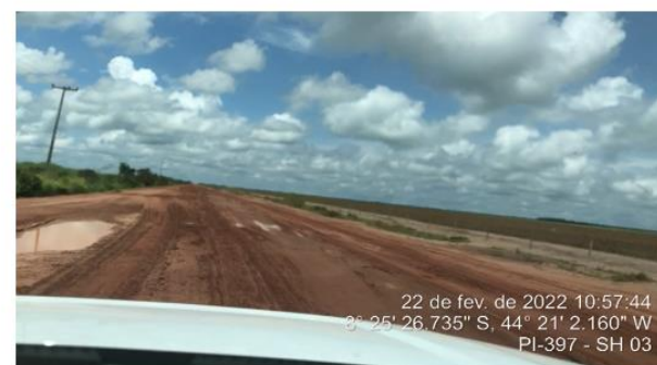
Buraco de grande proporção comprometendo um dos lados da pista.
