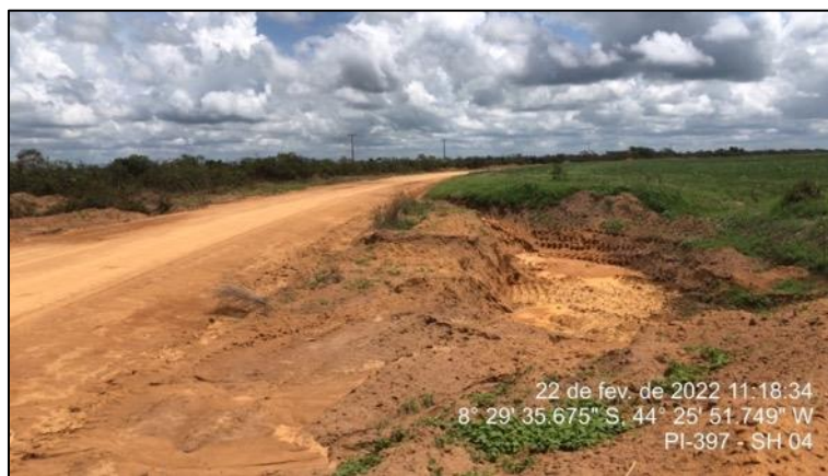
Figura 43 - Poço de drenagem - SH 04
