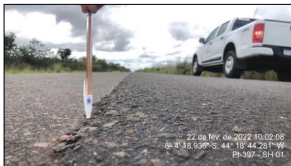
Figura 14 – Detalhe do desnível entre faixas contíguas – SH01
