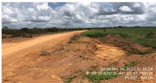
Poço de drenagem em perfeito funcionamento.
