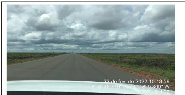
Início do segmento homogêneo 2 - segmento pavimentado. Ausência de sinalização horizontal.
