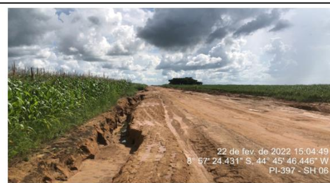
Processo erosivo no solo, presente nos dois lados da pista.
