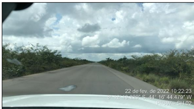
Figura 30 - Ponto de empoçamento no eixo - SH 02
