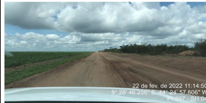
Eixo da pista está mais baixo que a cota do terreno, ocasionando acúmulo de água na pista.
