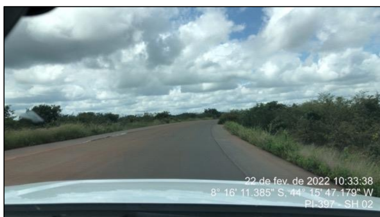
Figura 29 - Ponto de empoçamento no acostamento - SH 02
