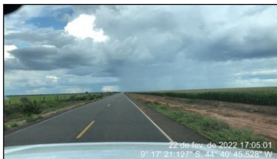
Figura 78 - Desgaste no acostamento - SH-08
