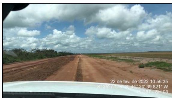
Figura 35 - Pista de rolamento em fevereiro/22 - SH 03
