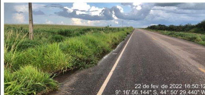
Vegetação cobrindo o meio fio da pista, precisando de limpeza.
