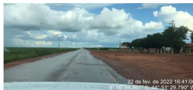
Deformação no pavimento asfáltico dos dois lados da pista.
