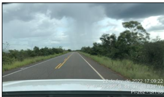
Figura 84 – Falta de sinalização vertical de ultrapassagem proibida - SH-08
