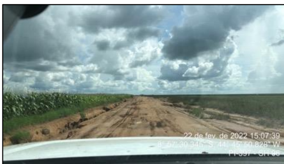
Figura 61 - Bordos da estrada com processo erosivo em fevereiro/22 - SH 06
