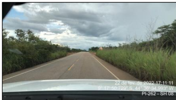
Figura 82 – Sinalização encoberta pela vegetação no segmento 08
