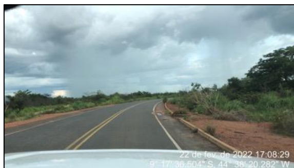
Figura 77 - Buraco no acostamento - SH-08
