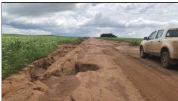
Figura 58 - Bordo da estrada com processo erosivo em janeiro/22 - SH 06
