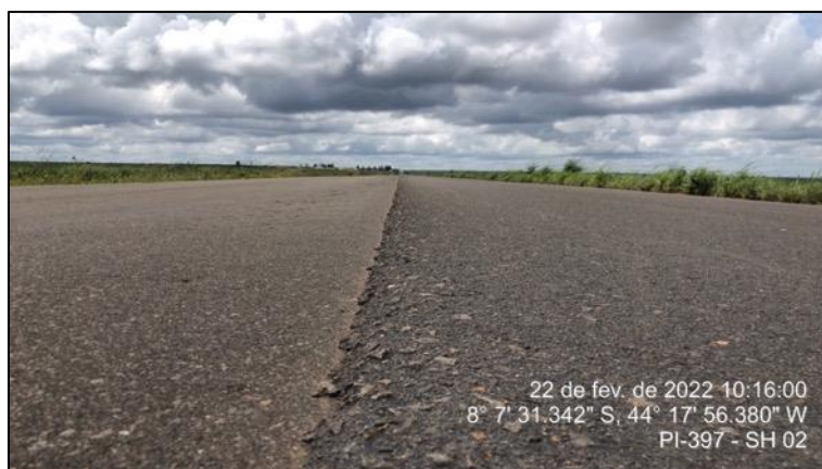
Figura 28 - Desnível entre faixas contíguas no SH 02
