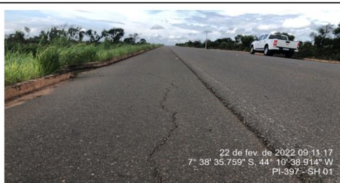
Fissuras no revestimento do acostamento.
