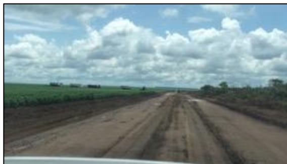
Figura 45 - Ponto com acúmulo de água - SH 04
