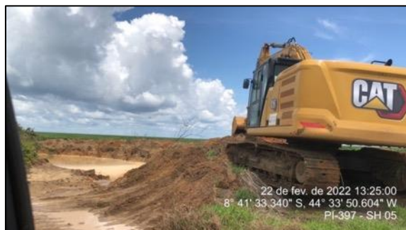
Figura 51 - Poço de Drenagem com capacidade esgotada - SH 05
