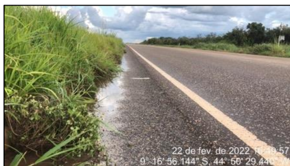
Figura 88 - Acúmulo de água devido a obstrução da drenagem pela vegetação - SH-08
