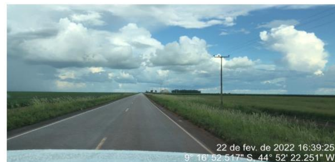
Sinalização horizontal danificada, precisando de reparos.
