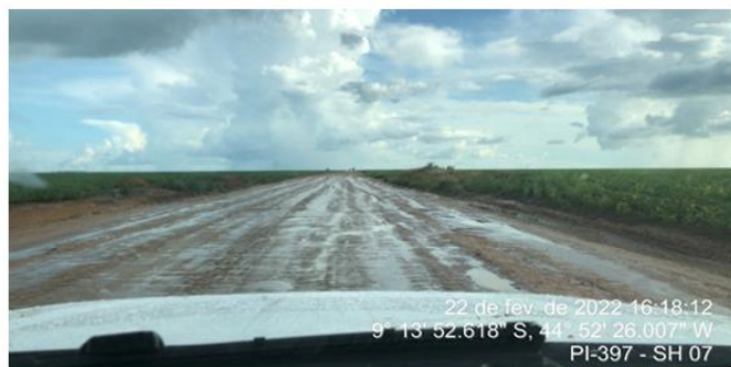
Solo saturado causando instabilidade nos veículos que trafega no segmento.
