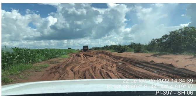
Atoleiro na pista. Acesso irregular para veículos.
