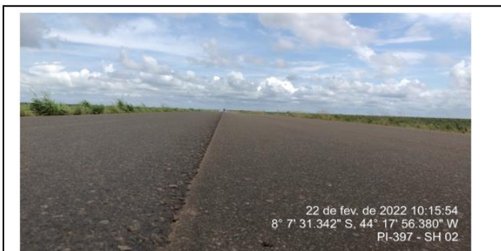
Diferença de nível no pavimento da faixa de rolamento para o acostamento.
