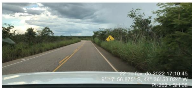
Vegetação alta cobrindo a sinalização vertical da pista.
