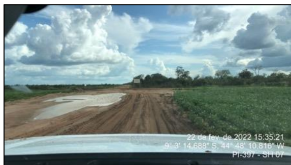
Figura 64 - Ponto de acúmulo de água - SH 07
