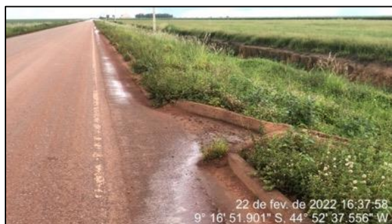
Figura 85 - Drenagem obstruída por acúmulo de sedimentos - SH-08
