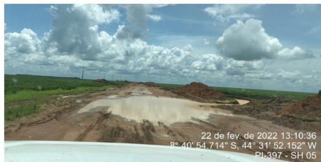
Buraco de grande proporção comprometendo a pista. Poço de drenagem transbordando.
