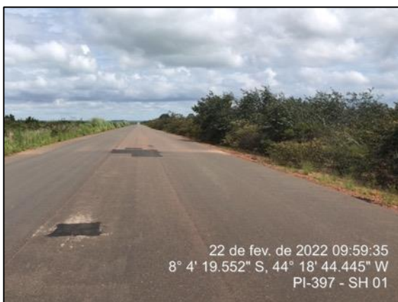
Figura 19 - Buraco nas proximidades do km 66, situação em fevereiro/22
