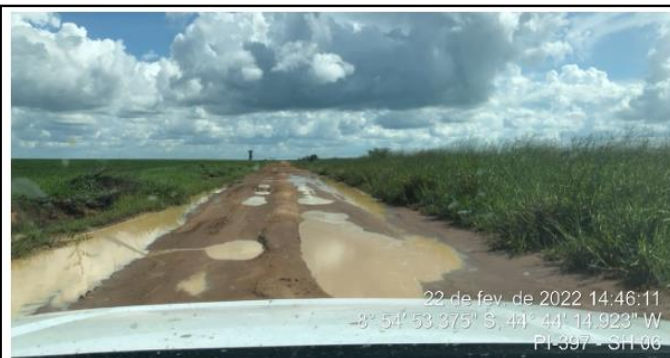
Alagamento nos dois lados da pista.
