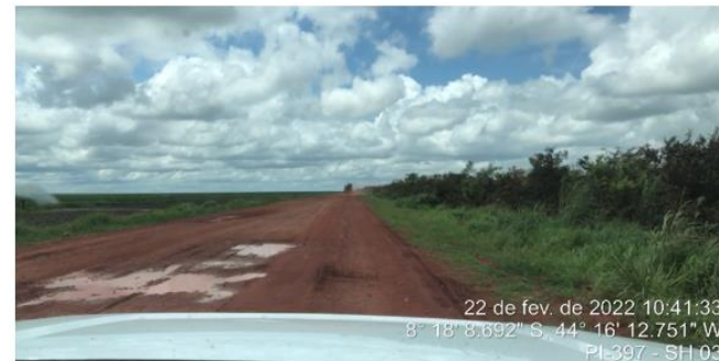
Buraco comprometendo um dos lados da pista.
