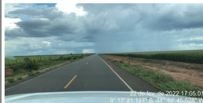
Deformação no pavimento em um dos bordos da pista.
