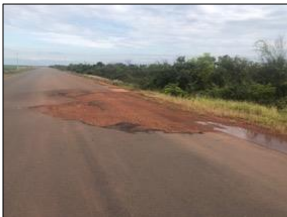
Figura 16 - Buraco nas proximidades do km 52, situação em janeiro/22
