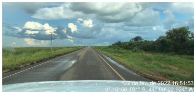
Acúmulo de água no leito da pista.
