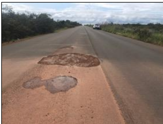
Figura 17 - Buraco nas proximidades do km 66, situação em janeiro/22
