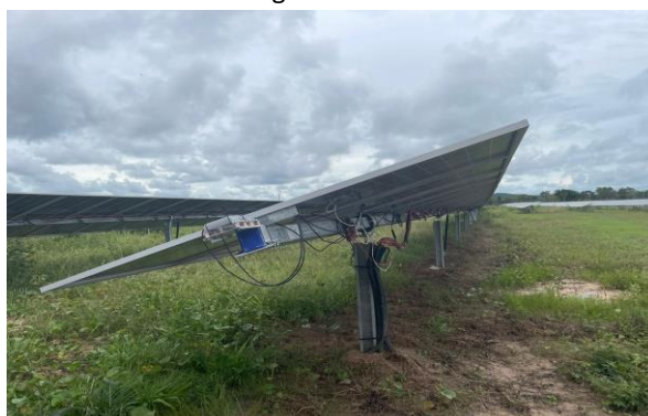
Figura 13 - Painel em funcionamento com termostato para controle da temperatura e cabos que levam a energia ao inversor
