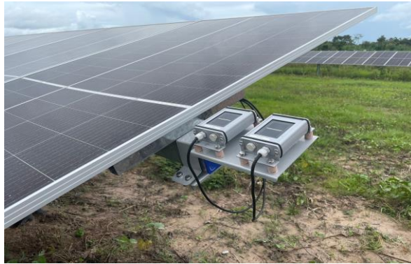
Figura 14 - Estrutura para acompanhar a necessidade de limpeza das placas
