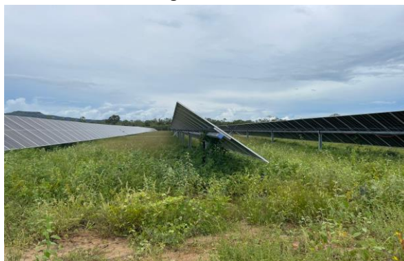
Figura 14 - Painel em funcionamento com termostato para controle da temperatura e cabos que levam a energia ao inversor
