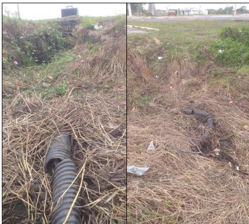
Figura 14. Estado de conservação em que se encontravam os eletrodutos
