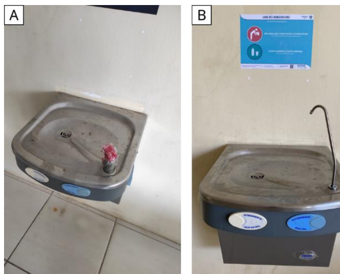
Figura 24. Estado de conservação dos bebedouros antes (A) e depois (B) dos serviços de manutenção.
