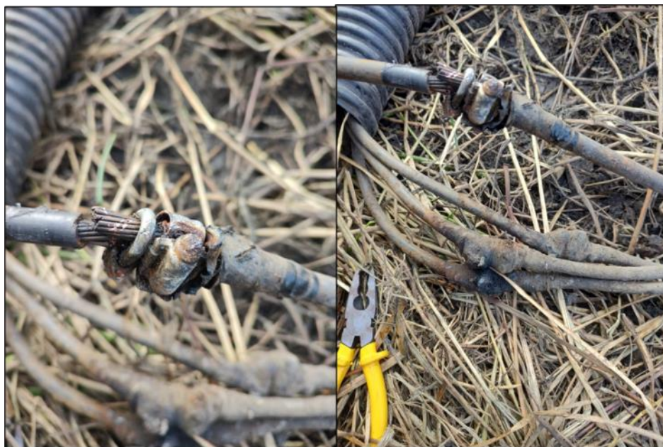
Figura 15. Fonte do problema com a alimentação do aeródromo
