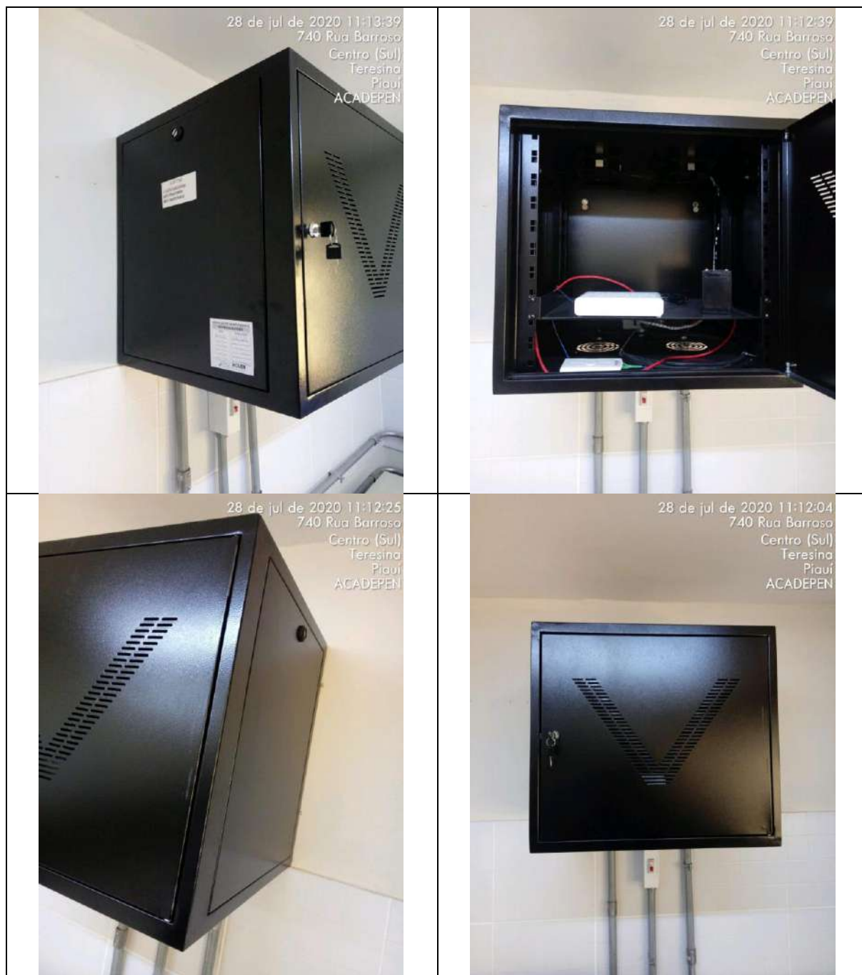
Figura 207 – PAG TV ACADEPEN: NÃO CONFORME – Ausência de adesivo com contato para suporte – Teresina
