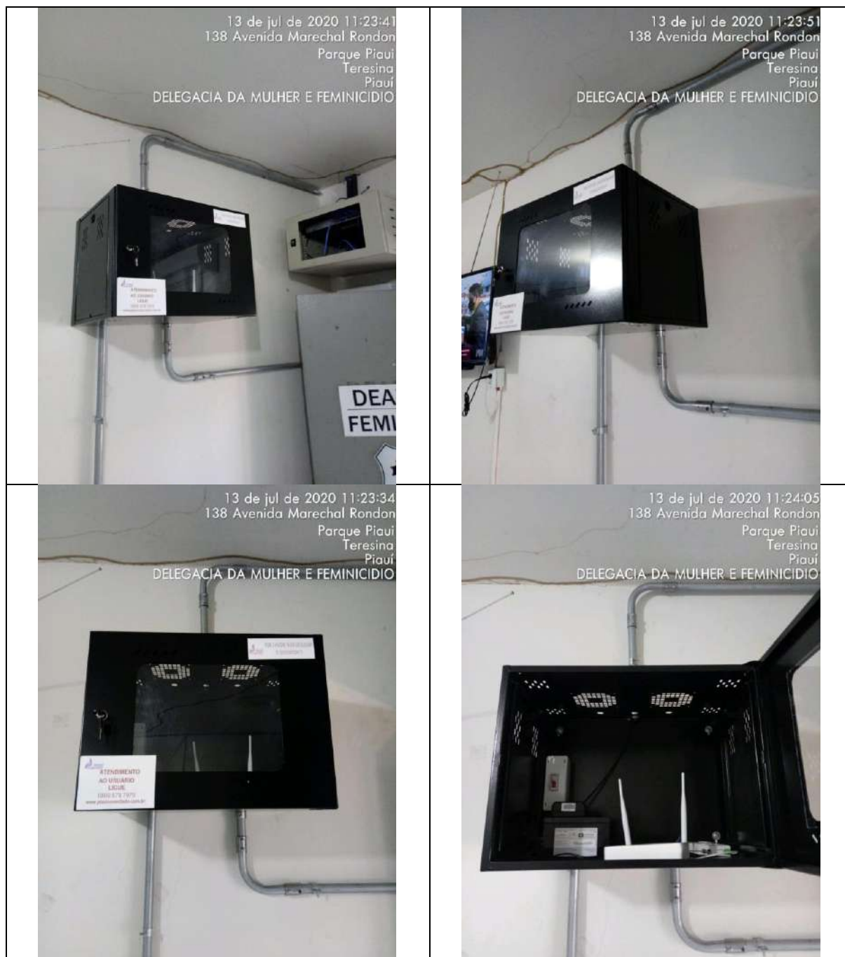
Figura 189 – PAG Delegacia da Mulher e Feminicídio: NÃO CONFORME – Ausência de adesivo com identificação do Rack – Teresina
