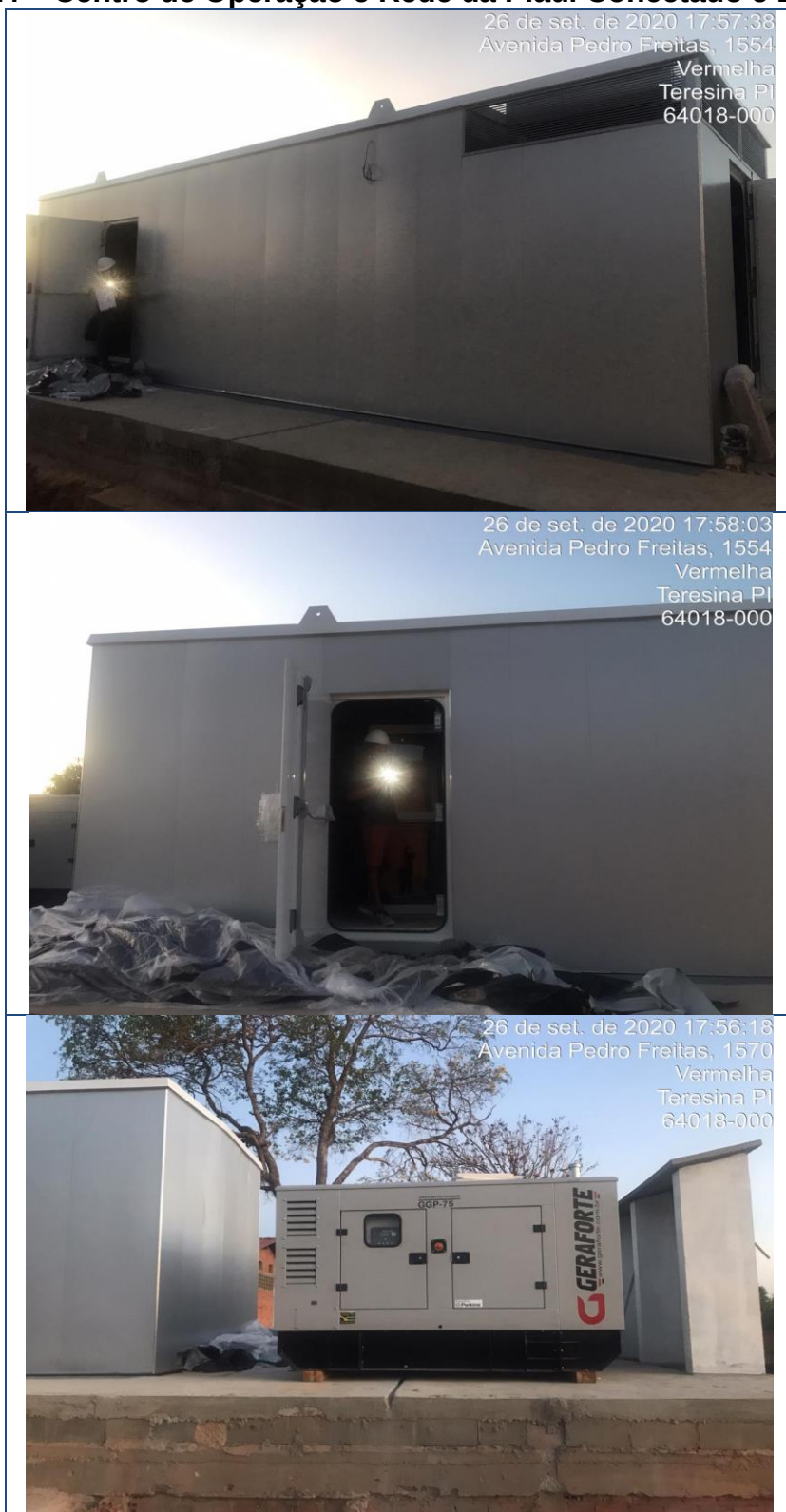
Figura 114 – Centro de Operação e Rede da Piauí Conectado e Datacenter
