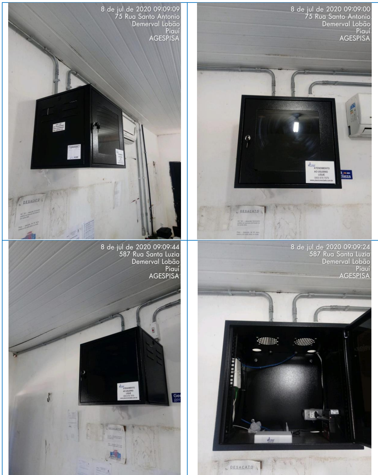
Figura 72 – Registro de inspeção de não conformidades nas instalações das unidades com internet no mês de julho/2020
