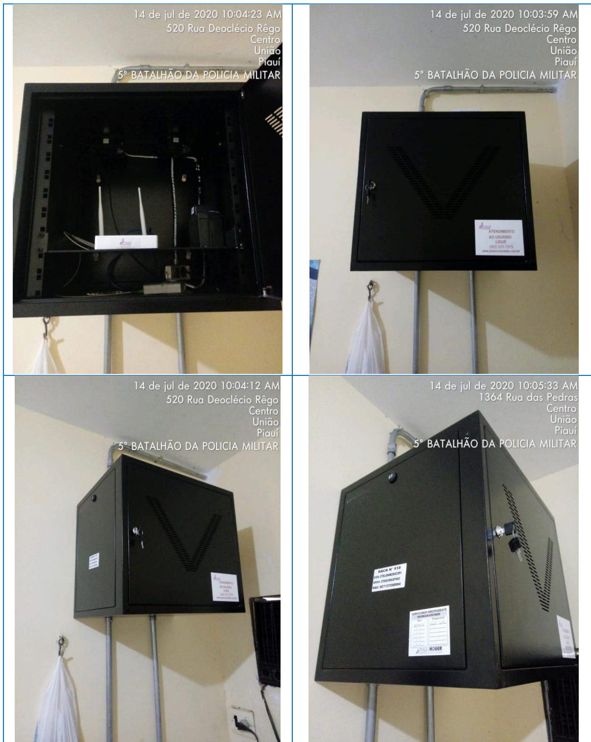
Figura 80 – Registro de inspeção de não conformidades na manutenção e conservação das unidades com internet no mês de julho/2020
