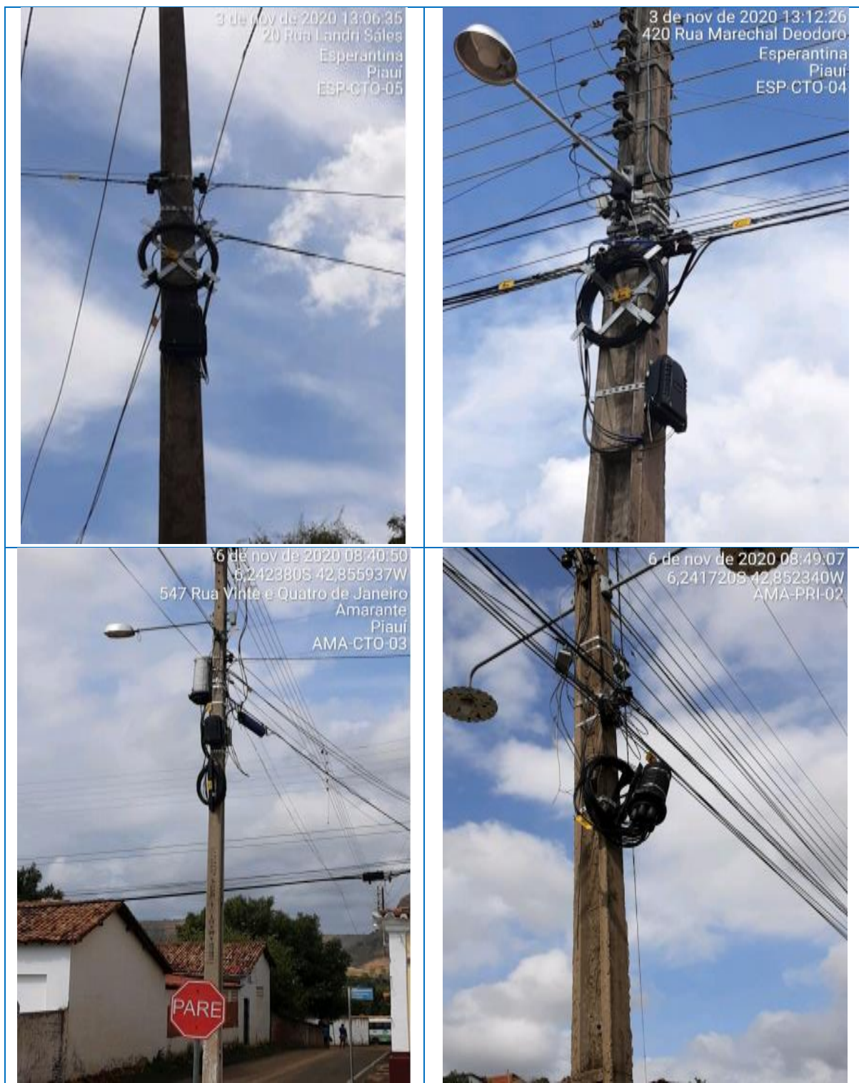
Figura 57 – Inspeção de não conformidades no lançamento da fibra óptica no mês de novembro/2020
