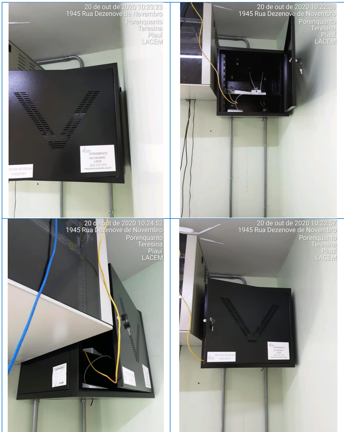
Figura 83 – Registro de inspeção de não conformidades na manutenção e conservação das unidades com internet no mês de outubro/2020
