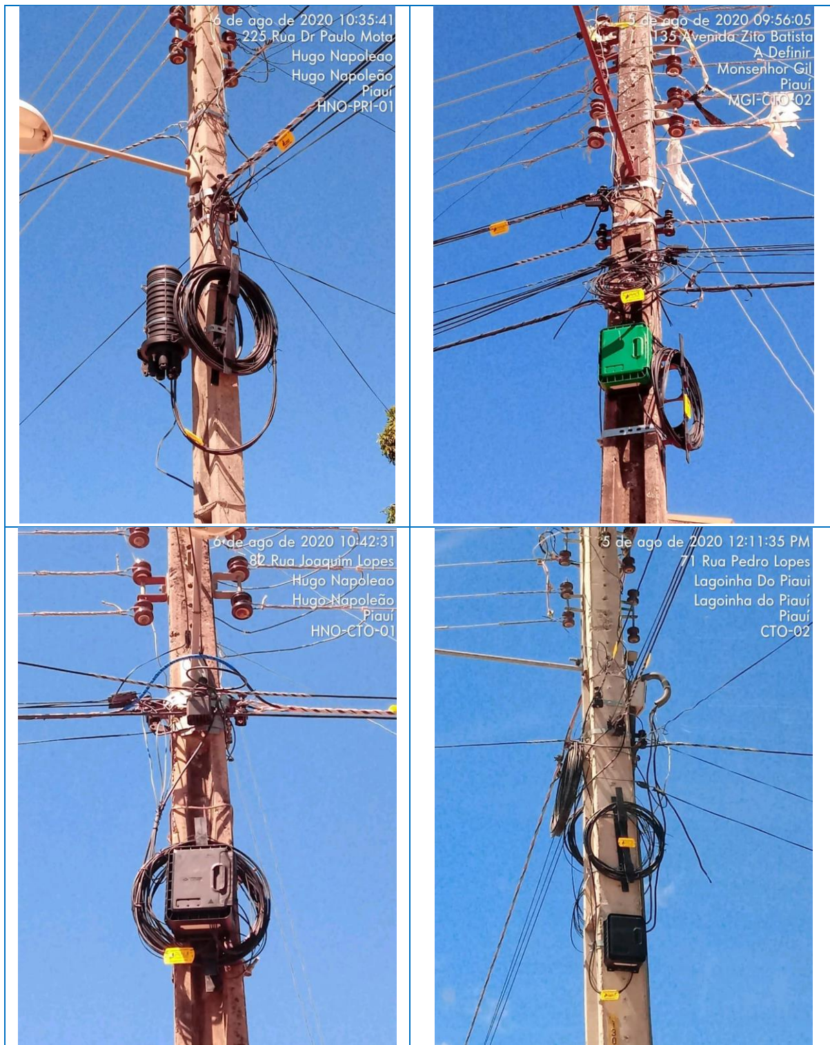
Figura 48 – Inspeção de não conformidades no lançamento da fibra óptica no mês de agosto/2020
