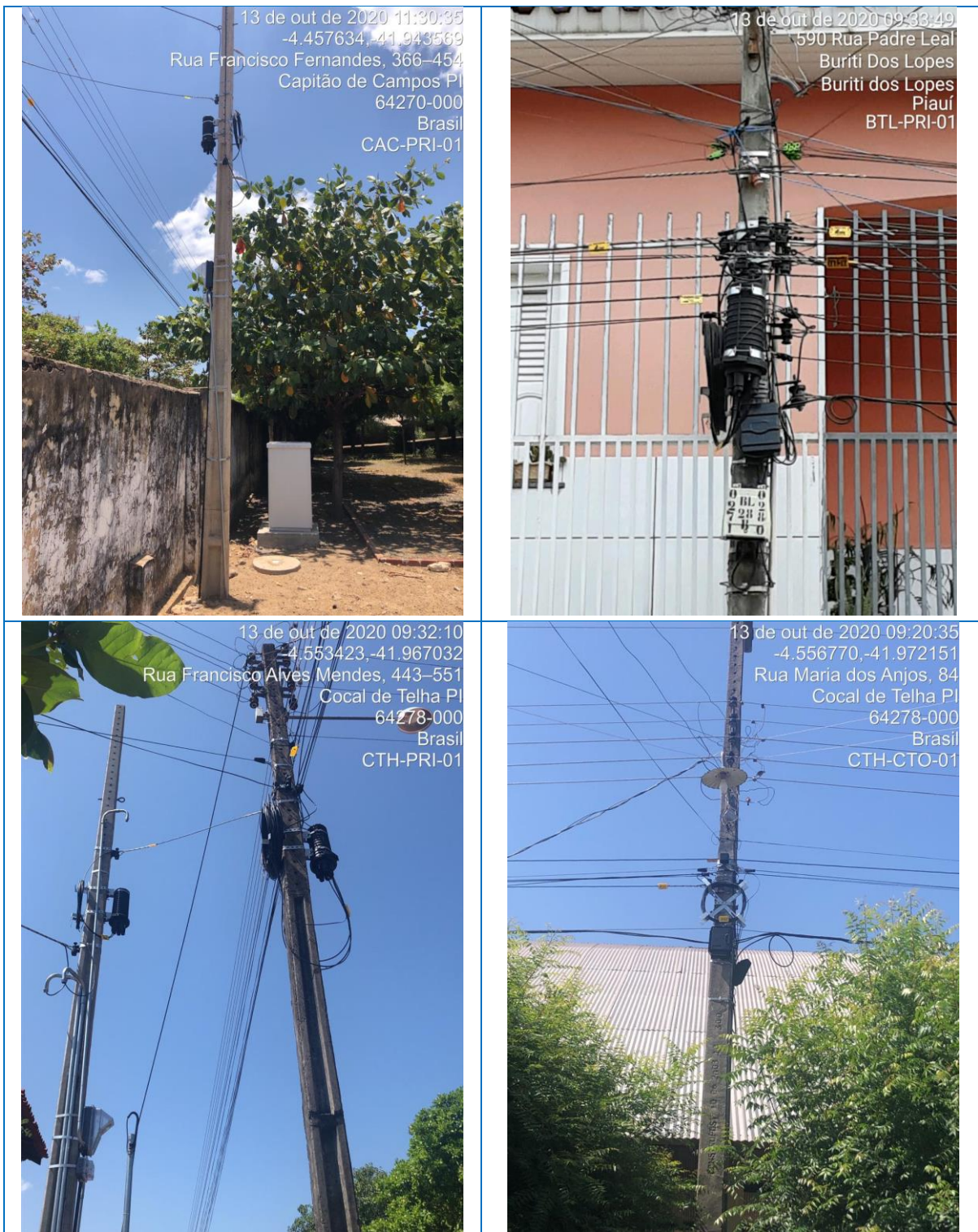
Figura 50 – Inspeção de não conformidades no lançamento da fibra óptica no mês de outubro/2020
