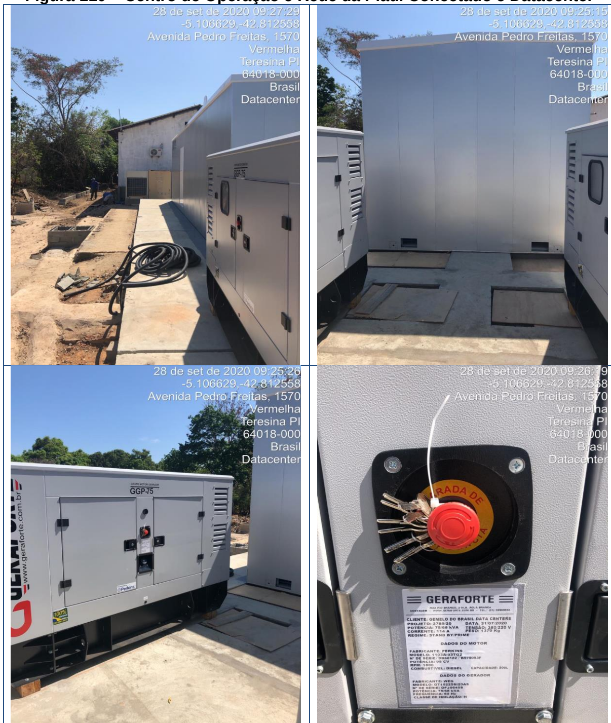
Figura 110 – Centro de Operação e Rede da Piauí Conectado e Datacenter
