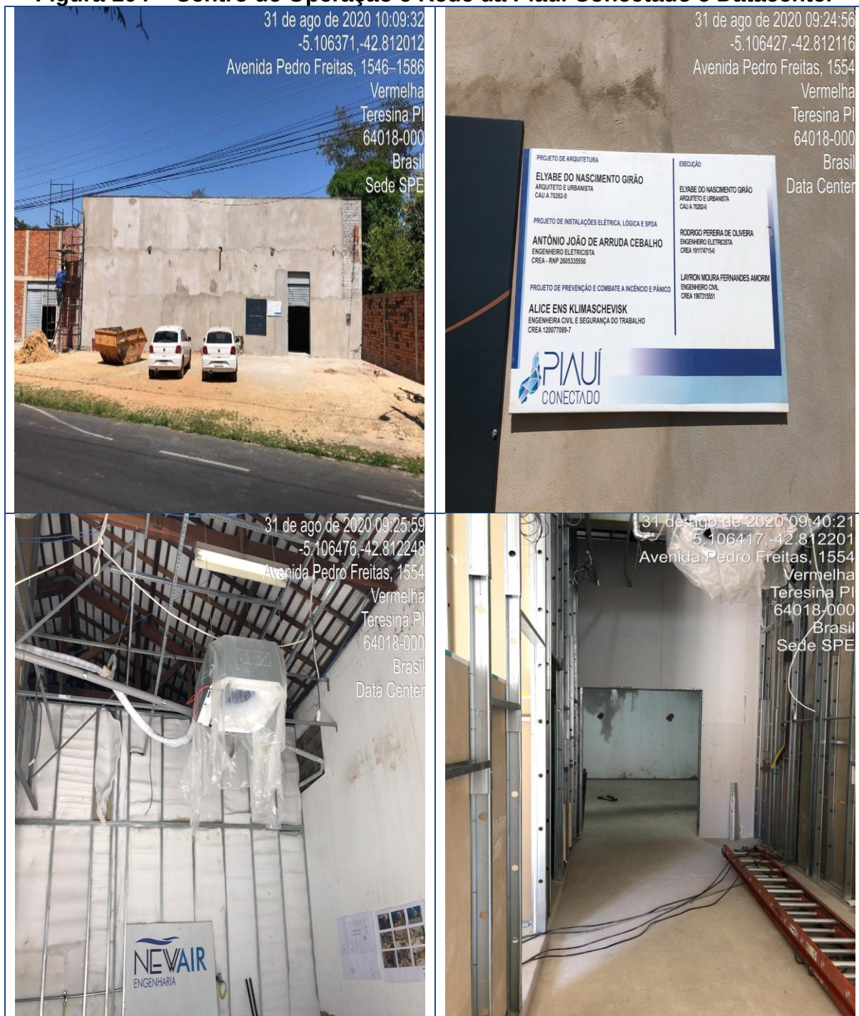
Figura 104 – Centro de Operação e Rede da Piauí Conectado e Datacenter
