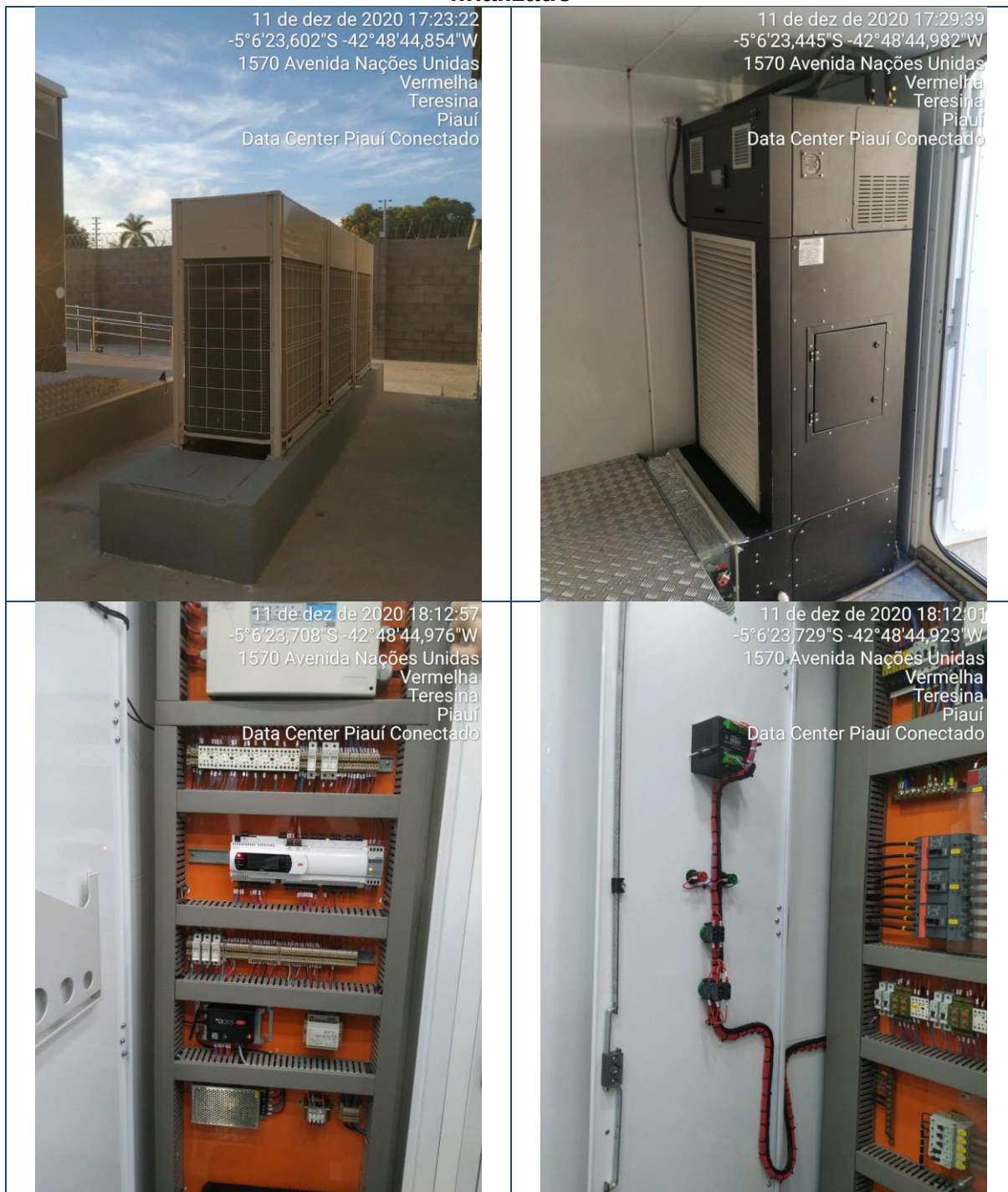
Figura 122 – Centro de Operação e Rede da Piauí Conectado e Datacenter finalizado
