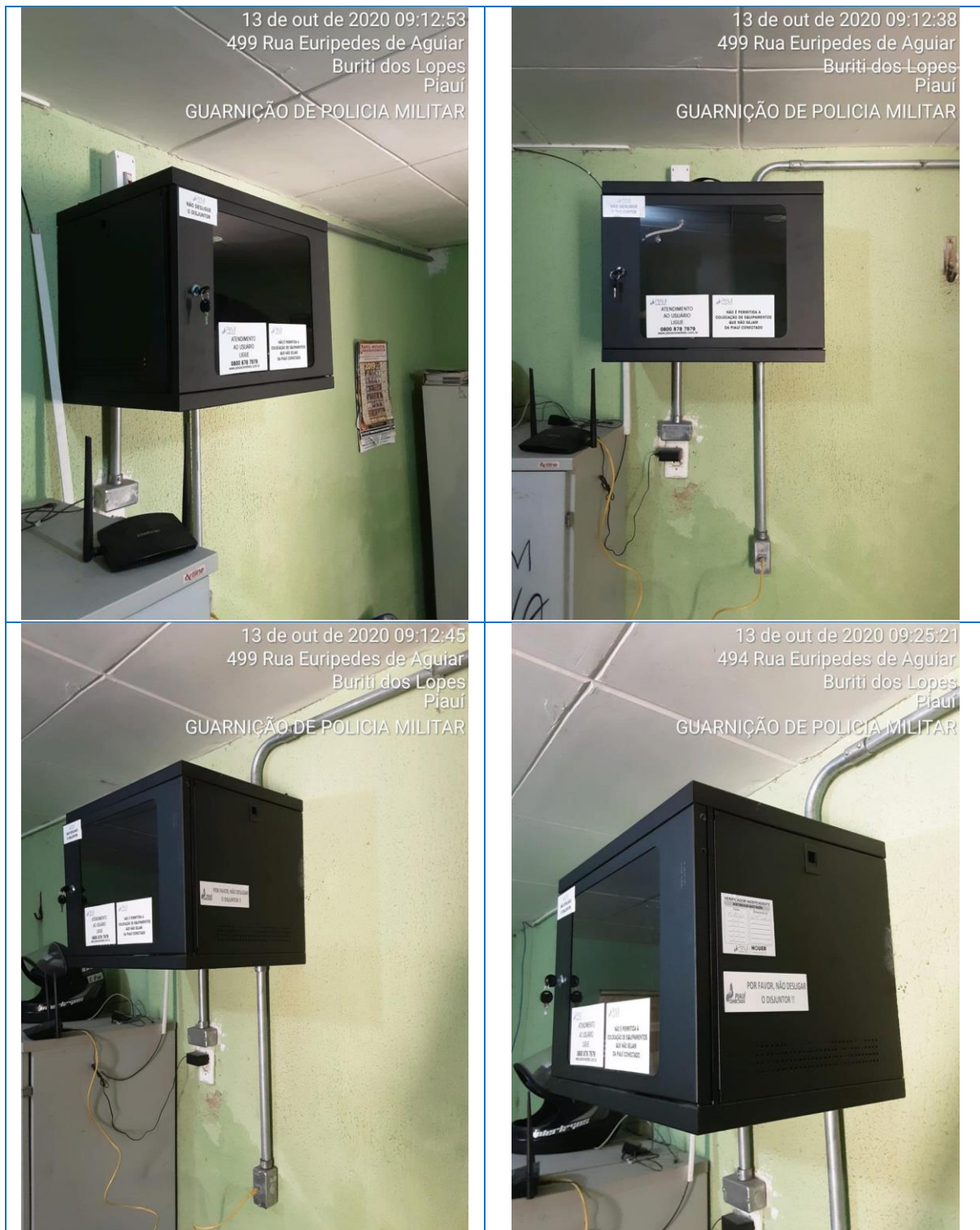
Figura 75 – Registro de inspeção de não conformidades nas instalações das unidades com internet no mês de outubro/2020
