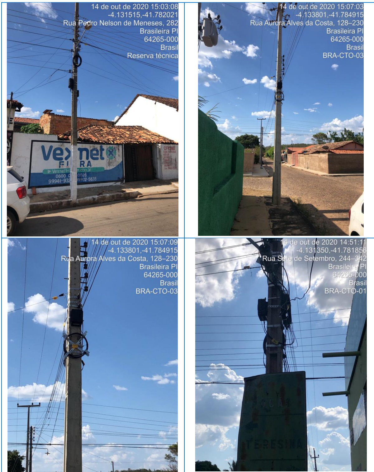
Figura 56 – Inspeção de não conformidades no lançamento da fibra óptica no mês de outubro/2020
