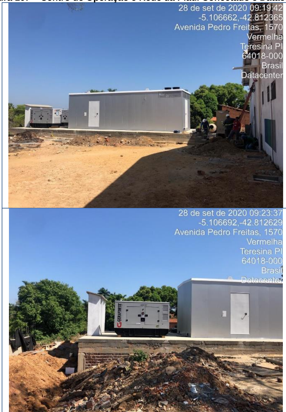
Figura 107 – Centro de Operação e Rede da Piauí Conectado e Datacenter
