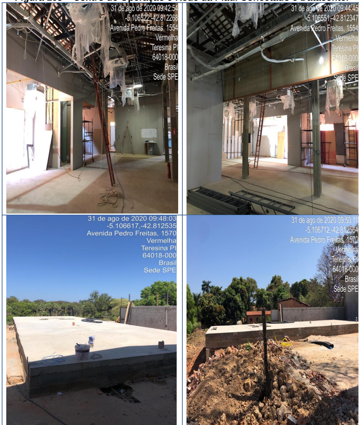
Figura 105 – Centro de Operação e Rede da Piauí Conectado e Datacenter
