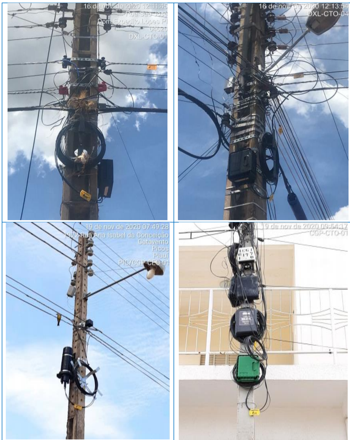
Figura 51 – Inspeção de não conformidades no lançamento da fibra óptica no mês de novembro/2020
