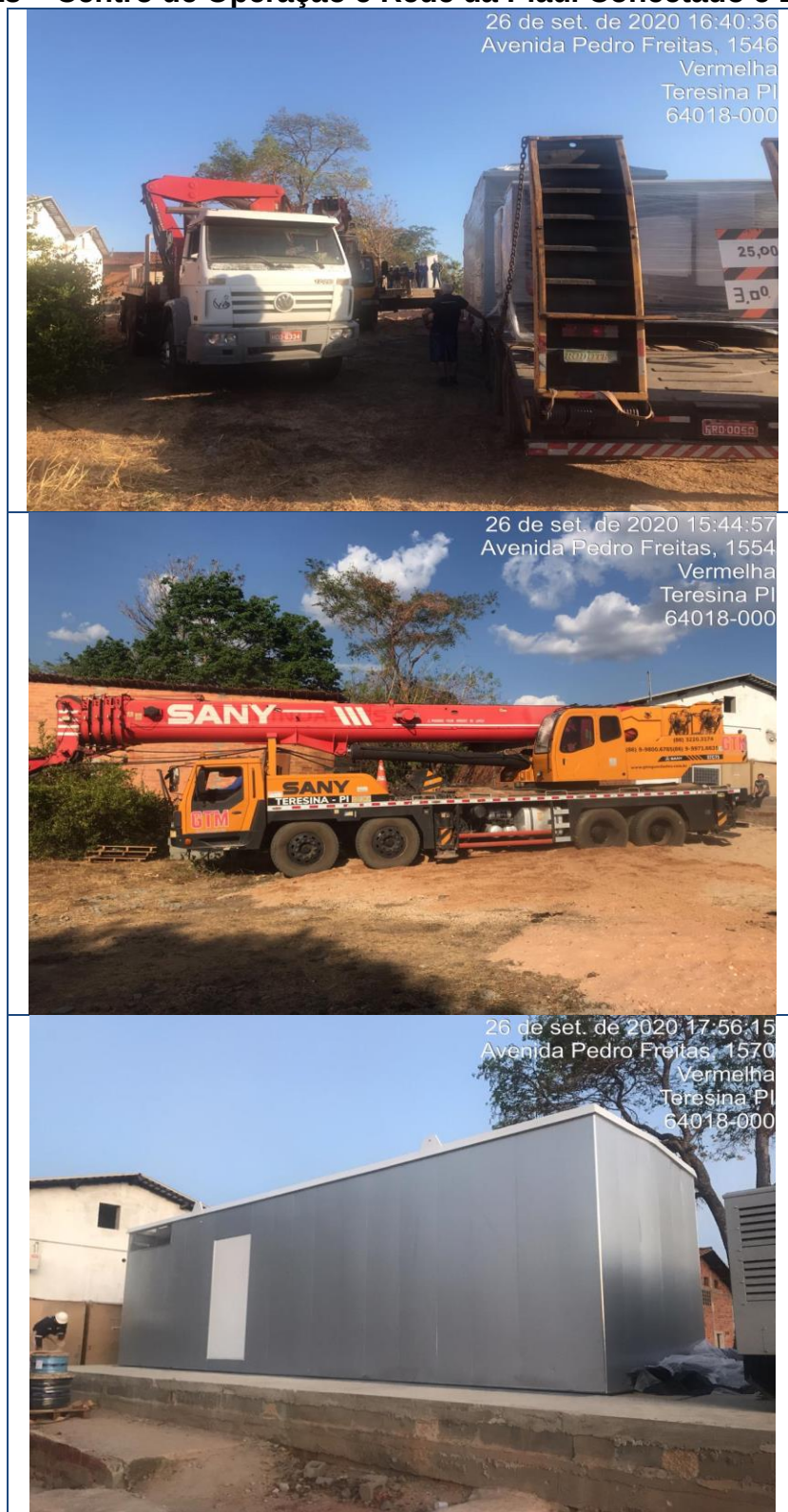
Figura 113 – Centro de Operação e Rede da Piauí Conectado e Datacenter
