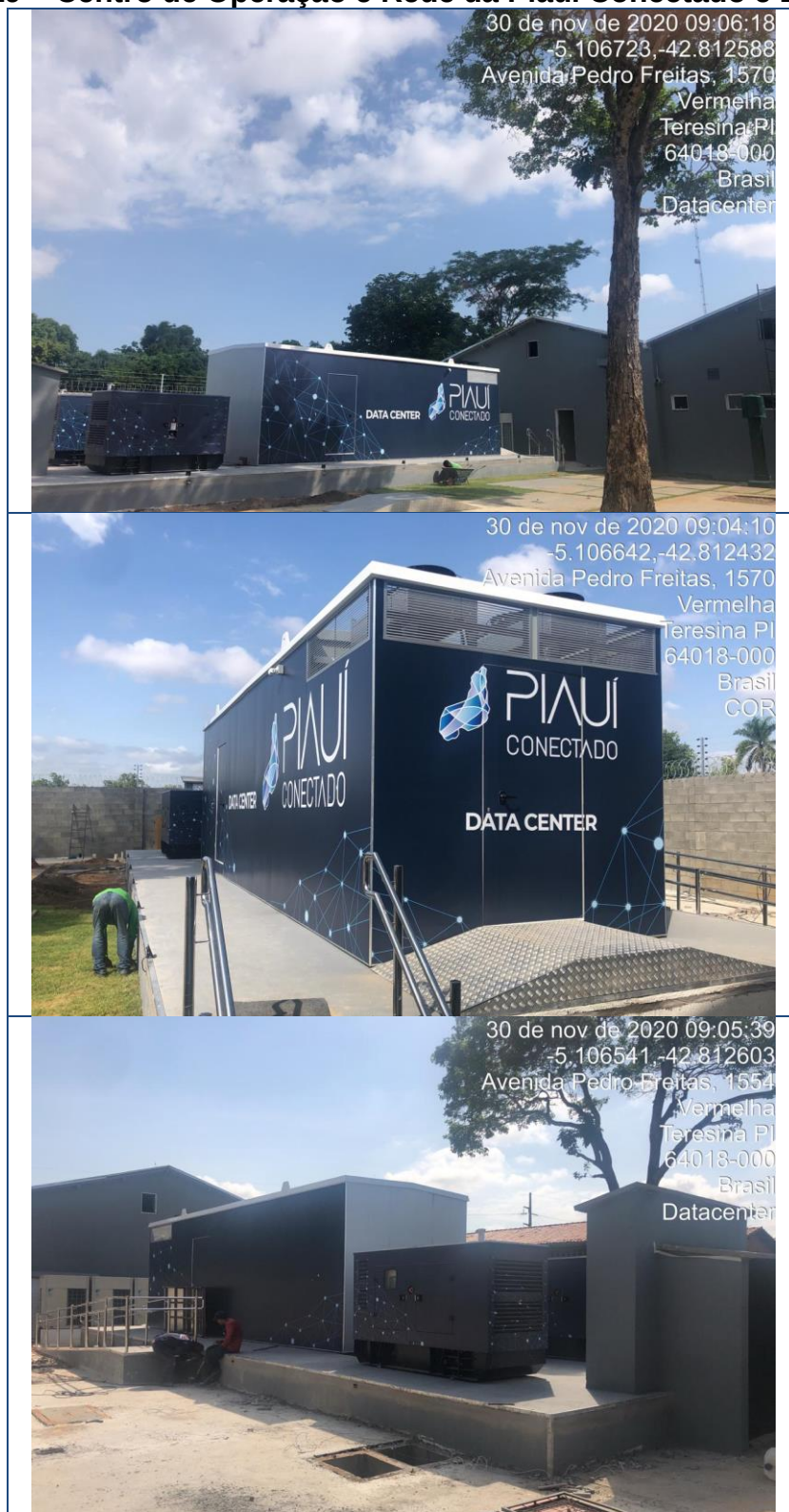
Figura 119 – Centro de Operação e Rede da Piauí Conectado e Datacenter
