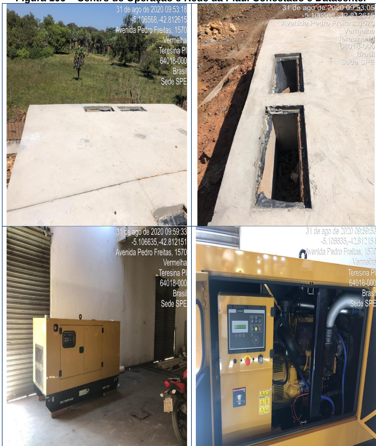
Figura 106 – Centro de Operação e Rede da Piauí Conectado e Datacenter
