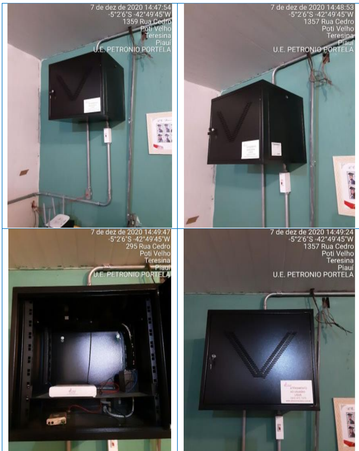
Figura 85 – Registro de inspeção de não conformidades na manutenção e conservação das unidades com internet no mês de dezembro/2020
