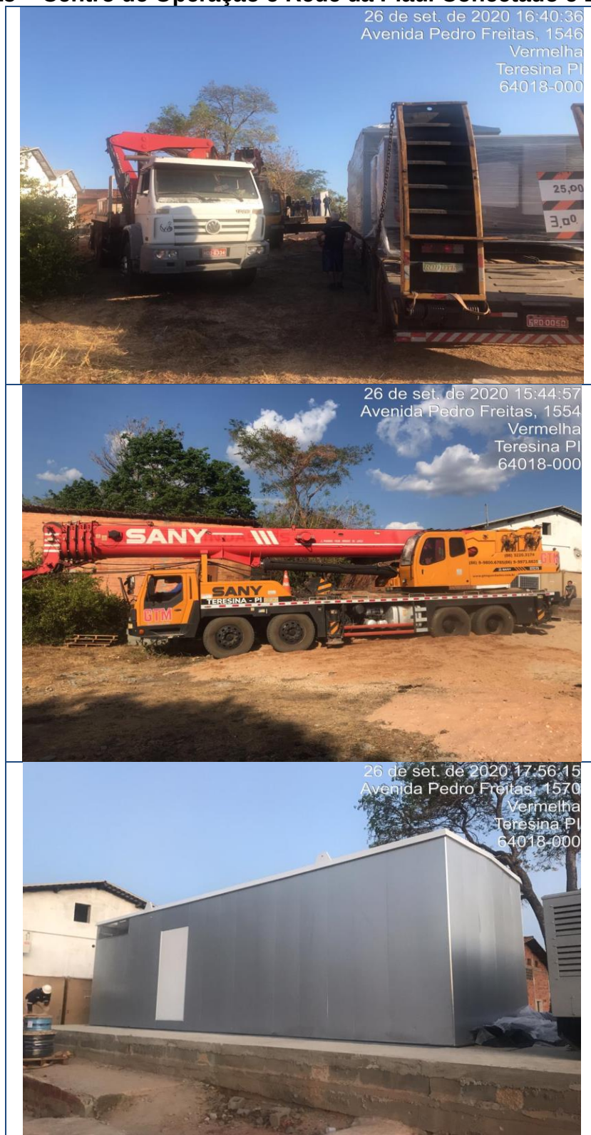
Figura 115 – Centro de Operação e Rede da Piauí Conectado e Datacenter
