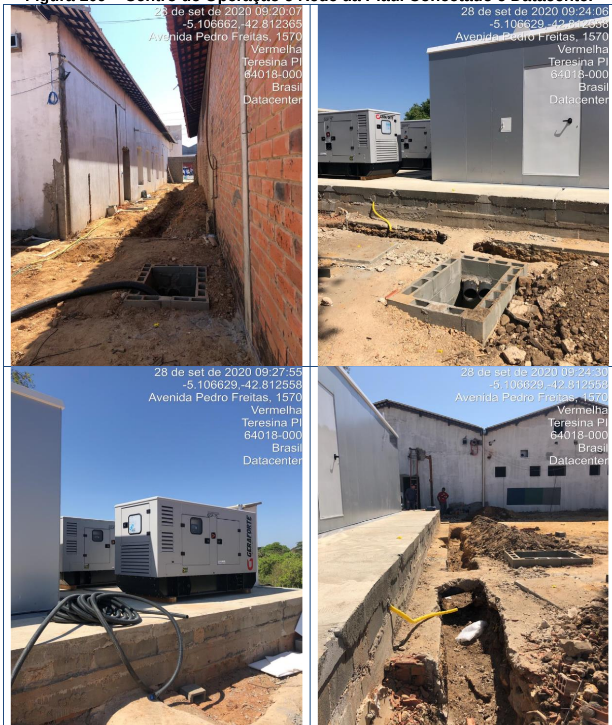
Figura 109 – Centro de Operação e Rede da Piauí Conectado e Datacenter
