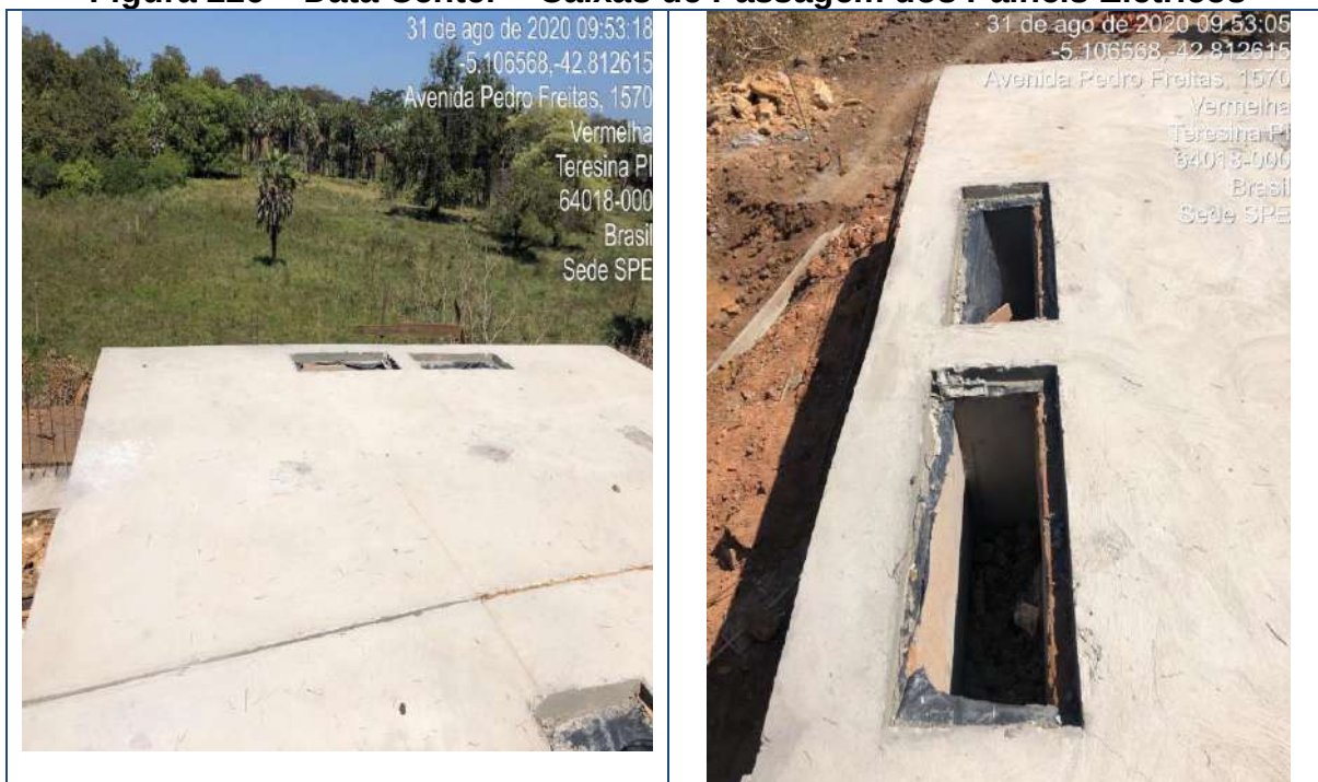
Figura 226 – Data Center – Caixas de Passagem dos Painéis Elétricos
