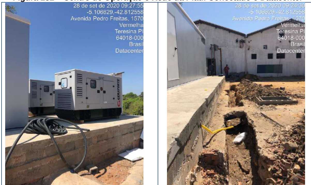
Figura 232 – Centro de Operação e Rede da Piauí Conectado e Datacenter
