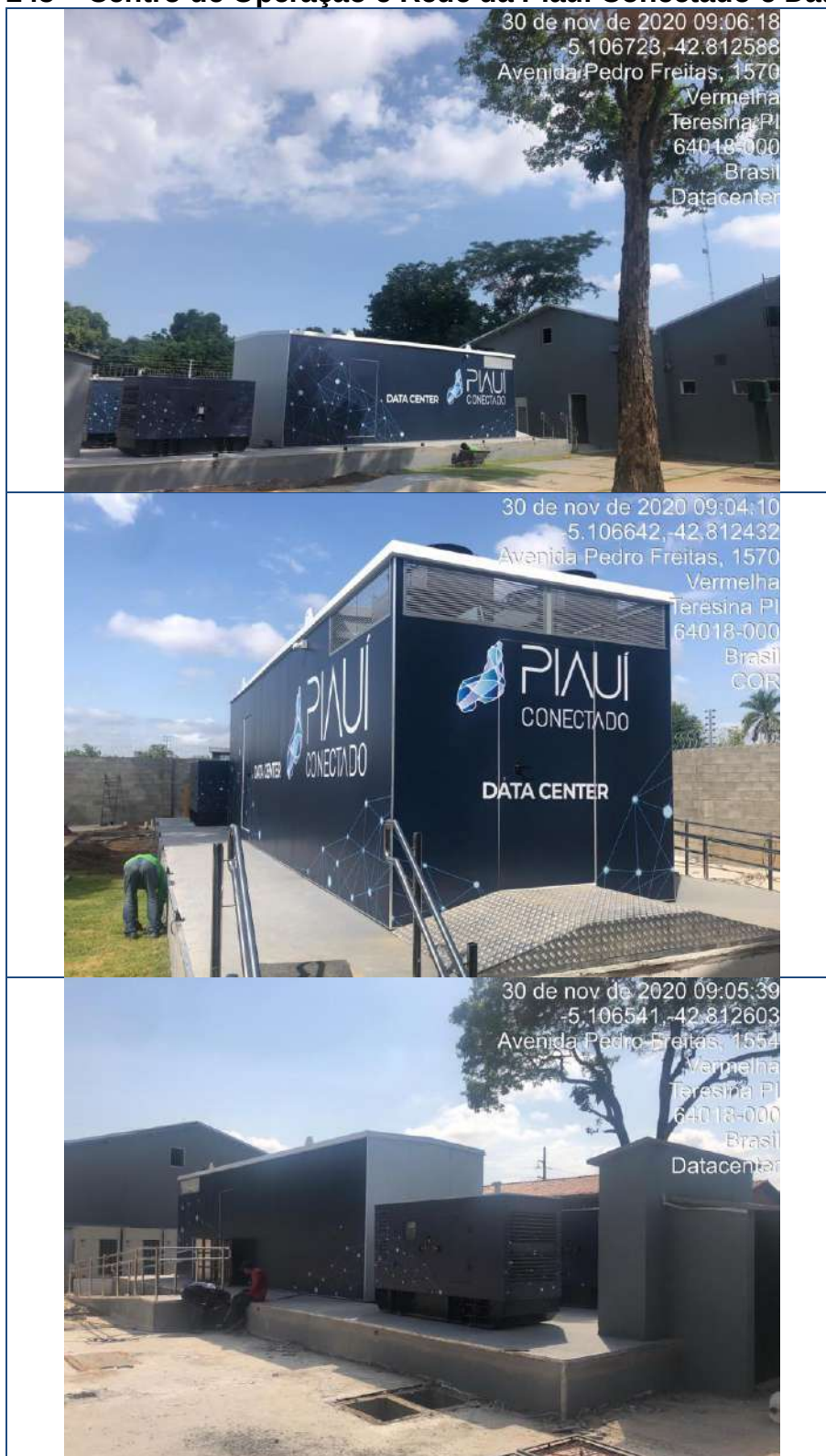
Figura 245 – Centro de Operação e Rede da Piauí Conectado e Datacenter
