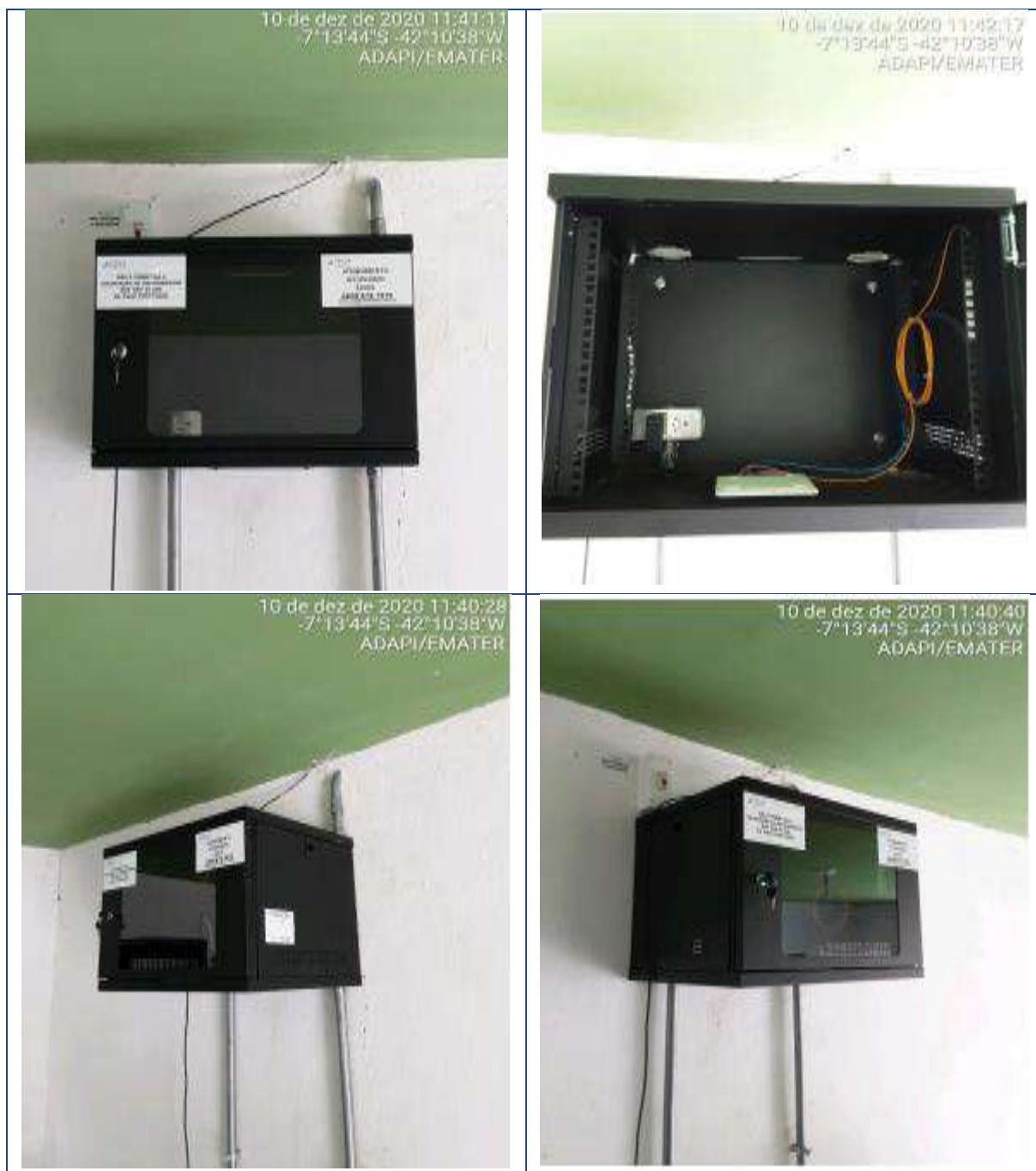
Figura 136 – PAG ADAPI/EMATER: NÃO CONFORME – Ausência de adesivo de identificação do rack - Colônia do Piauí
