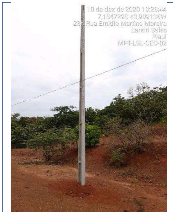
Figura 88 – MPT-LSL-CEO-02 – Altura do lançamento do cabo óptico não conforme – Marcos parente/ Landri Sales
