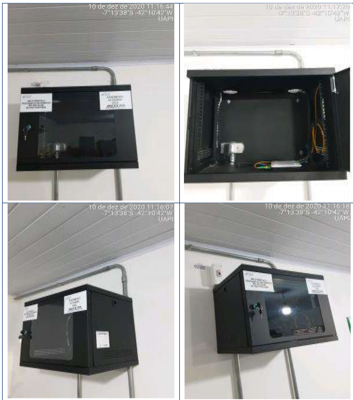
Figura 135 – PAG UAPI: NÃO CONFORME – Ausência de adesivo de identificação do rack - Colônia do Piauí
