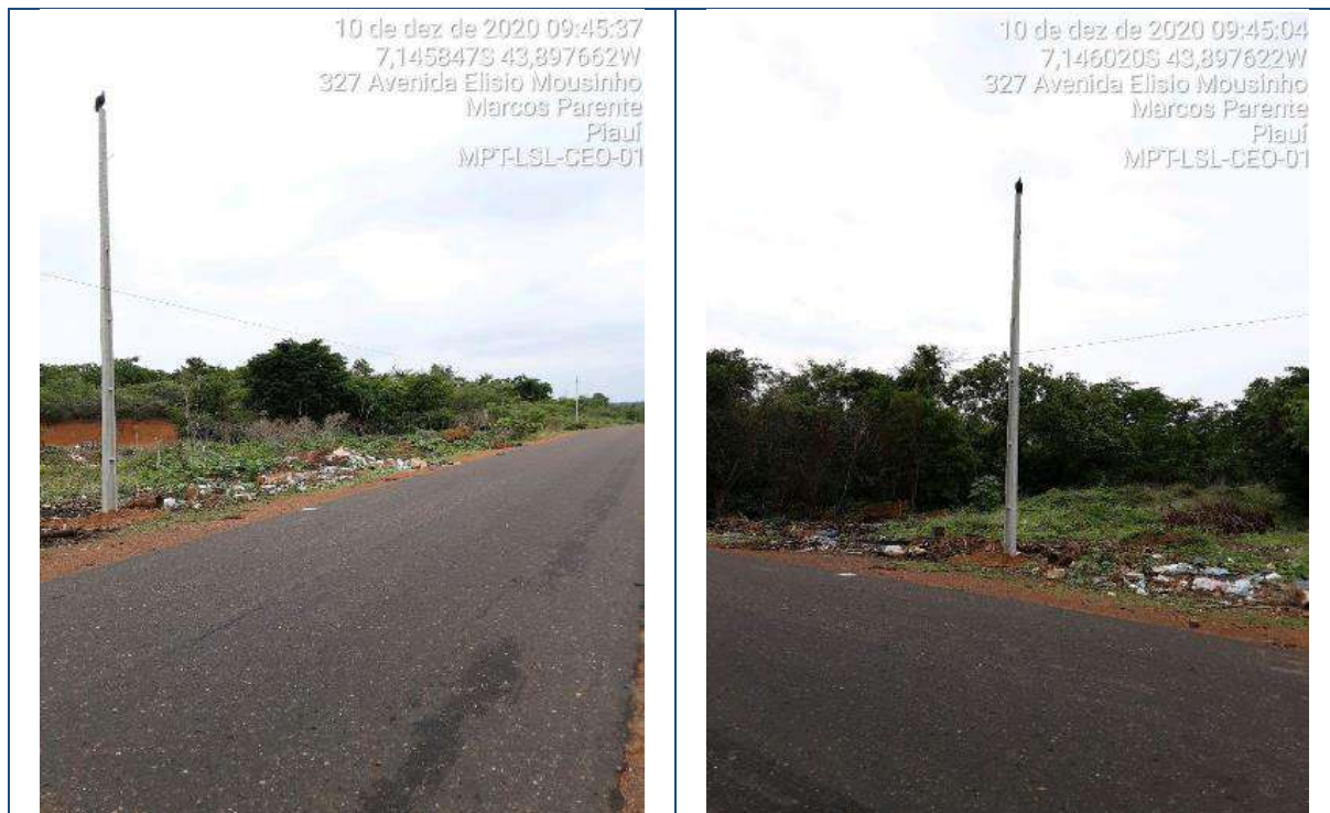
Figura 87 – MPT-LSL-CEO-01 – Suporte universal de ancoragem aplicado incorretamente – Marcos parente/ Landri Sales
