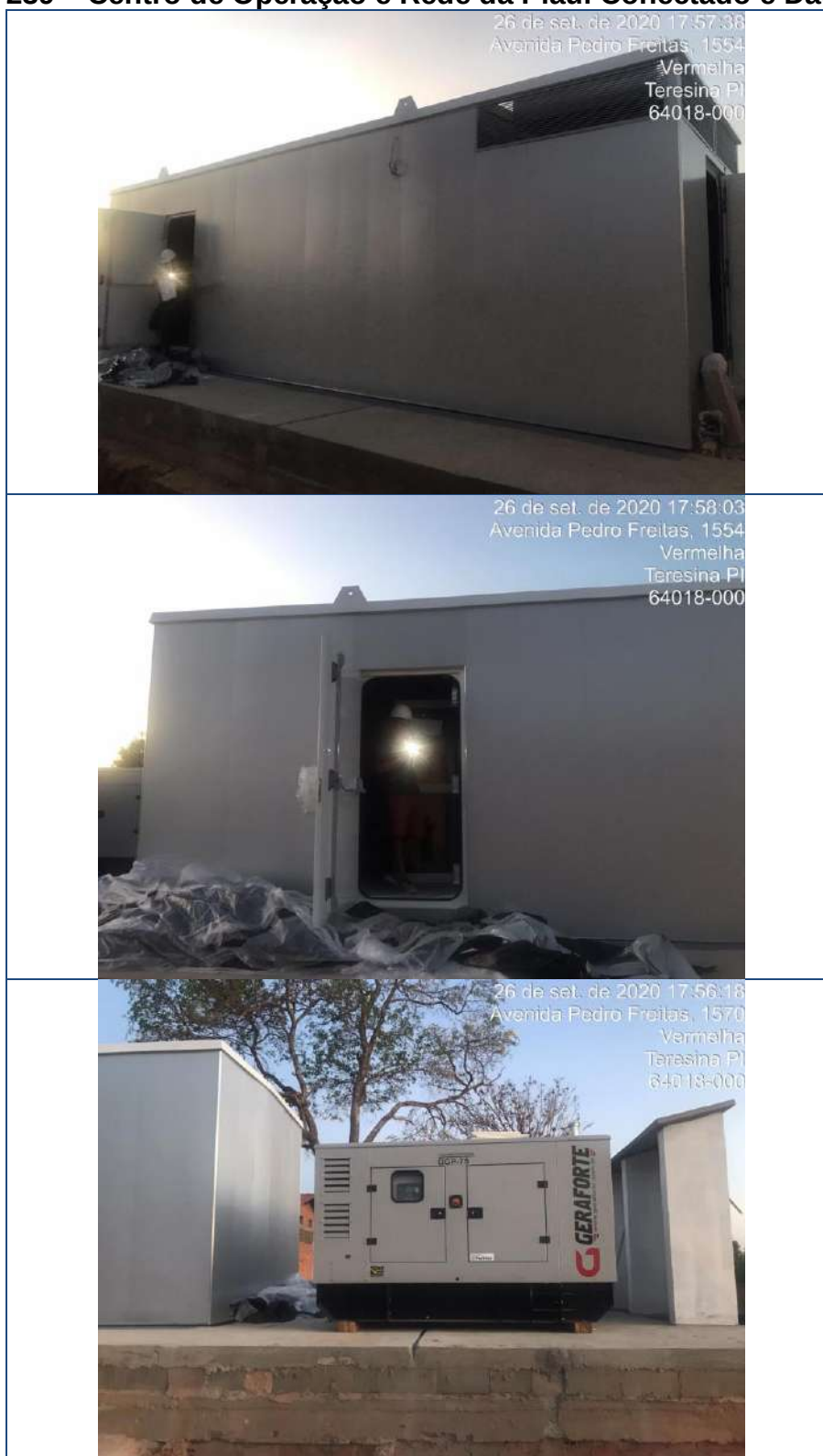
Figura 239 – Centro de Operação e Rede da Piauí Conectado e Datacenter
