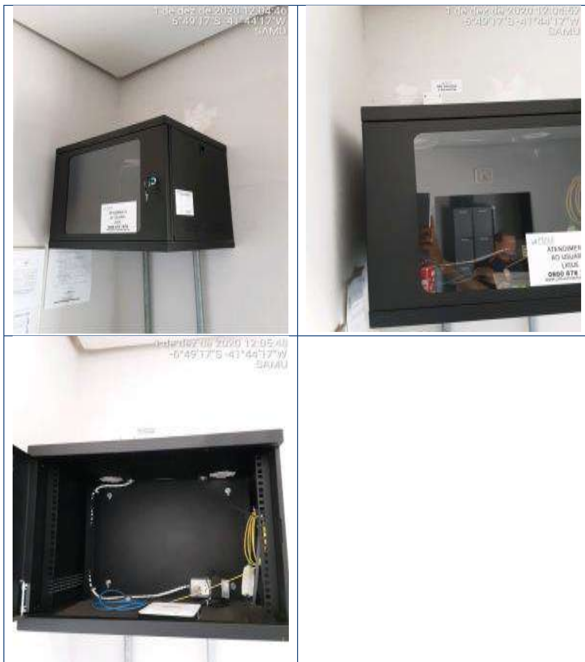
Figura 133 – PAG SAMUI: NÃO CONFORME – Ausência de adesivo de identificação do rack – Ipiranga do Piauí
