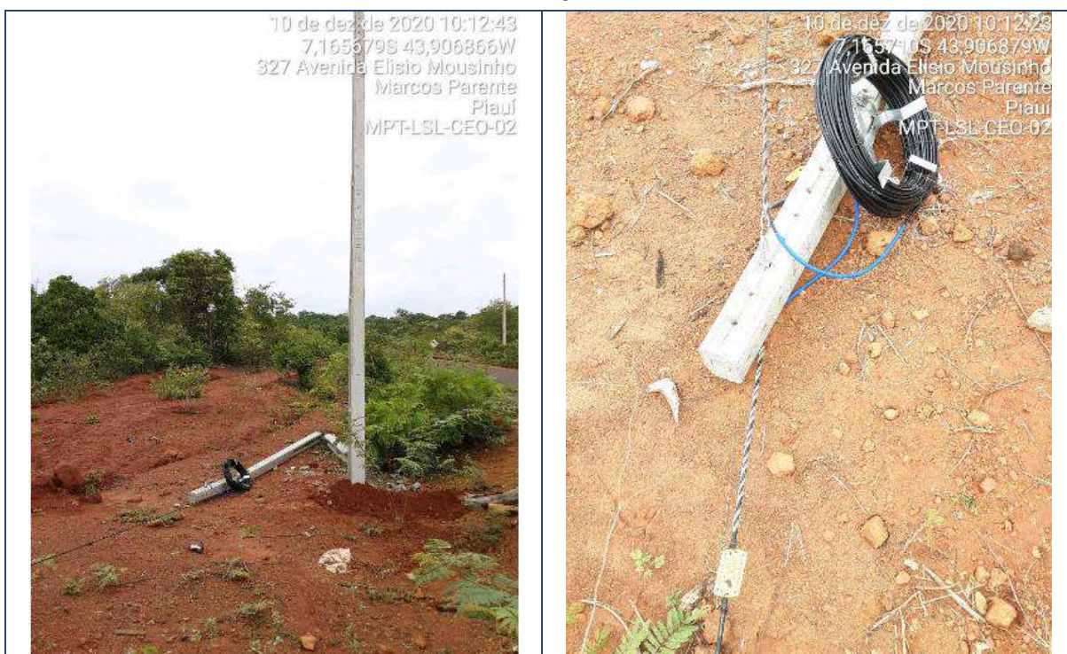
Figura 89 – MPT-LSL-CEO-02– Suporte universal de ancoragem aplicado incorretamente – Marcos parente/ Landri Sales
