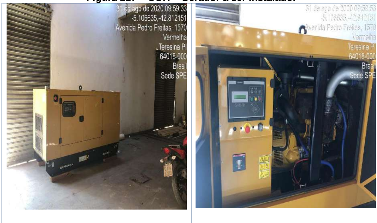
Figura 227 – COR – Gerador a ser instalado.
