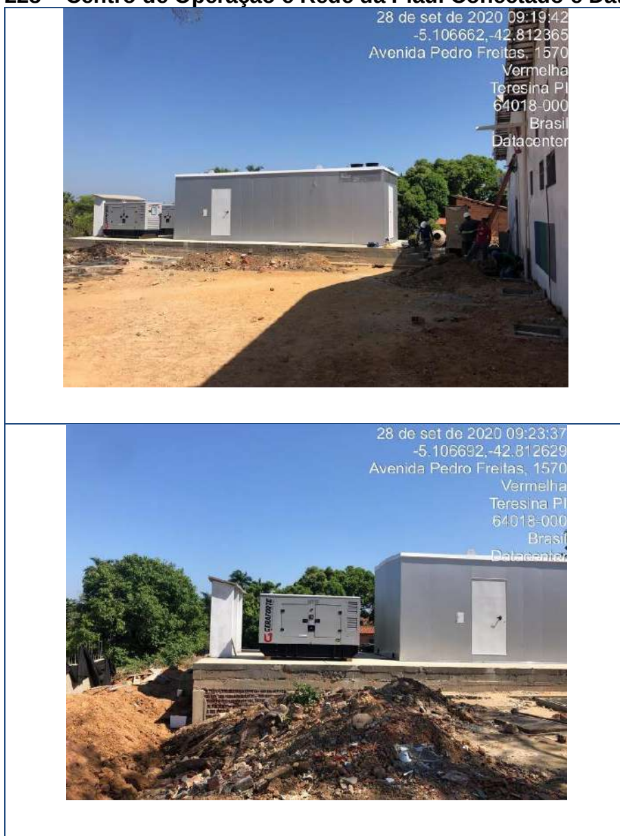
Figura 228 – Centro de Operação e Rede da Piauí Conectado e Datacenter
