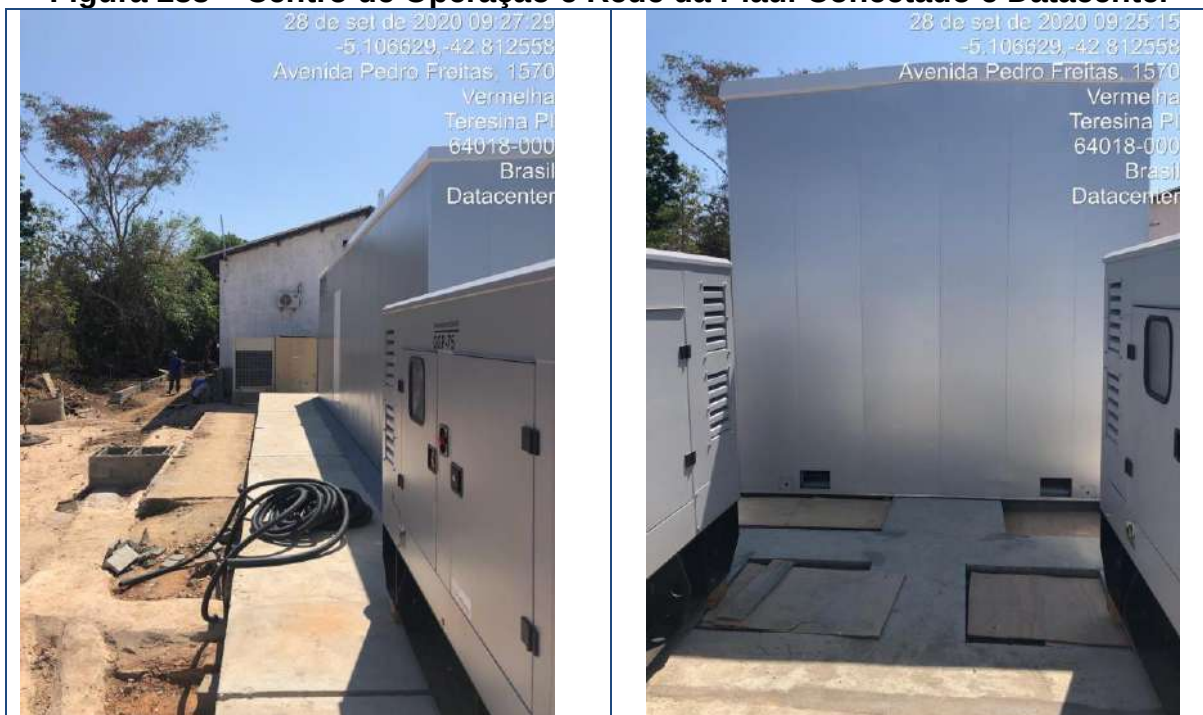
Figura 233 – Centro de Operação e Rede da Piauí Conectado e Datacenter
