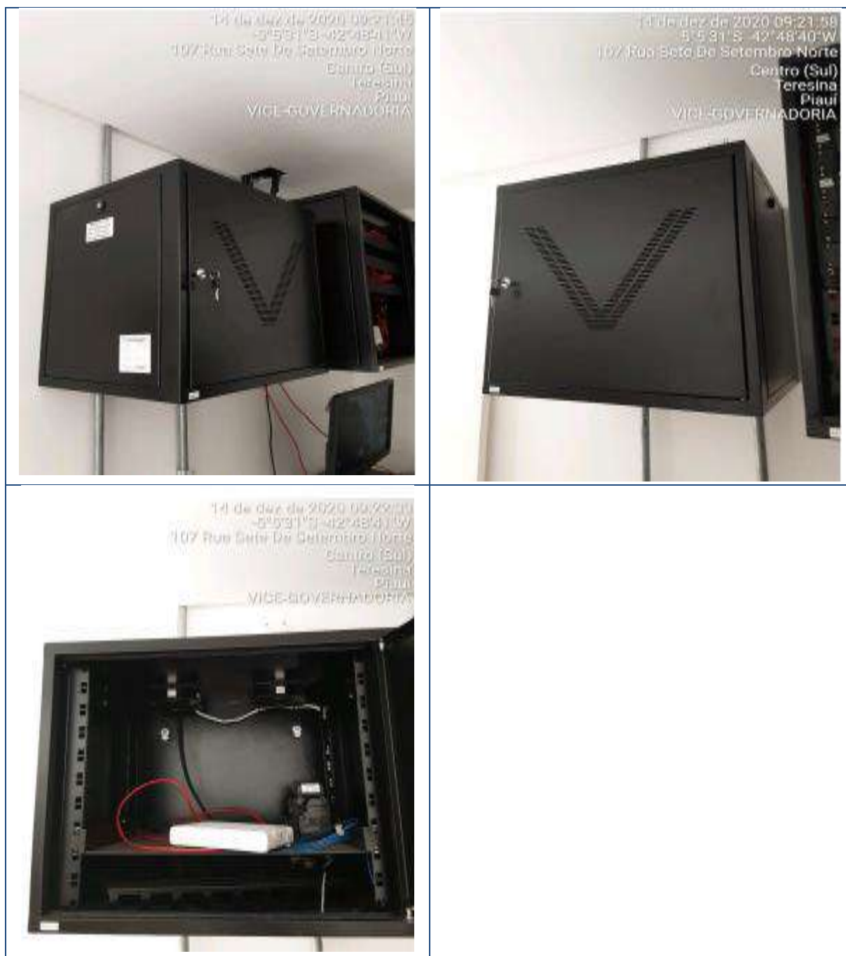
Figura 137 – PAG Vice-Governadoria: NÃO CONFORME – Ausência de contato para suporte no rack - Teresina
