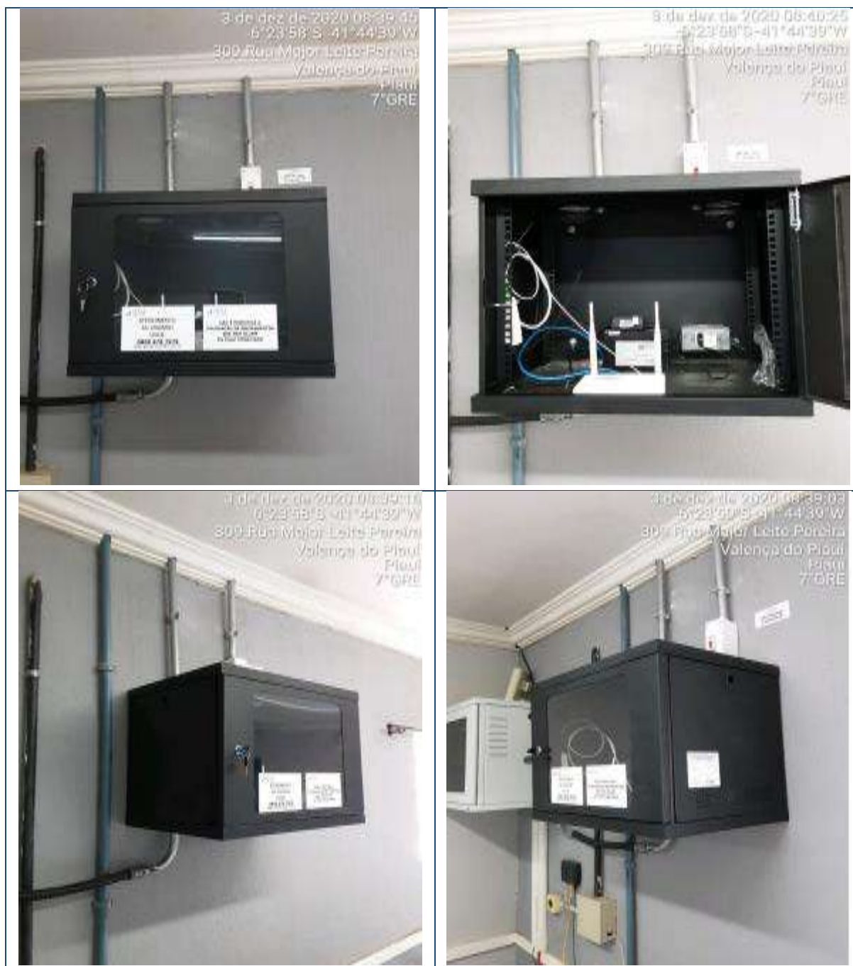
Figura 134 – PAG 7º GRE: NÃO CONFORME – Ausência de adesivo de identificação do rack - Valença
