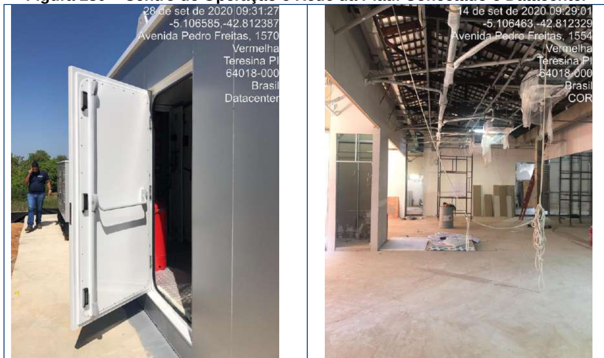
Figura 230 – Centro de Operação e Rede da Piauí Conectado e Datacenter
