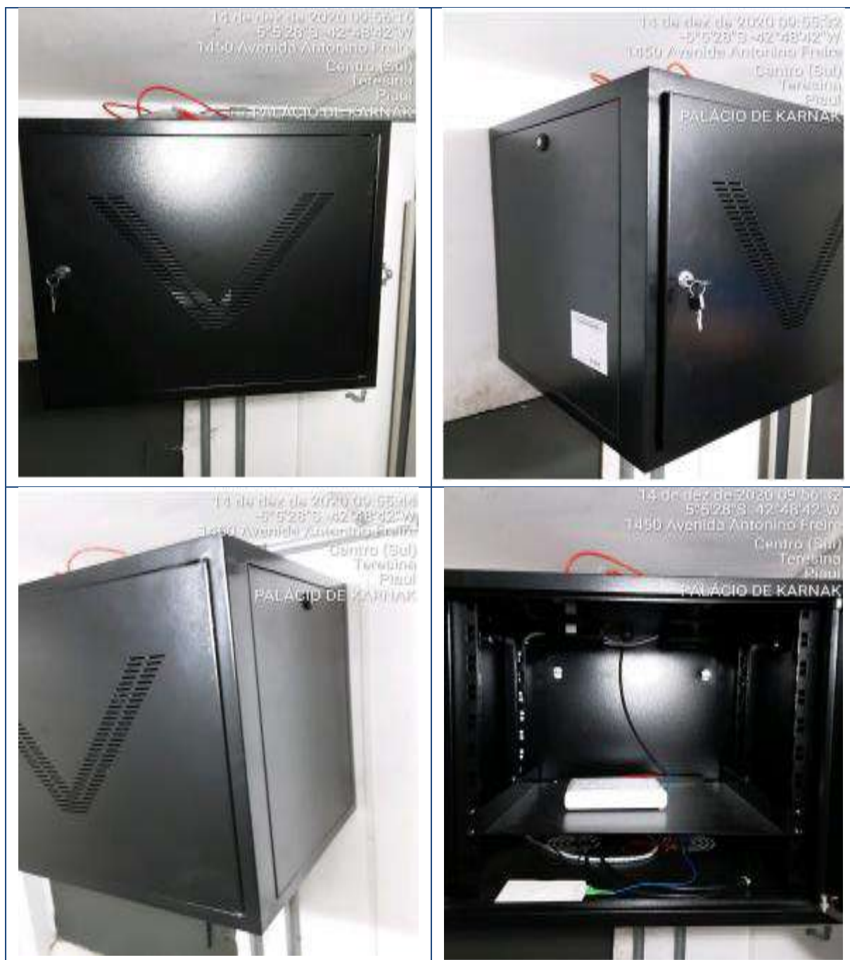
Figura 138 – PAG Palácio de Karnack: NÃO CONFORME – Ausência de adesivo com contato para suporte e identificação do rack - Teresina
