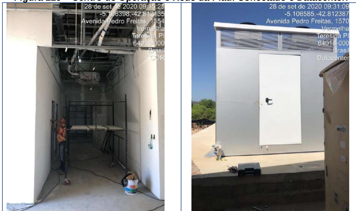
Figura 229 – Centro de Operação e Rede da Piauí Conectado e Datacenter.
