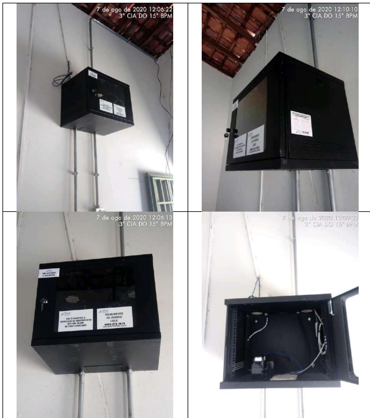
Figura 140 – PAG 3º CIA do 15º BPM: NÃO CONFORME - Ausência de adesivo com identificação do rack – Cabeceira do Piauí
