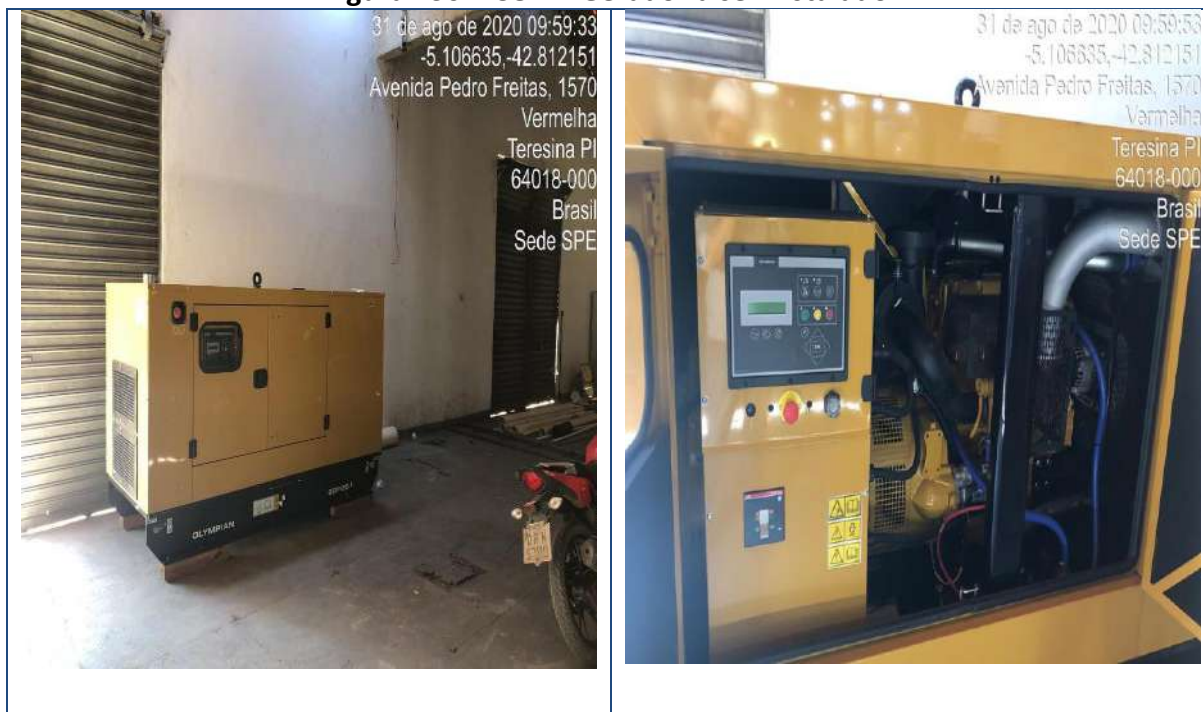
Figura 230 – COR – Gerador a ser instalado.
