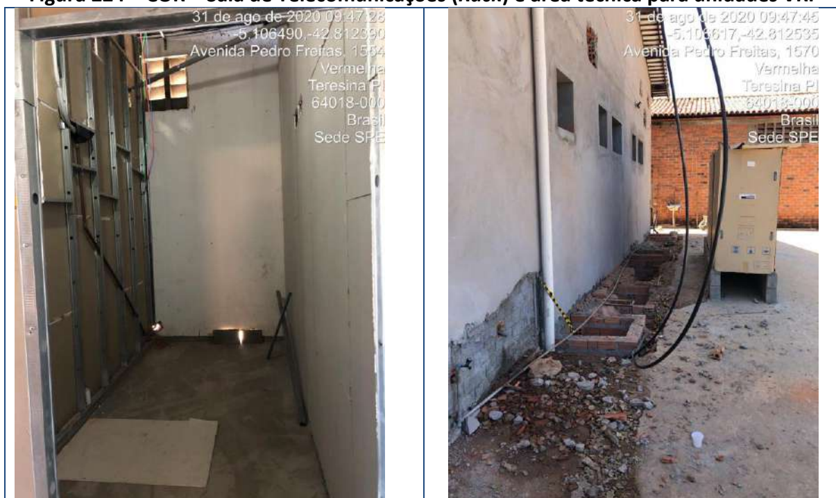
Figura 224 – COR – Sala de Telecomunicações (Rack) e área técnica para unidades VRF
