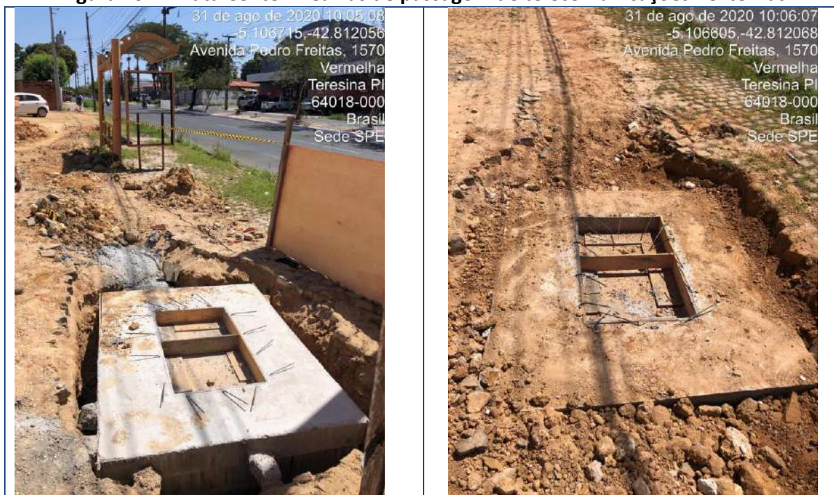
Figura 231 – Data Center – Caixas de passagem de telecomunicações - externas
