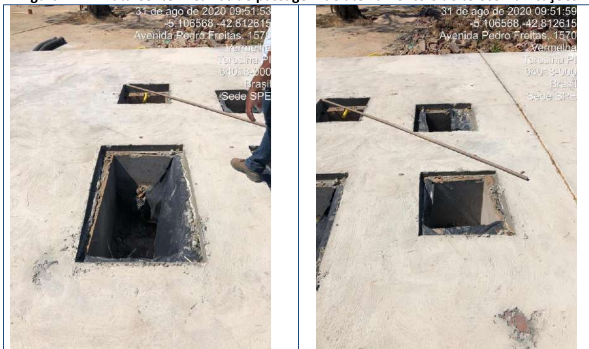
Figura 227 – Data Center - Caixas de passagem de aterramento e de telecomunicações
