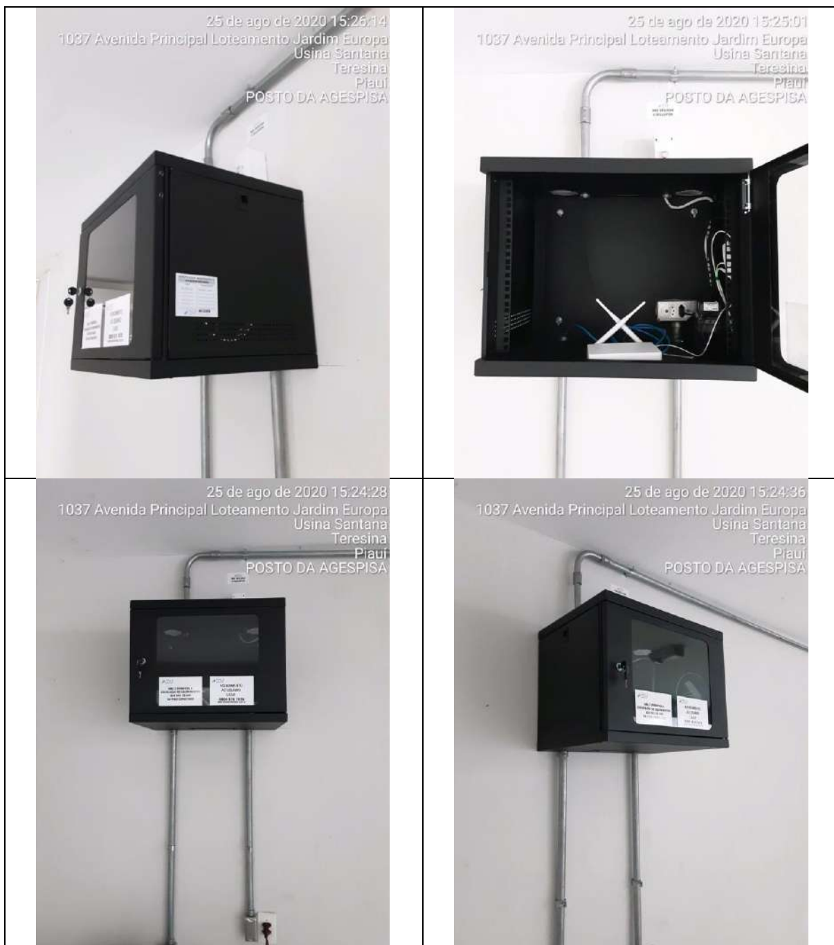
Figura 167 – PAG Posto da Agespisa: NÃO CONFORME – Ausência de adesivo com identificação do rack – Teresina
