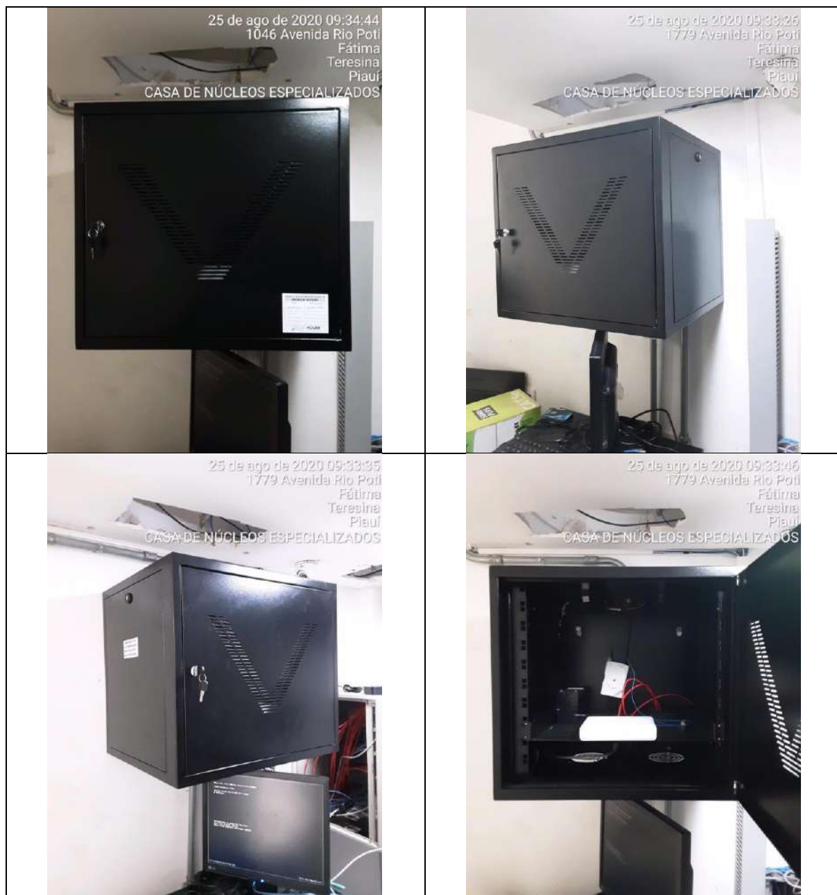
Figura 163 – PAG Casa de Núcleo Especializados: NÃO CONFORME – Ausência de adesivo com contato para suporte – Teresina
