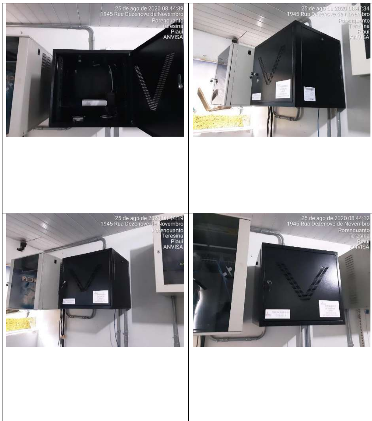
Figura 162 – PAG ANVISA: NÃO CONFORME – Ausência de adesivo com identificação do rack - Teresina
