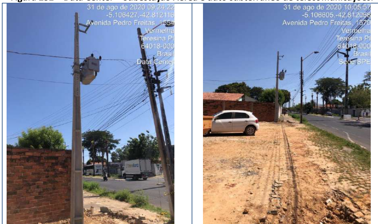
Figura 232 – Data Center – Subestação Aérea e duto subterrâneo de telecomunicações.
