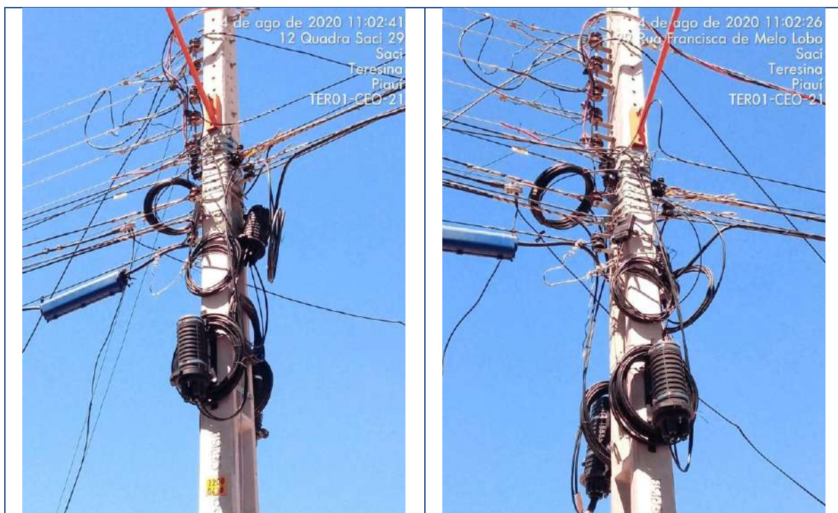
Figura 97 – TER01-CEO-21 – Ausência de identificação da placa do cabo lançado – Teresina
