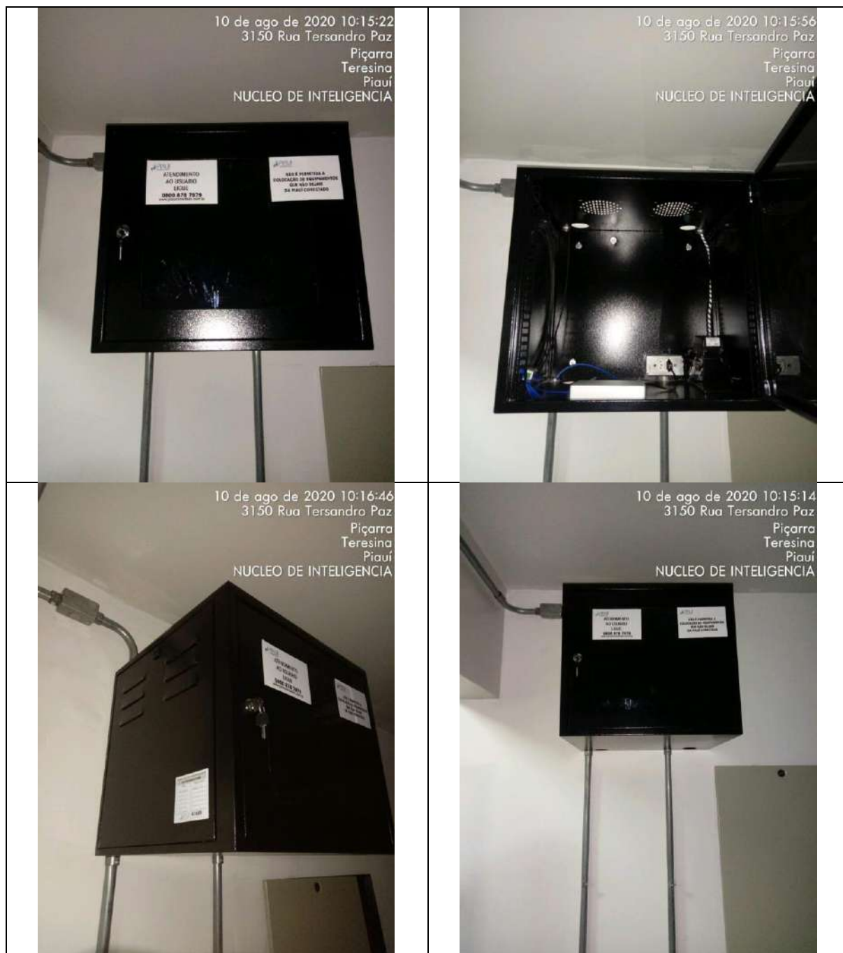
Figura 146 – PAG Núcleo de Inteligência: NÃO CONFORME – Ausência de adesivo com identificação do rack – Teresina
