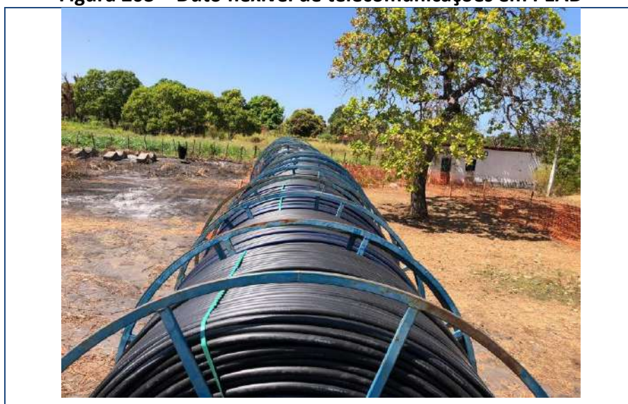
Figura 203 – Duto flexível de telecomunicações em PEAD
