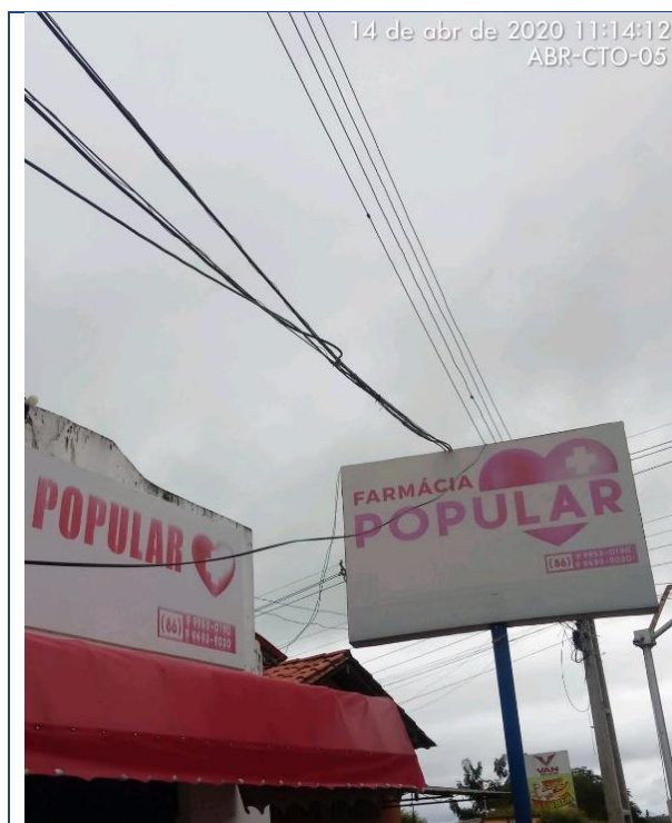
Figura 53 – ABR-CTO-05 – CTO com cabo abaixo da altura mínima de 5,20m – Água Branca
