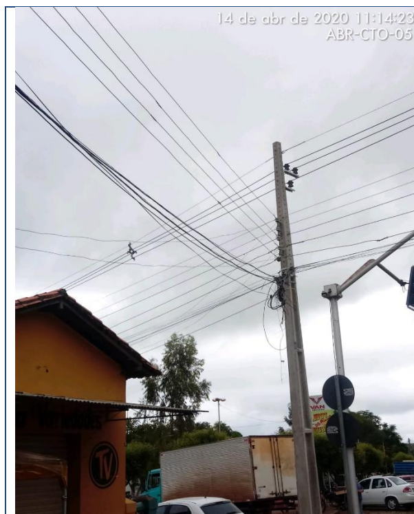
Figura 56 – ABR-CTO-05 – CTO com cabo abaixo da altura mínima de 5,20m – Água Branca
