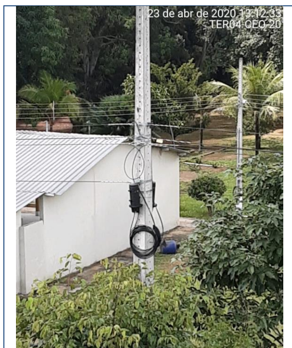
Figura 78 – TER04-CEO-20 - CEO sem plaqueta de identificação e sem cruzeta para reserva técnica - Teresina
