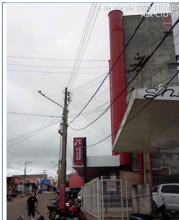
Figura 55 – ABR-CTO-05 – CTO com cabo abaixo da altura mínima de 5,20m – Água Branca
