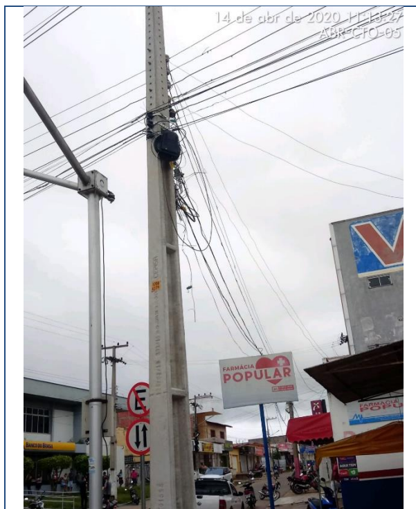
Figura 57 – ABR-CTO-05 – CTO com cabo abaixo da altura mínima de 5,20m – Água Branca
