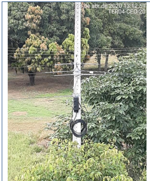
Figura 79 – TER04-CEO-20 - CEO sem plaqueta de identificação e sem cruzeta para reserva técnica - Teresina
