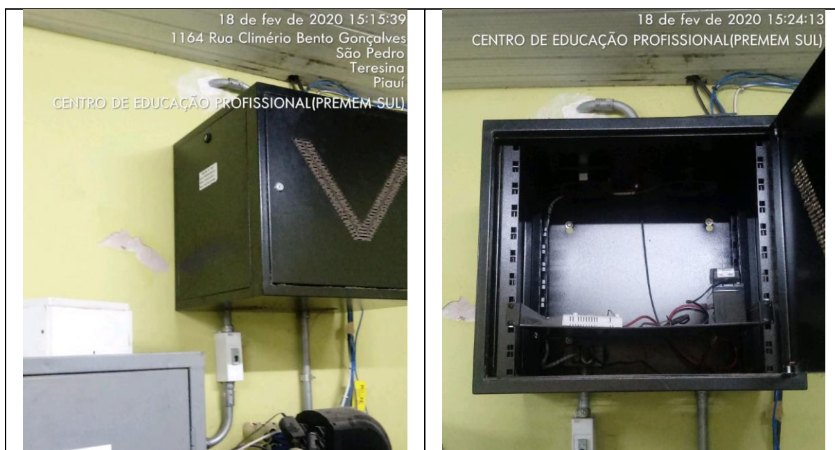
Figura 177 – PAG CENTRO DE EDUCAÇÃO PROFISIONAL (PREMEN SUL) – TERESINA - Não Conformidade: Ausência de adesivo com contato para suporte.
