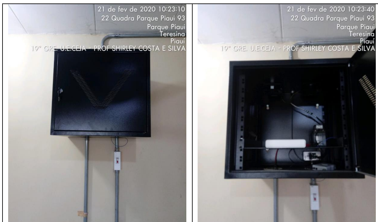
Figura 187 – PAG U.E. CEJA PROF. SHIRLEY COSTA E SILVA – TERESINA. Não conformidade: ausência de adesivo com contato para suporte.
