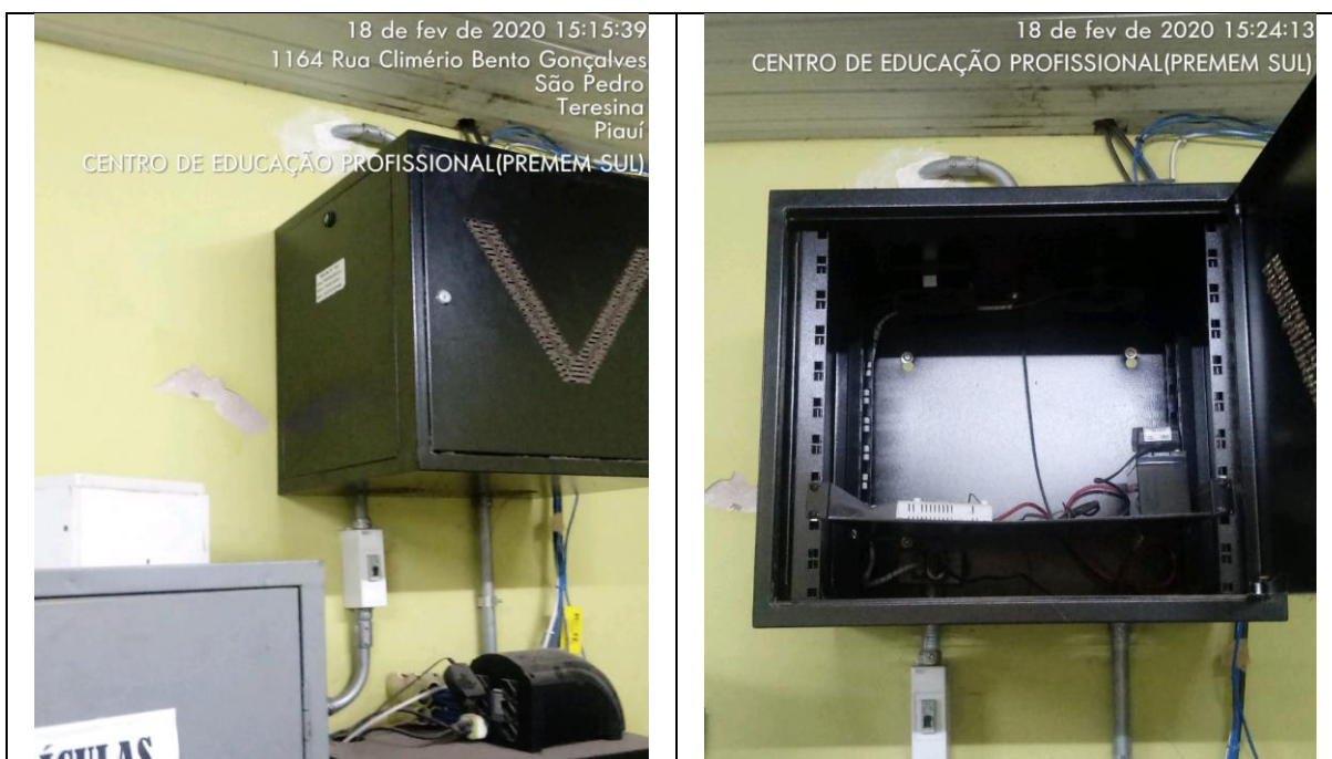
Figura 97 – PAG CENTRO DE EDUCAÇÃO PROFISSIONAL (PREMEN SUL) – TERESINA - Não Conformidade: Ausência de adesivo com contato para suporte.
