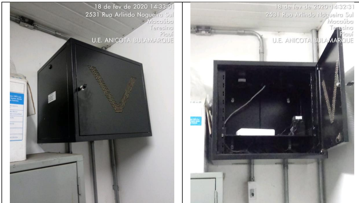
Figura 96 – PAG U.E. ANICOTA BULAMARQUE – TERESINA – Não Conformidade: Ausência de adesivo com contato para suporte.
