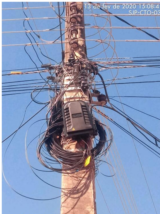
Figura 30 – SJP-CTO-03 – CTO com mais de dois cabos de fibra óptica – reserva técnica sem cruzeta.
