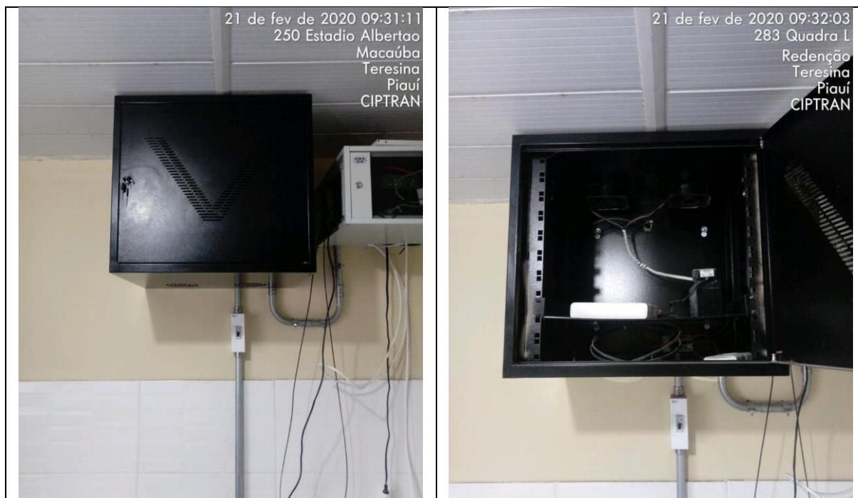
Figura 106 – PAG CIPTRAN – TERESINA. Não Conformidade: Ausência de adesivo com contato para suporte.
