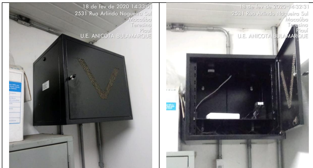
Figura 176 – PAG U.E. ANICOTA BULAMARQUE – TERESINA – Não Conformidade: Ausência de adesivo com contato para suporte.
