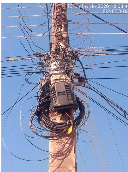
Figura 53 – SJP-CTO-03 – CTO com mais de dois cabos de fibra óptica – reserva técnica sem cruzeta.
